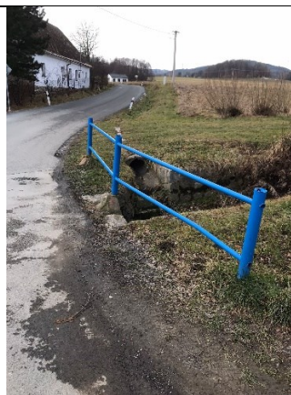
Řešení závady Z1-doplnění římsy a zábradlí
