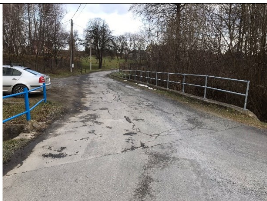
Začátek úseku A1, vlevo řešení závady Z1 – římsa mostku+zábradlí
