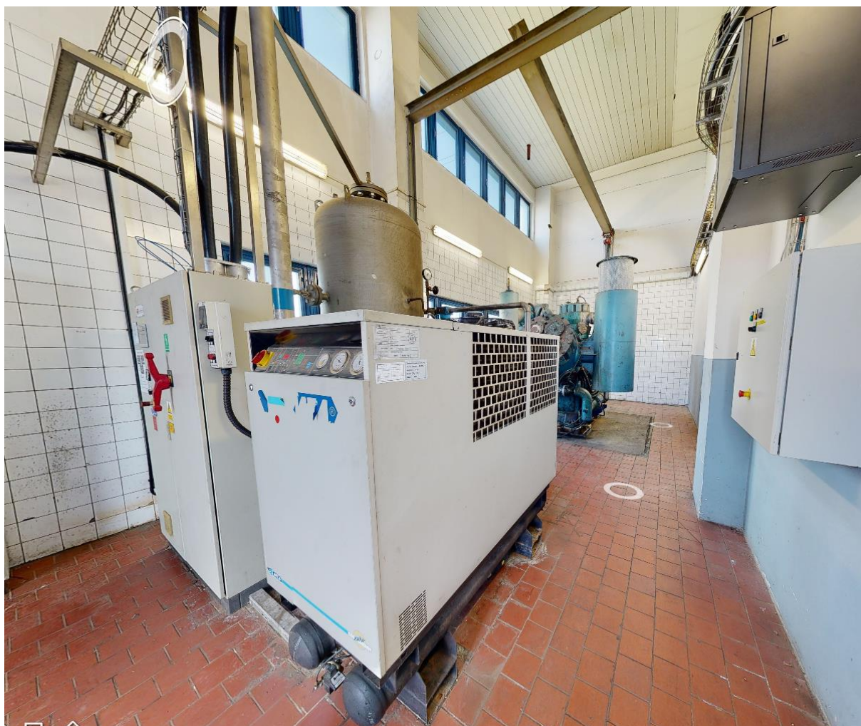
Obrázek 3 - Kompresorovna 1 - pohled od vchodu
