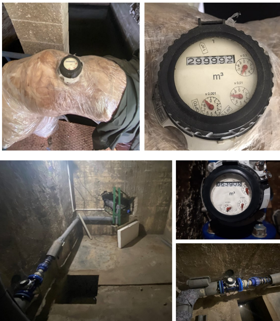
Obrázek 10. Fotografie vodoměru pro odečet množství povrchové vody jímání z Kozího potoka v budově jímání a vodoměr povrchové vody natékající z vodojemu do závodu na odběrném místě 4092-0070, typ DN10, je fakturačním měřidlem (pro fakturaci stočného) spol. CHEVAK Cheb a.s., je evidován pod číslem 110118504
