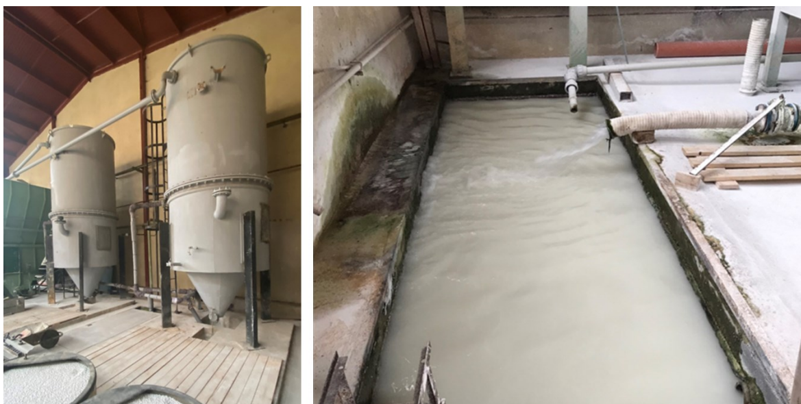
Obrázek 15. Fotografie čířičů využívaných k dodatečné sedimentaci odpadní technologické vody v budově bývalé ČOV a odtok části odsedimentované vody do veřejné kanalizace
