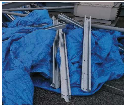
Zajištění materiálu na střeše proti působení větru
