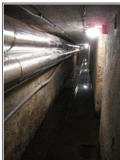
Rozvody tepla v topném kanále
