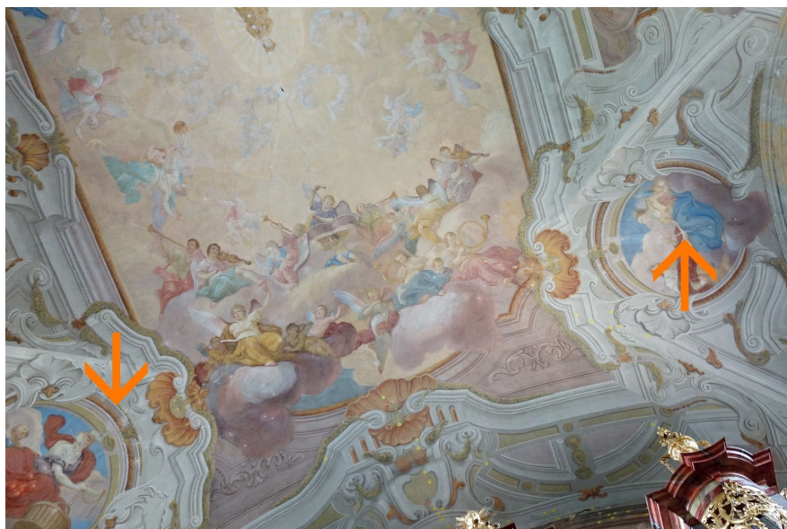
Viditelný směr příčné trhliny u vstupního štítu
