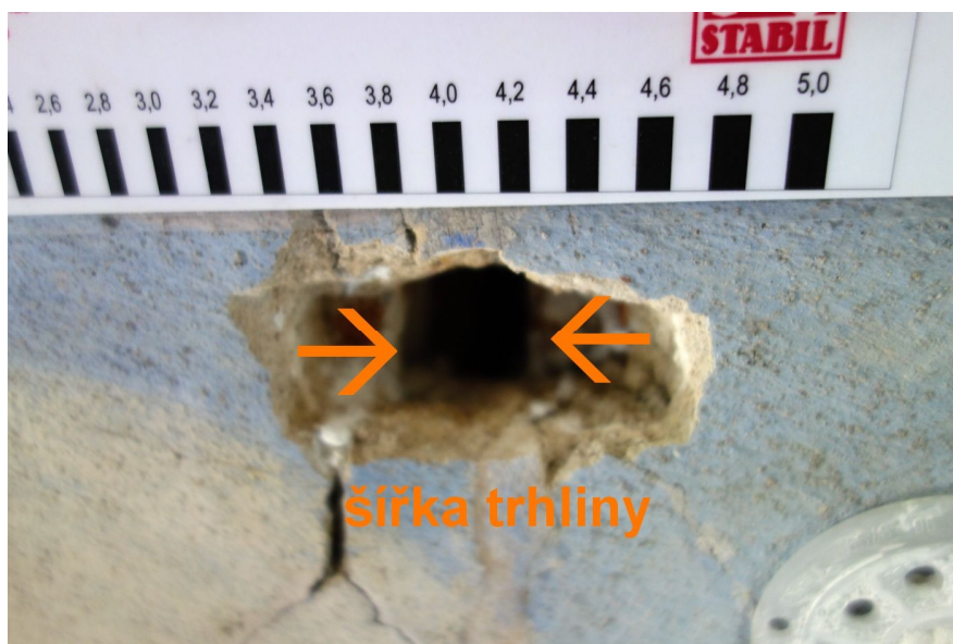
Šířka trhliny ve vrcholu klenby v sondě z lešení
