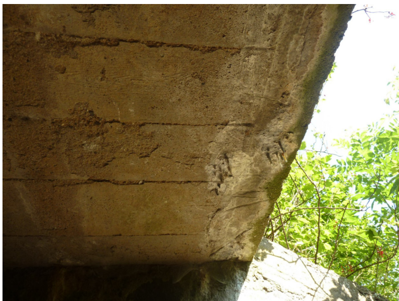
Detail pohledu nosné konstrukce na výtoku, zatékání formou vápenných inkrustací s krápníky
