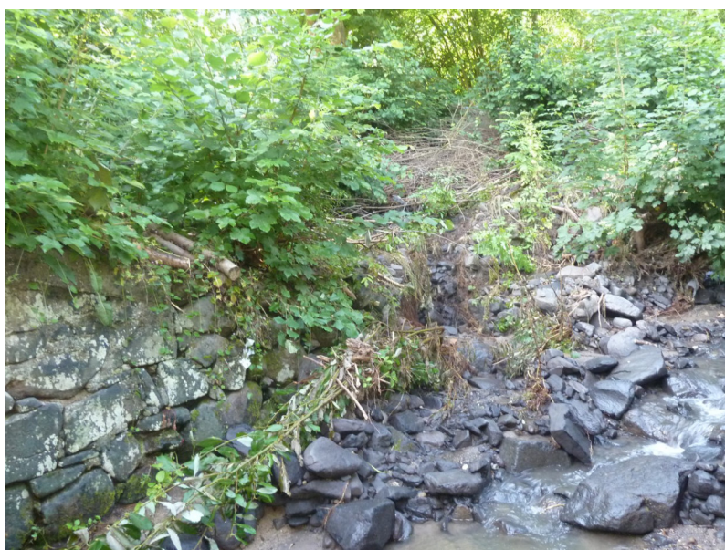
Křídlo vpravo na vtoku, vymletý svah za křídlem
