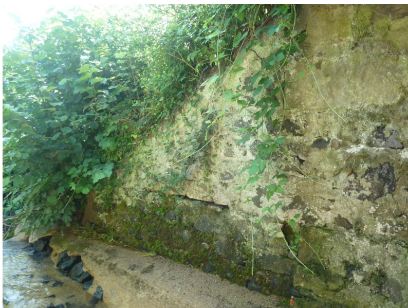
Křídlo vpravo na výtoku, trhliny v křídle, podemletá předbetonávka
