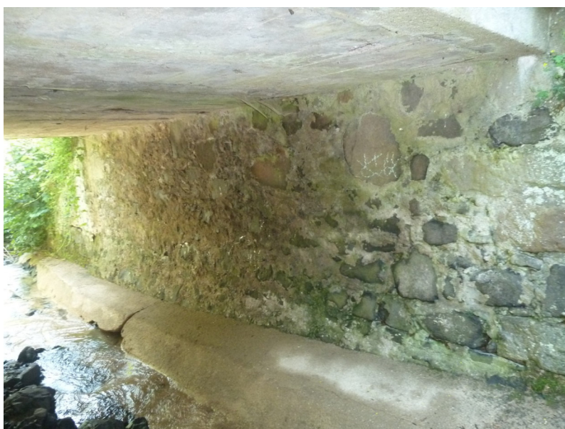
Pravá opěra, poškozená předbetonávka opěr
