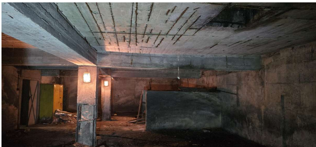
Obnažená a zkorodovaná nosná výztuž spodního líce desky
