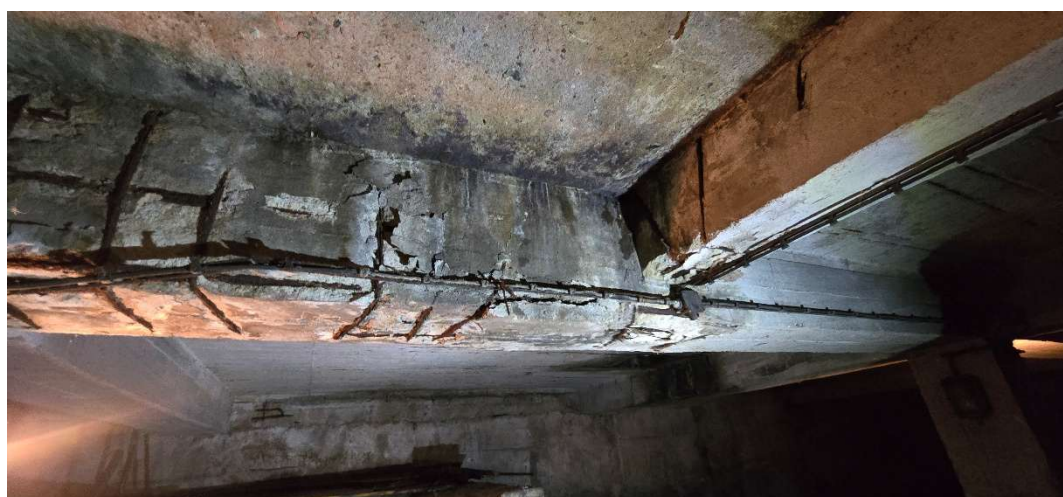
Průvlaky se zcela obnaženou a zdegradovanou nosnou výztuží
