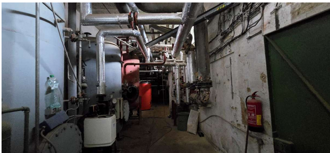
Prostory výměníku – bývalé kotelny – pod obytným domem
