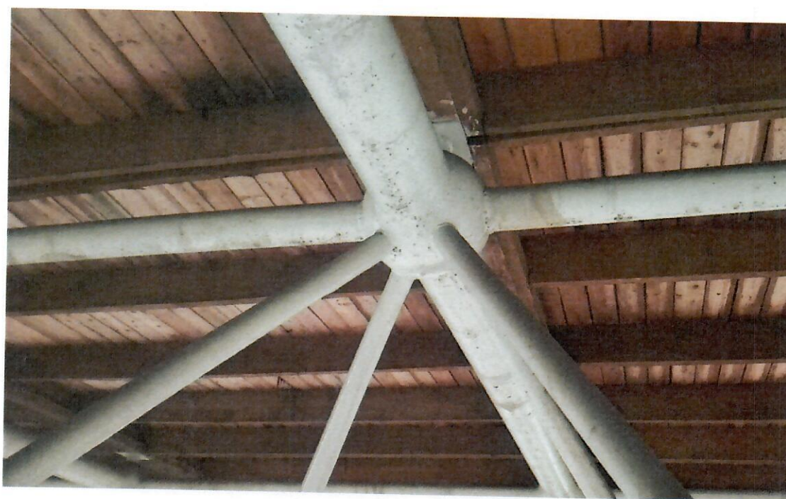
Obr. č. 4: Styčník nad ledovou plochou v r. 2019. Patrné je obnovení nátěrů (foto z prohlídky 14. 8. 2019).
