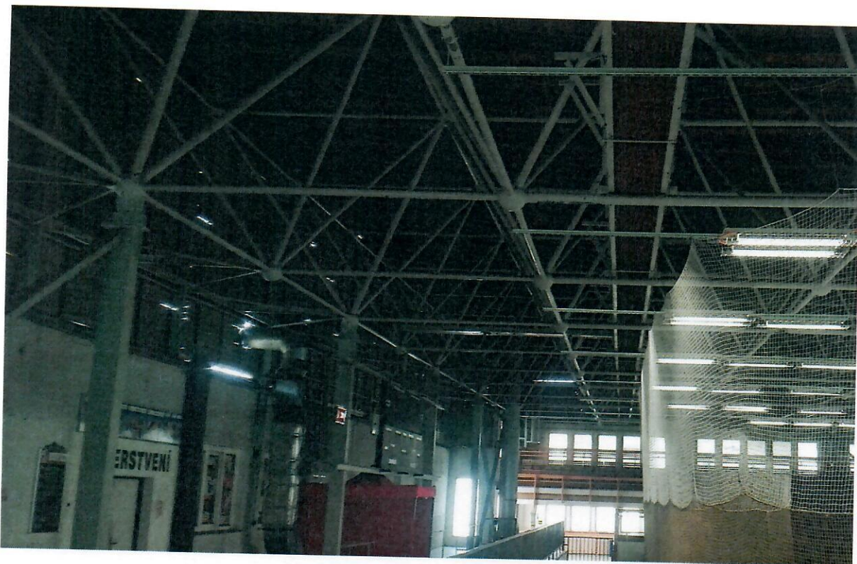
Obr. č. 5: Lokální odlupování nátěru v korozně méně exponovaném jihovýchodním rohu konstrukce, které je možno opravit v rámci budoucích oprav nátěrů (foto z prohlídky 14. 8. 2019).
