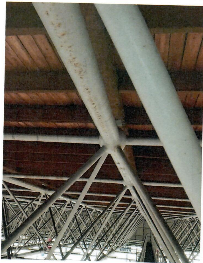
Obr. č. 6: Drobné korozní poškození na spod. líci horního rastru trubek, které zatím nevyžaduje zásah (foto z prohlídky 14. 8. 2019).
