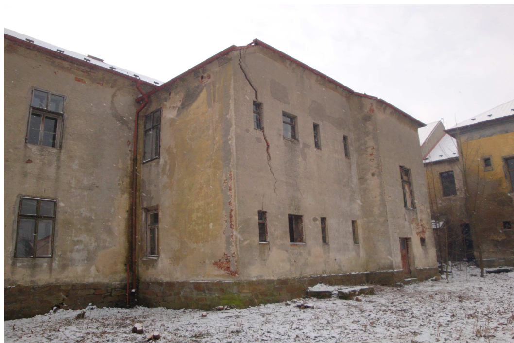
STATICKÁ PORUCHA OBVODOVÉHO ZDIVA V PROSTORU SOCIÁLNÍHO ZAZEMÍ
