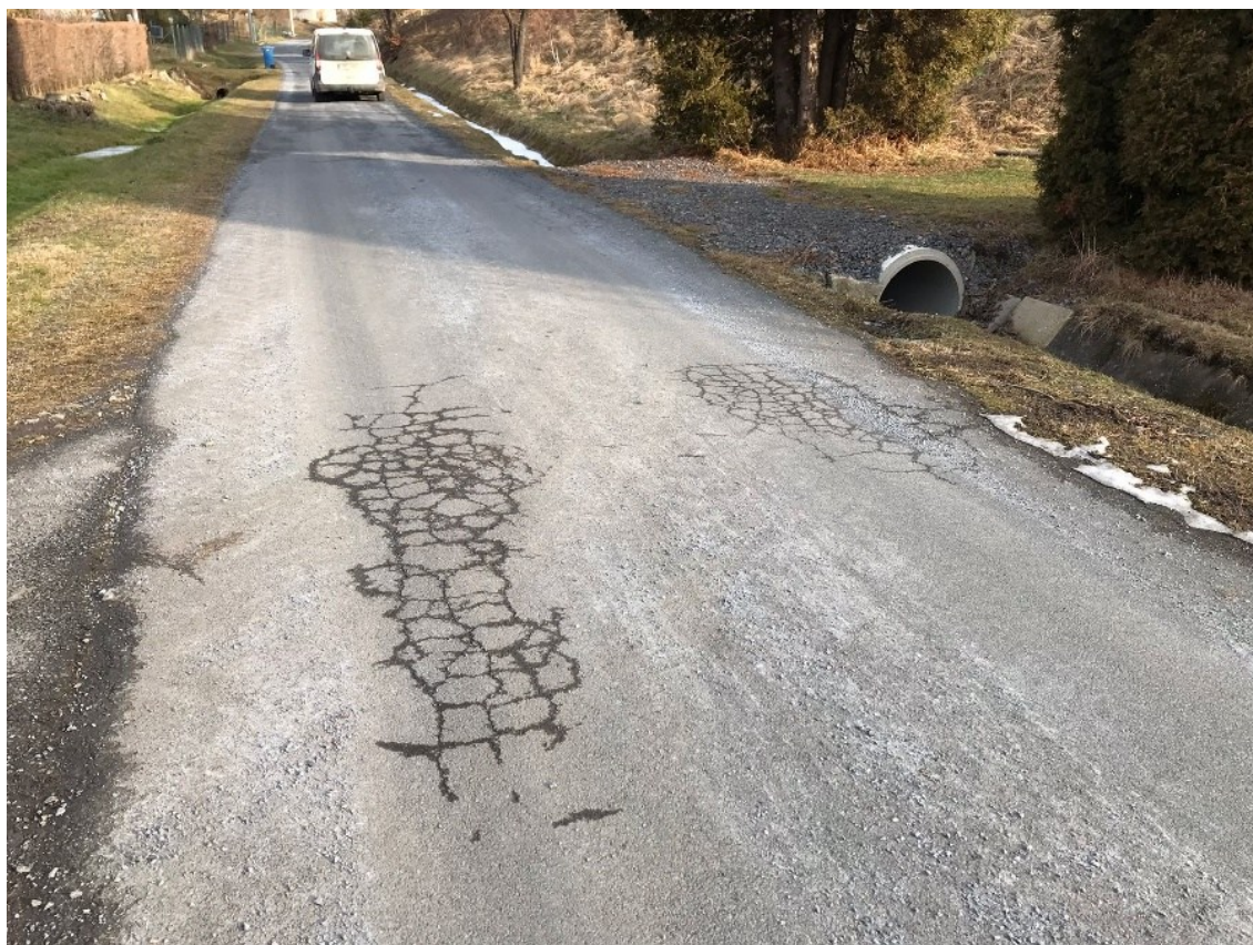
Poruchy ve vozovce
