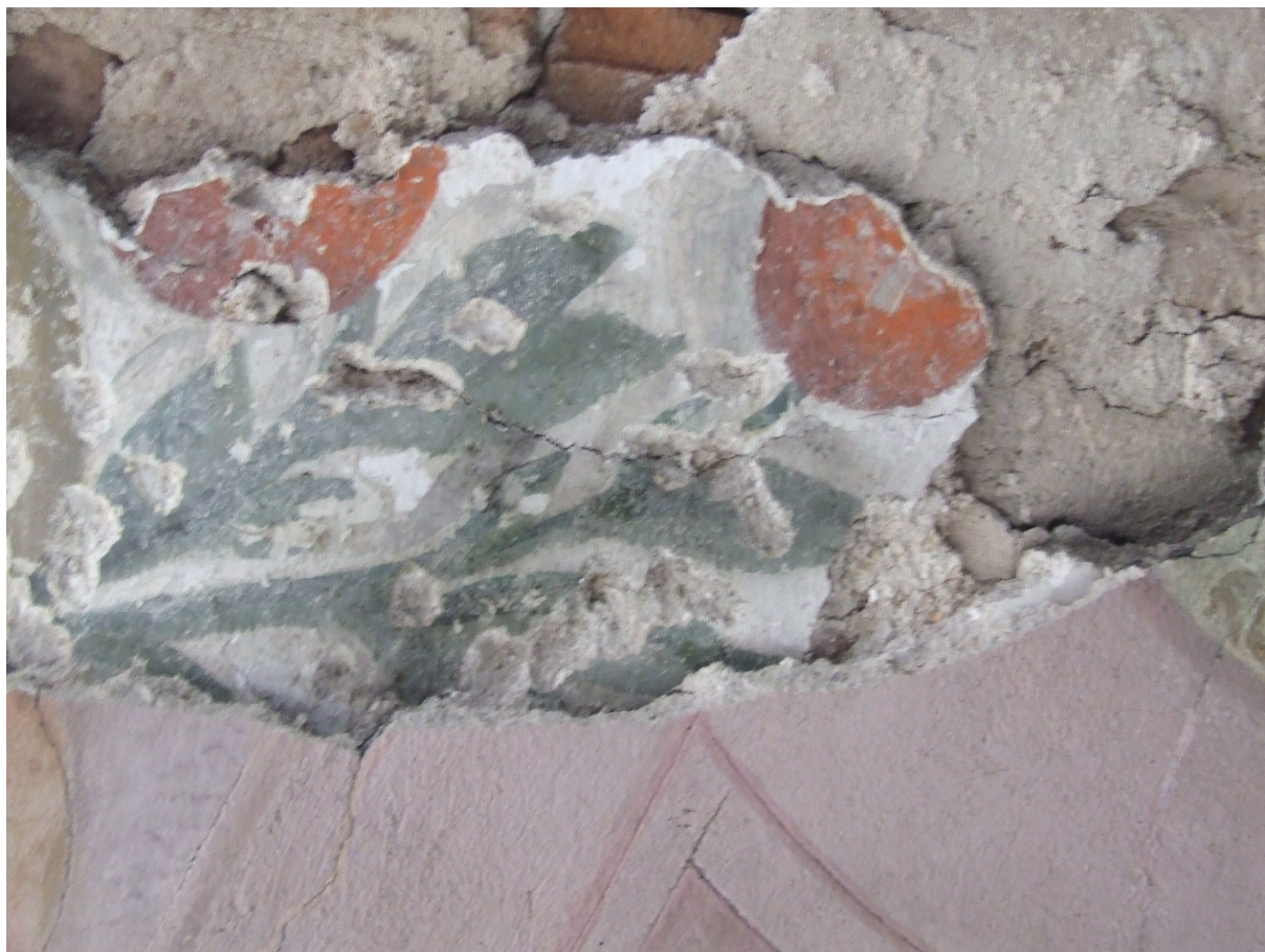
Obrázek 2 – fragment původní ornamentální malířské výzdoby klenby presbytáře v technice vápenné tempéry. Hladký povrch musel být pro další nahození omítky opekován. Soudržnost spodních vrstev je lokálně havarijní.
