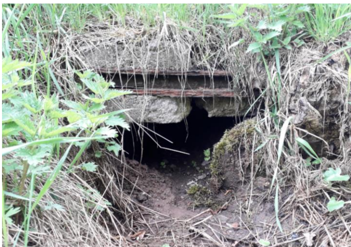
Provedení a technický stav stávajících propustků pod hlavní silnicí III/01412
