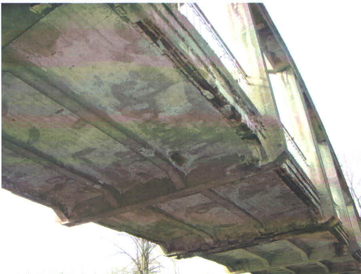
Detail podhledu NK zprava od 1.opěry – degradace betonu podhledu krajního trámu s výraznou korozi průřezu nosné výztuže
