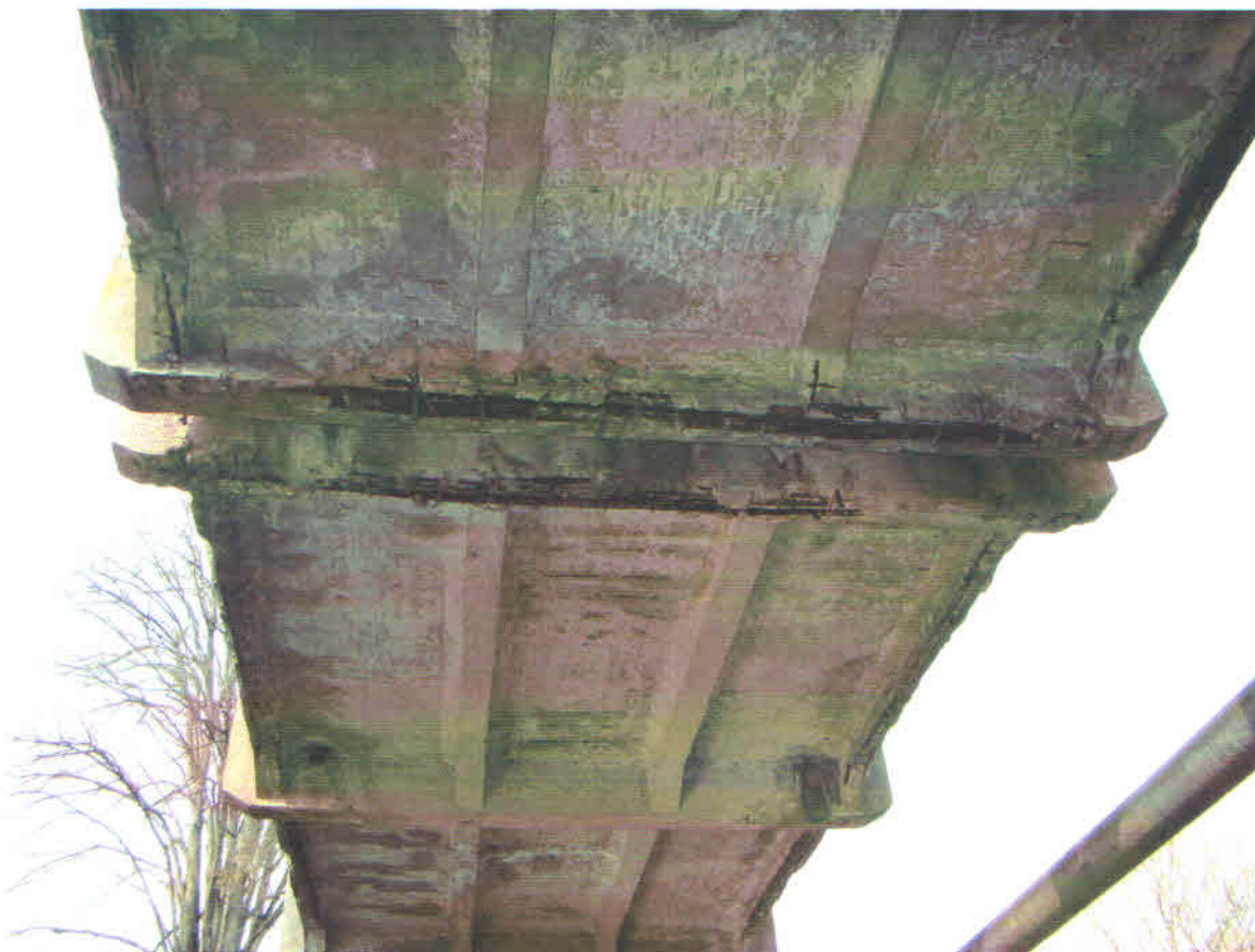
Detail středových příčných trámů v \frac{1}{2} rozpětí NK - degradace betonu trámů s výraznou korozi nosné výztuže
