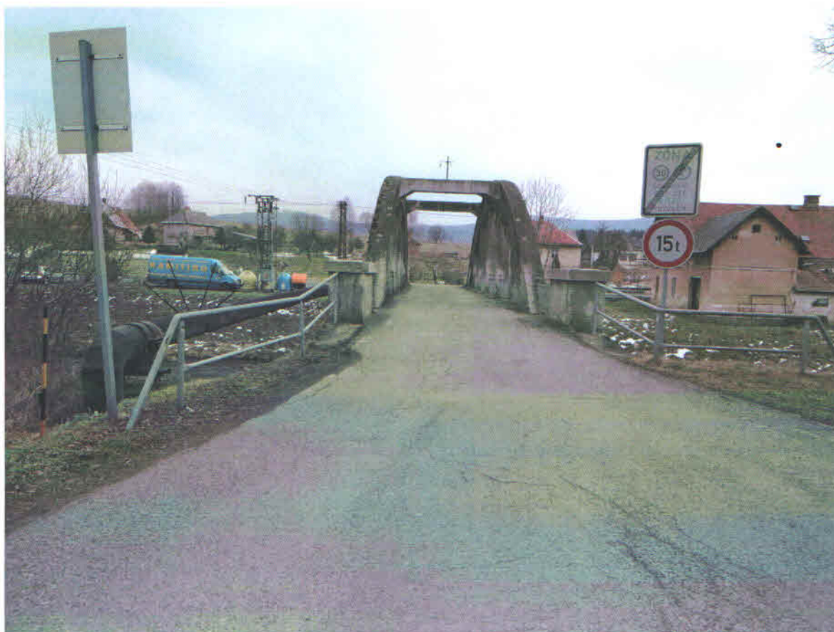
Pohled na most proti směru staničení – chybí dodatková tabulka s údajem o zatížitelnosti mostu Vr
