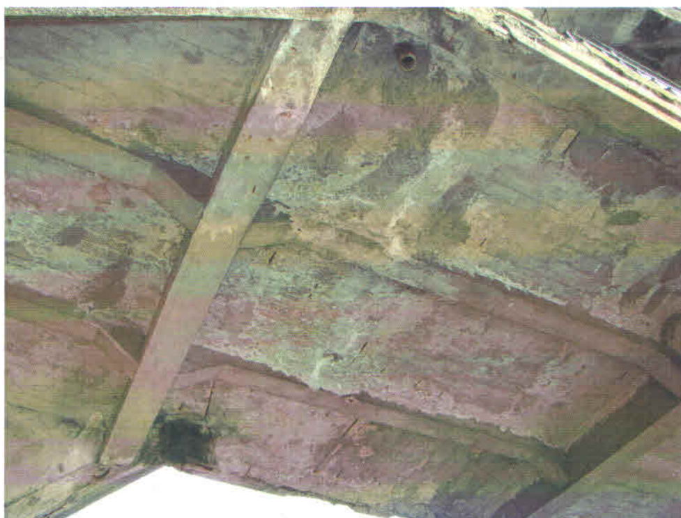
Podhled NK u 2. opěry – průsaky s výluhy, koroze svodu odvodnění; obnažena korodující výztuž mostovky
