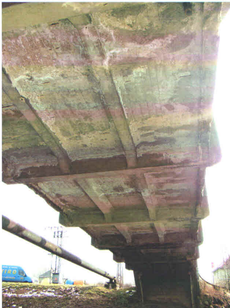
Podhled nosné konstrukce od 2. opěry – silné průsaky s výluhy na podhledu NK
