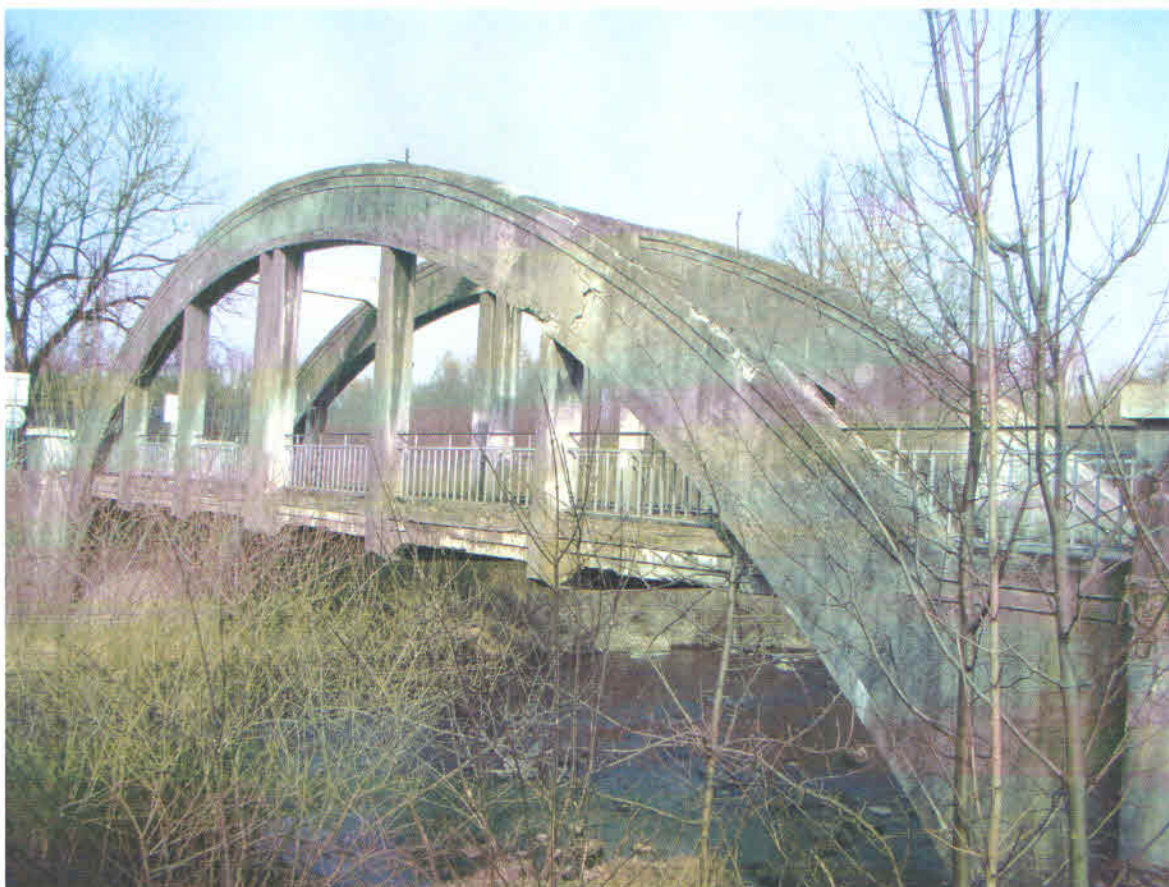
Detail NK zleva – degradace betonu čela mostovky a říms, místní degradace betonu levého oblouku
