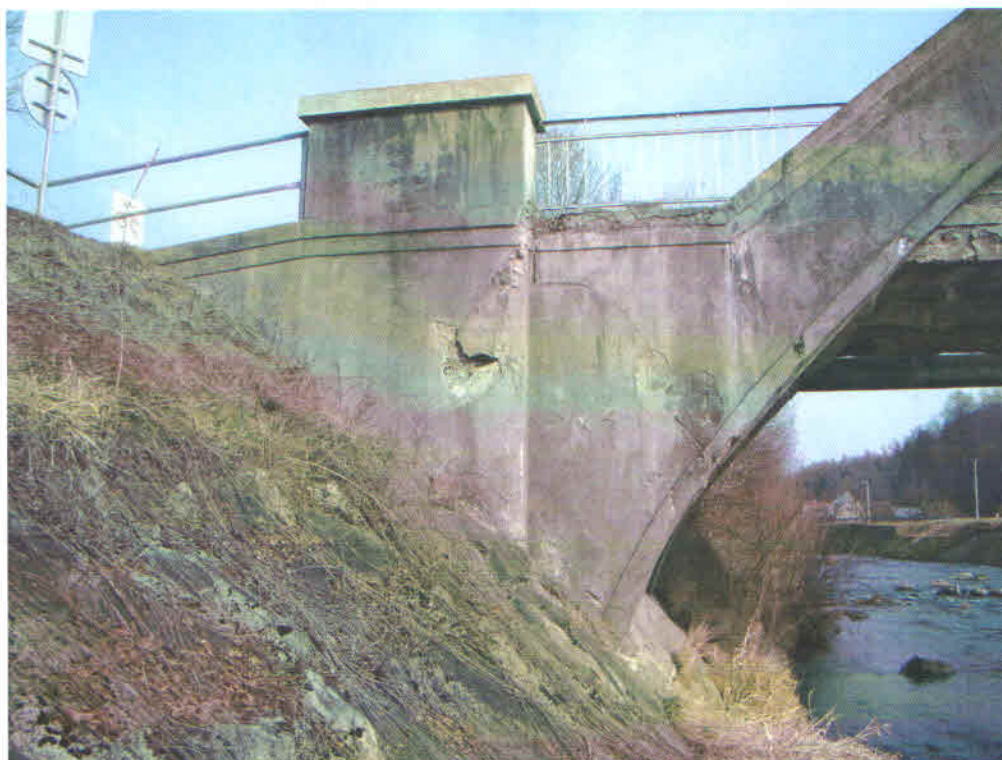
Pohled na levé křídlo 2.opěry – degradace betonu líce křídla a římsy
