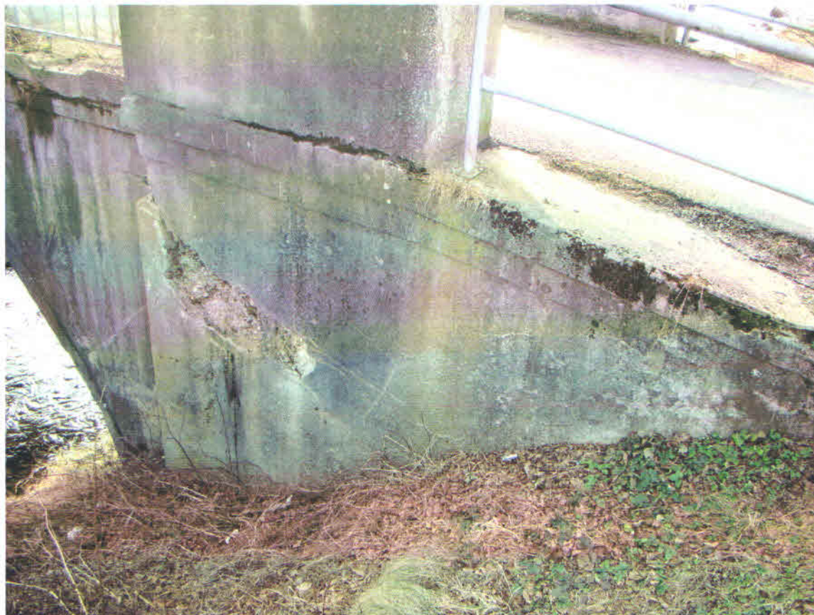
Pohled na pravé křídlo 2.opěry – hloubková degradace betonu líce křídla; průsaky s výluhy
