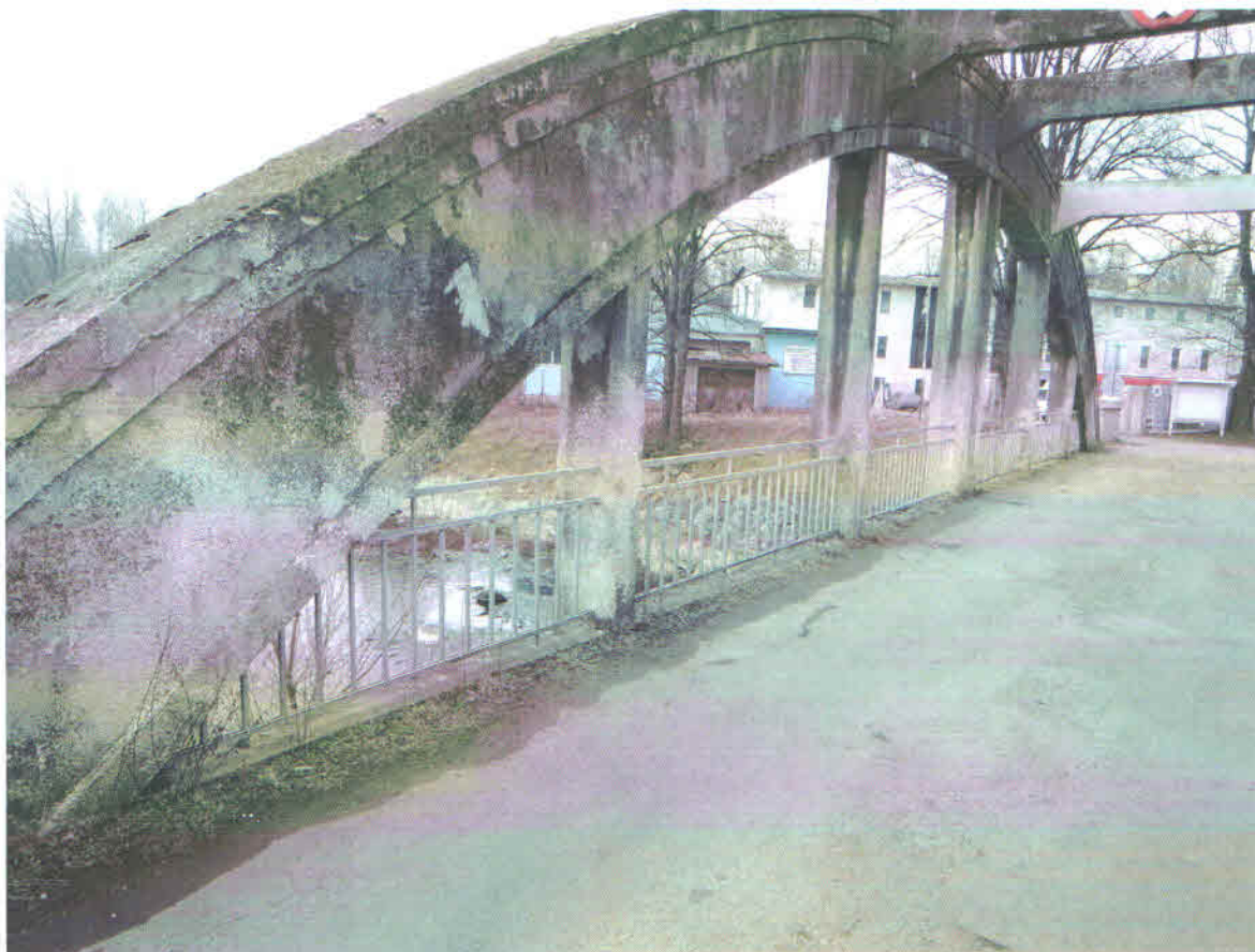
Pohled na levou římsu s nosnou konstrukcí - vegetace a degradace betonu říms vlivem převrstvení vozovky a nefunkčního odvodnění vozovky mostu
