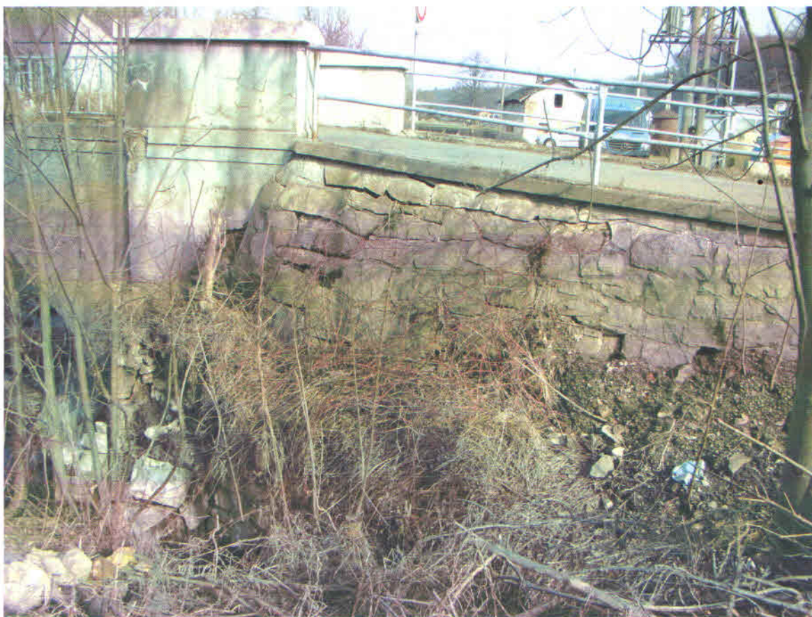
Pohled na levé křídlo 1.opěry – místně zřícení zdivo křídla a celkově rozvolněné zdivo
