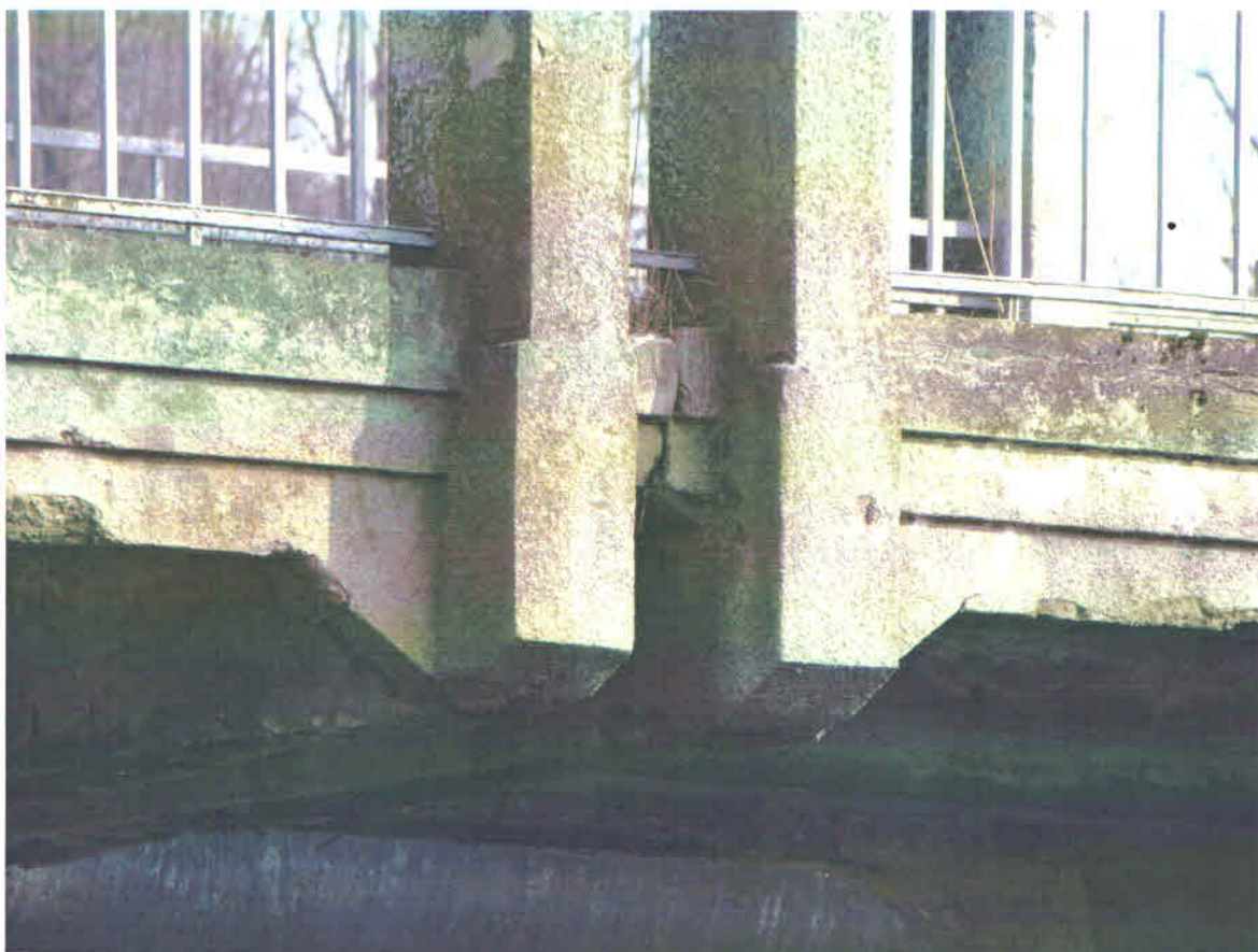
Detail čela NK zleva v místě dilatace mostovky v \frac{1}{2} rozpětí – silné průsaky mostním závěrem s následky na přilehlé trávy
