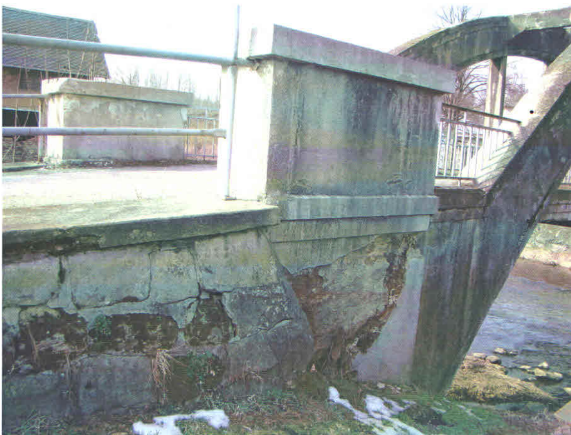
Detail pravého křídla 1.opěry – degradace betonu líce křídla a římsy
