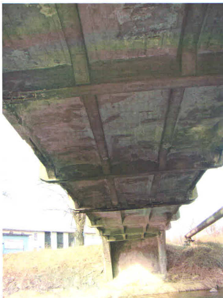
Podhled nosné konstrukce od 1. opěry – degradace betonu podhledů trámů s obnaženou nosnou výztuží zejména na krajních podélných trámech a příčných trámech v 1/2 rozpětí mostu
