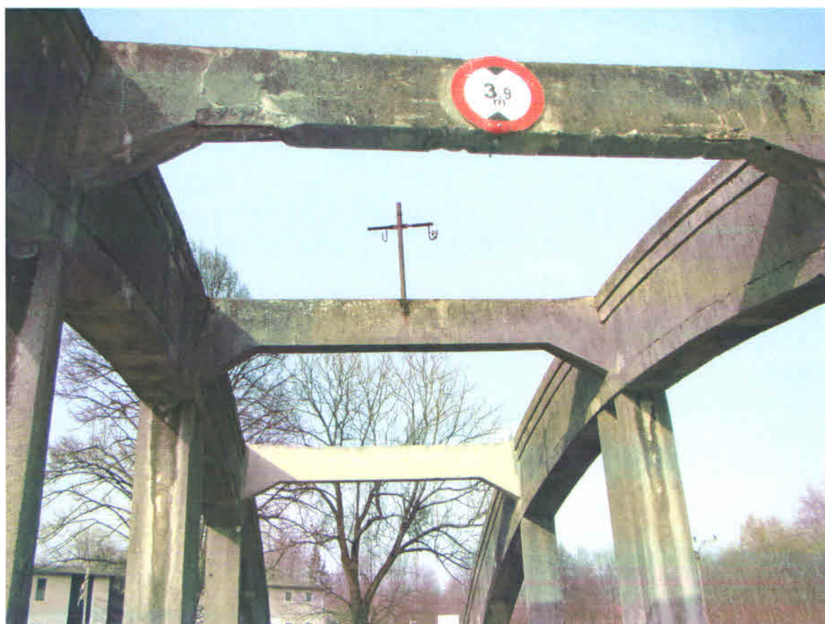
Pohled na vrcholové příčnický – ztužující příčník při 1. OP po náraze s trhlinami, odlomenými hranami a obnaženou a korodující výztuží
