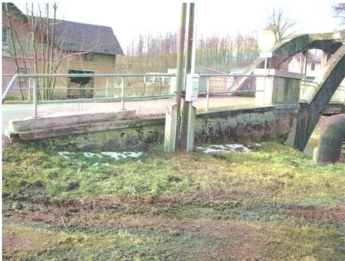
Pohled na pravé křídlo 1.opěry – nehomogenní římsa, rozvolněné zdivo s uvolněným spárováním
