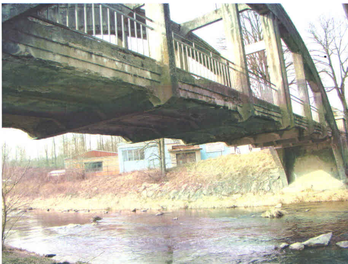
Podhled nosné konstrukce zprava – degradace betonu podhledu krajního trámu s výraznou korozi nosné výztuže
