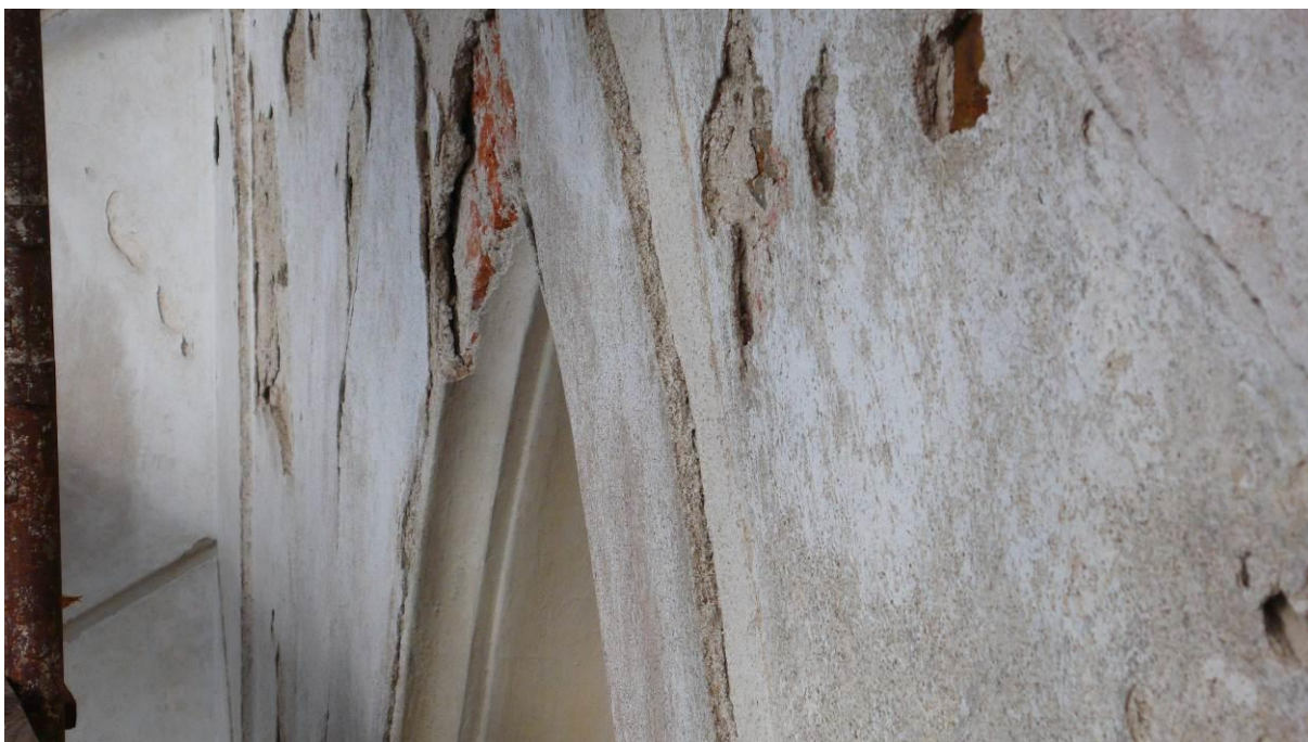
Jihozápadní strana 2 Vrstvy omítek z různých období oprav
