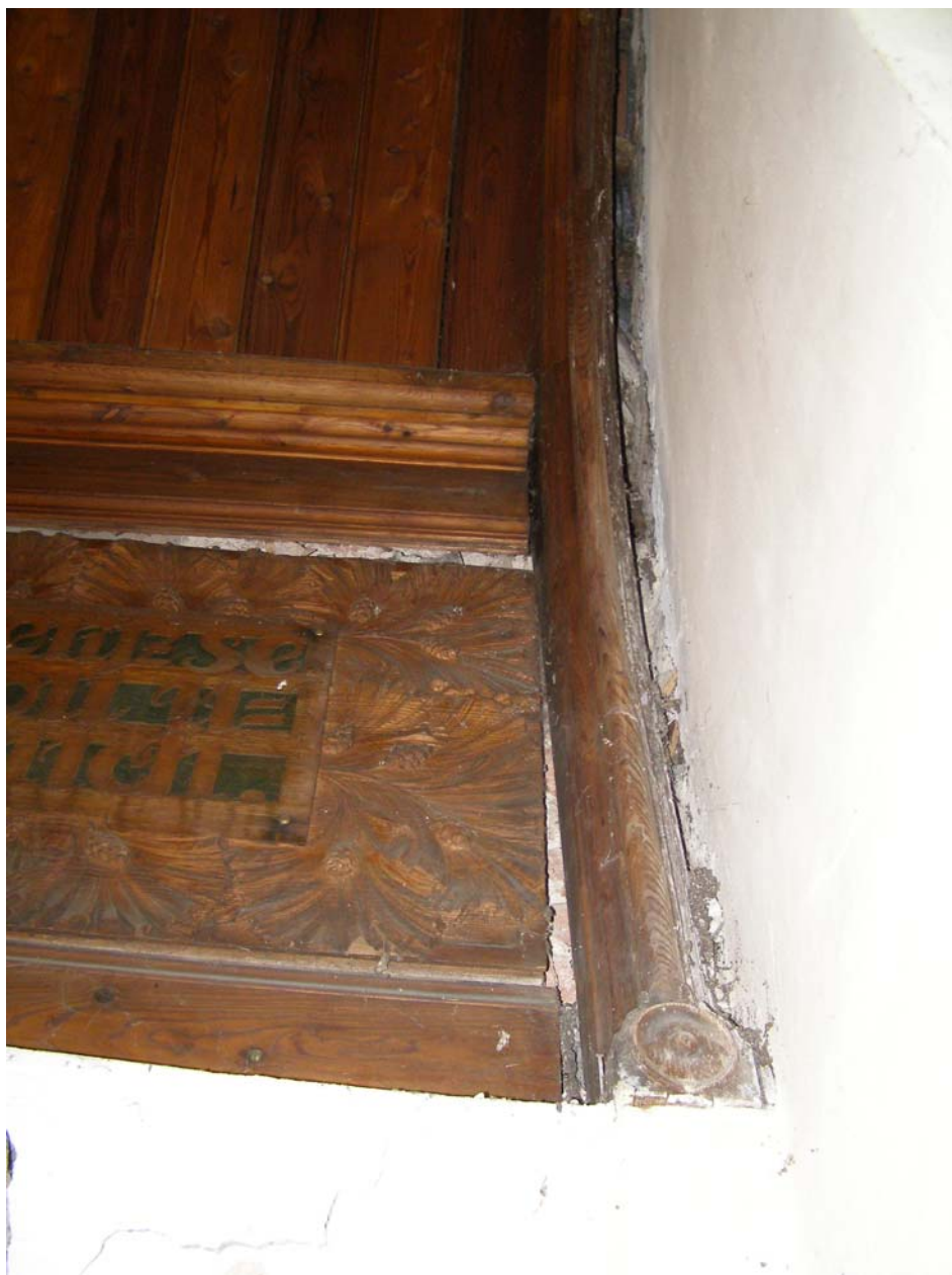
11. Obřadní síň - mezera mezi dřevěným žebrem a západní obvodovou zdí
