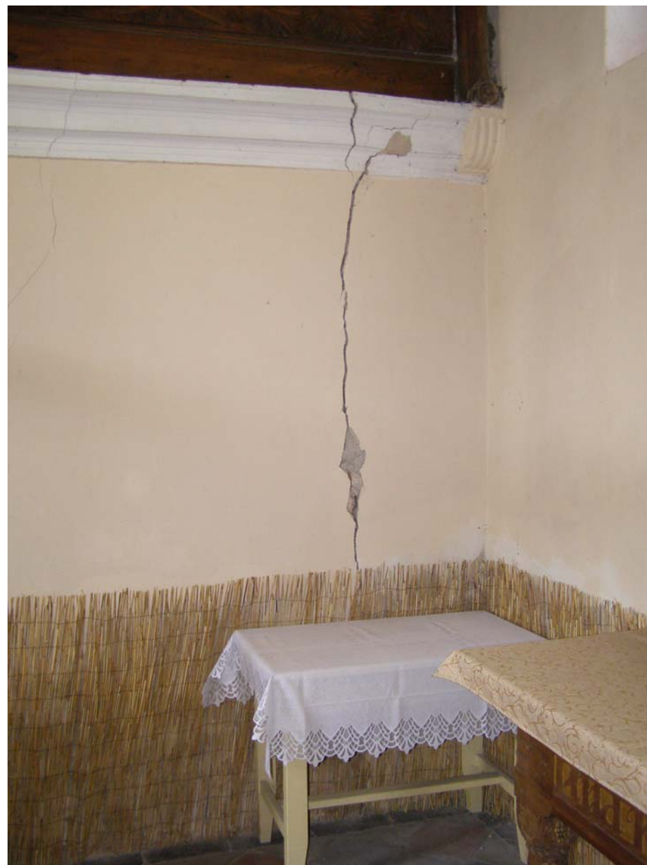
12. Obřadní síň - trhlina ve střední nosné zdi
