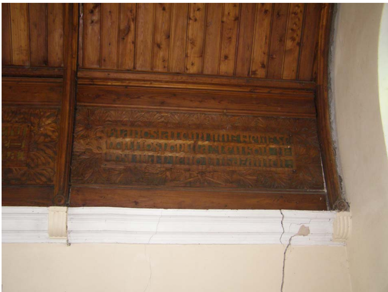
6. Poškozený vlys dřevěného klenutého pohledu
