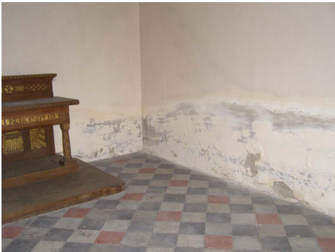
4. Obřadní síň- zvýšená vlhkost na vnitřním líci obvodové zdi
