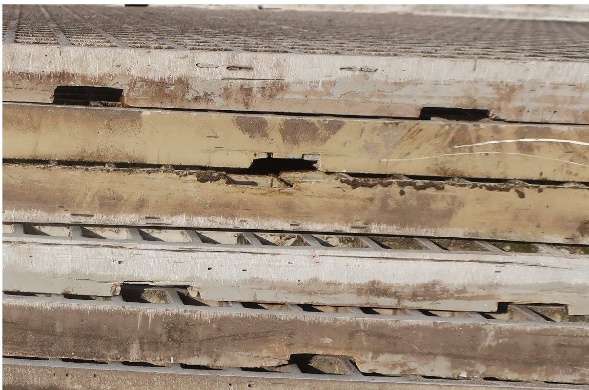
Obrázek 1 – detail oslabení pororoštů nad podélníky
