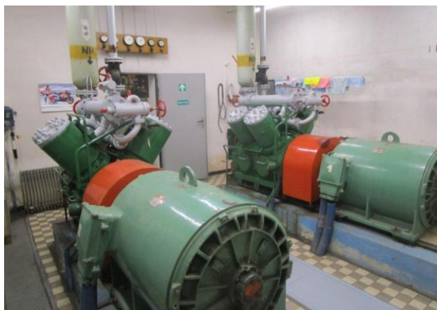
Foto č. 5, 6 strojovna chlazení, zásobník čpavku
