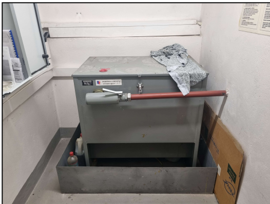
Obr.3 Agregát 90/E hydraulického výtahu
