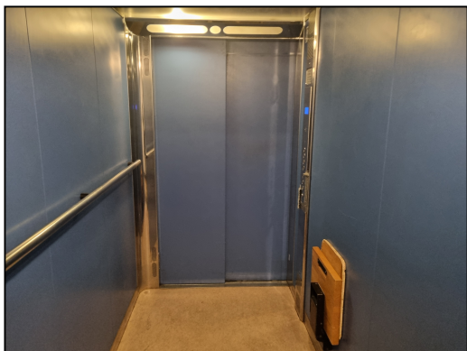
Obr.1 Kabina hydraulického výtahu
