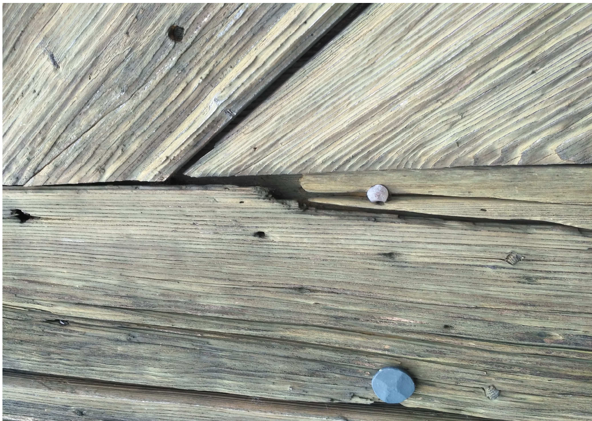
Detail degradace povrchu jihozápadních vrat
