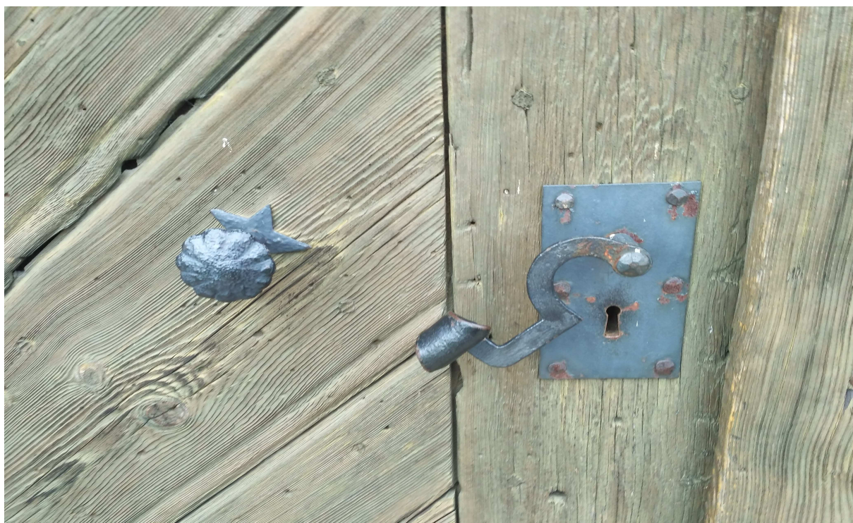
Korozní produkty kování severovýchodních vrat
