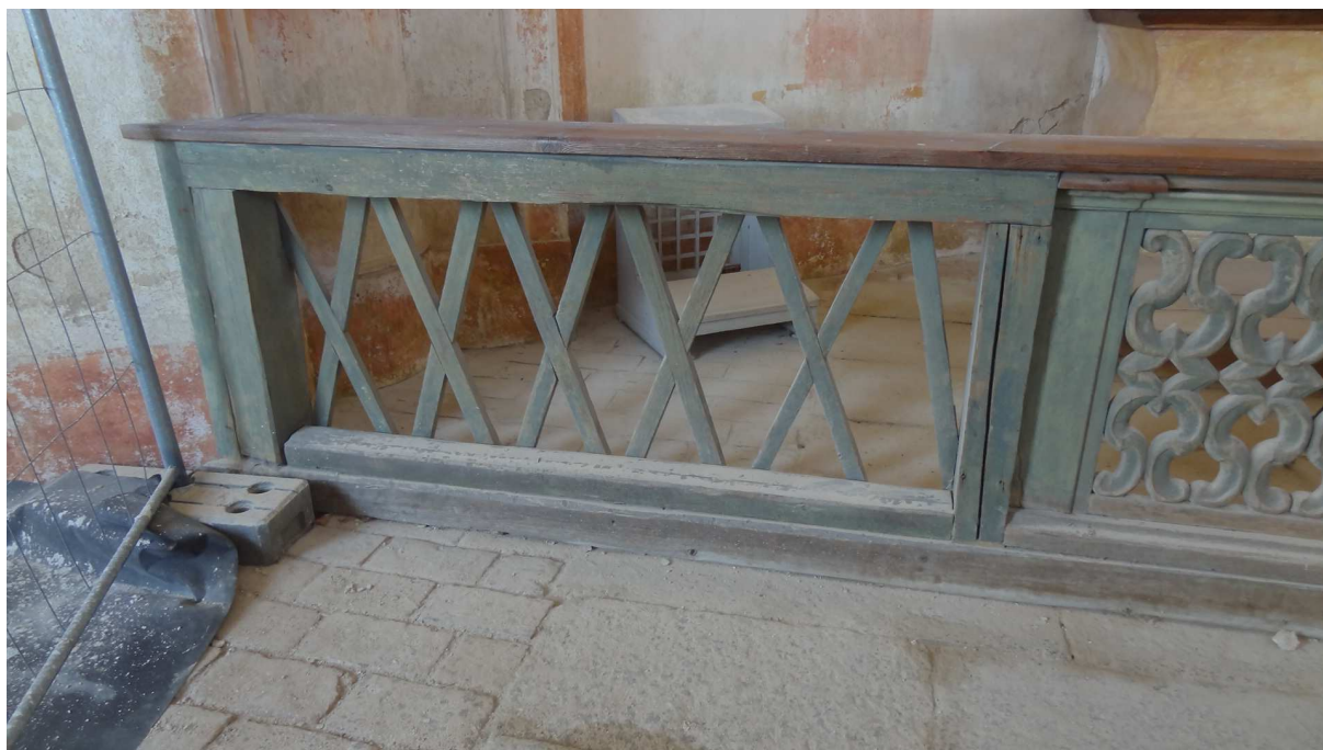
Nepůvodní výplně krajních částí mřížky
