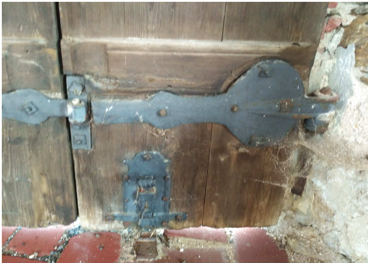
Korozní produkty závěsů severovýchodních vrat
