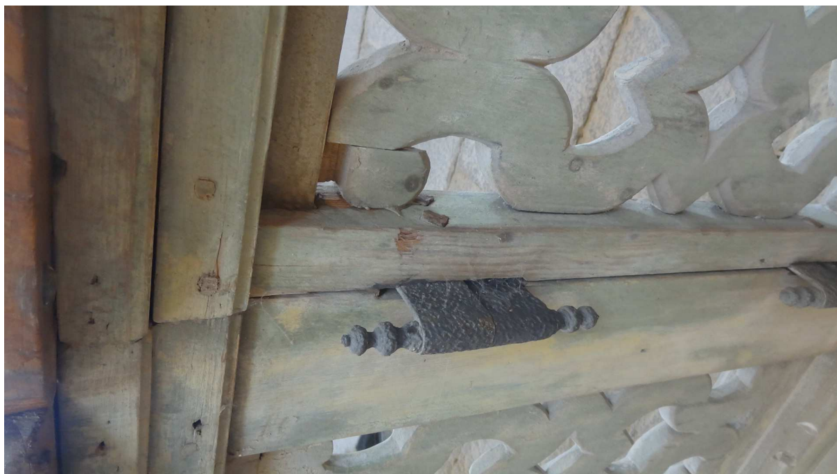
Detail původního závěsu mřížky s patrnou hloubkovou korozí
