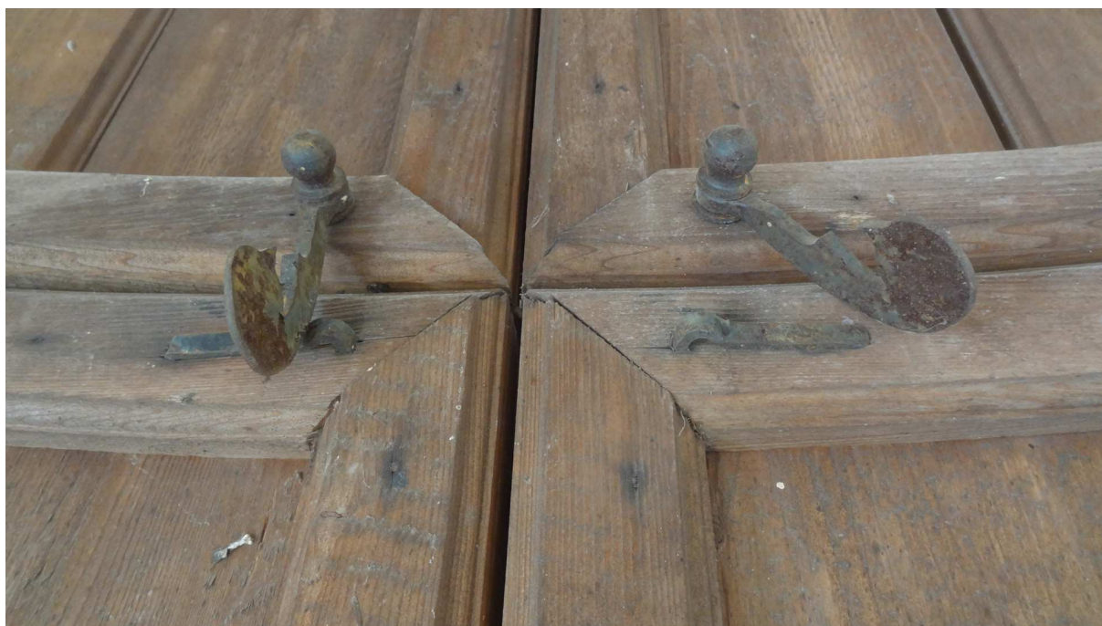
Korozní produkty na kování
