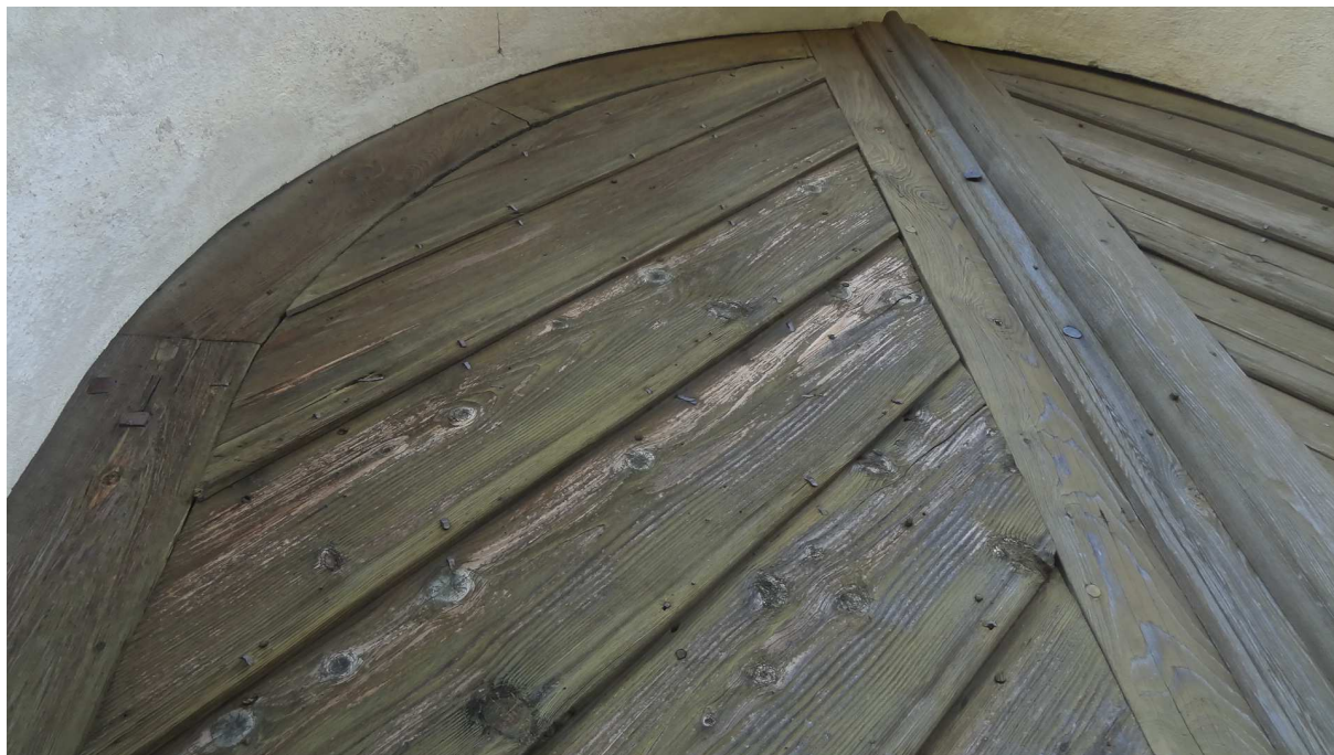
Degradované povrchové úpravy
