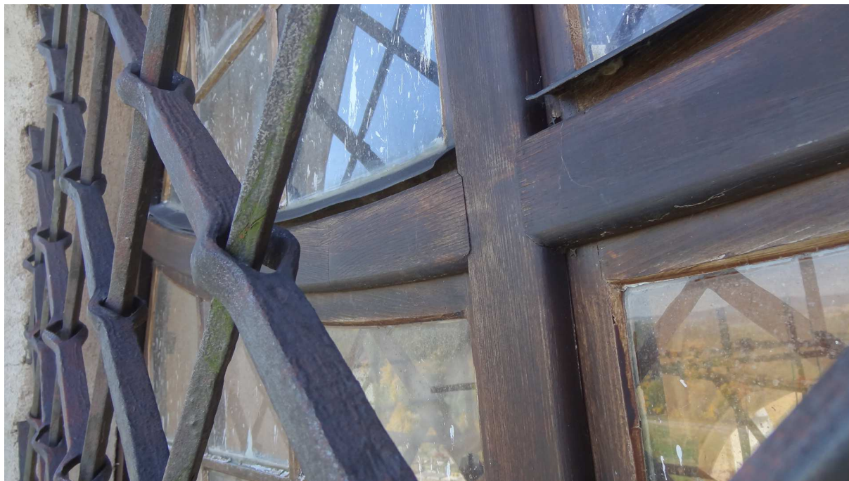
Detail degradovaných povrchových úprav oken z vnější strany
