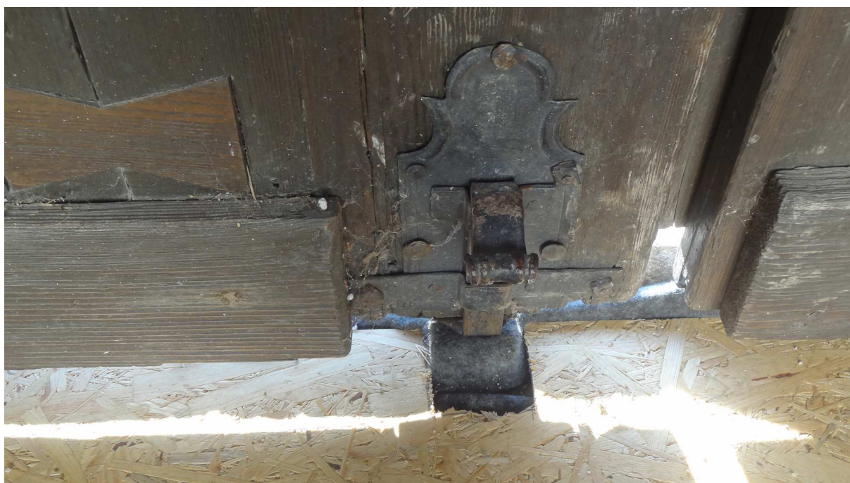
Korozní produkty na zástrčích
