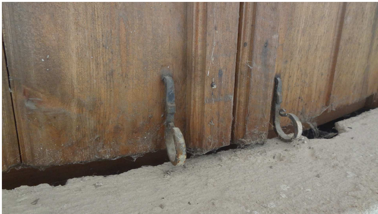
Korozní produkty na kování
