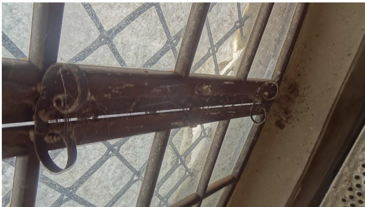
Detail mezery mezi oknem a rámem u malého okenního křídla
