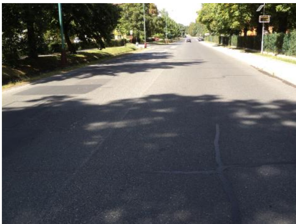
Trhlina rozvětvená příčná, vysprávký – km 1,500.
