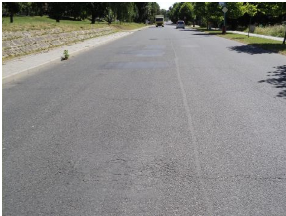
Trhlina široká příčná, síťové trhliny – km 0,800.
