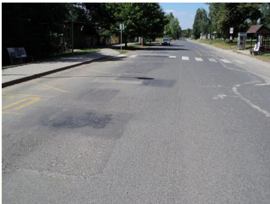
Hlubková koroze, vysprávkvy – km 1,000.
