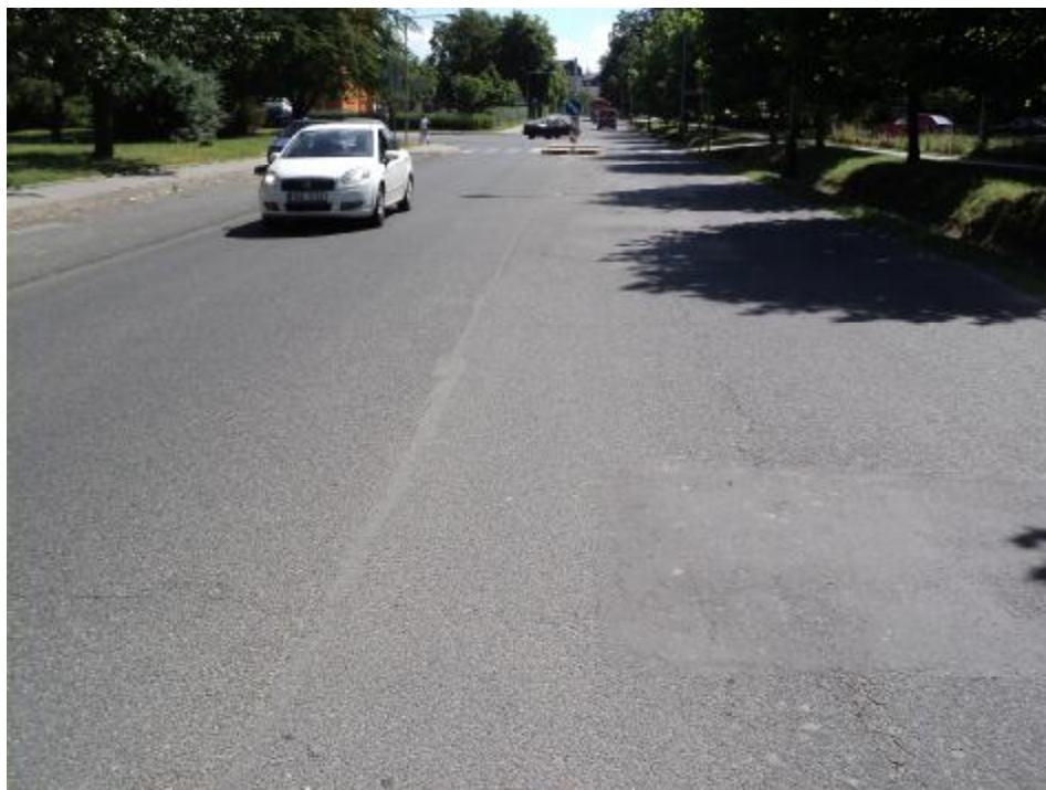
Trhlina široká podélná – km 1,200.
