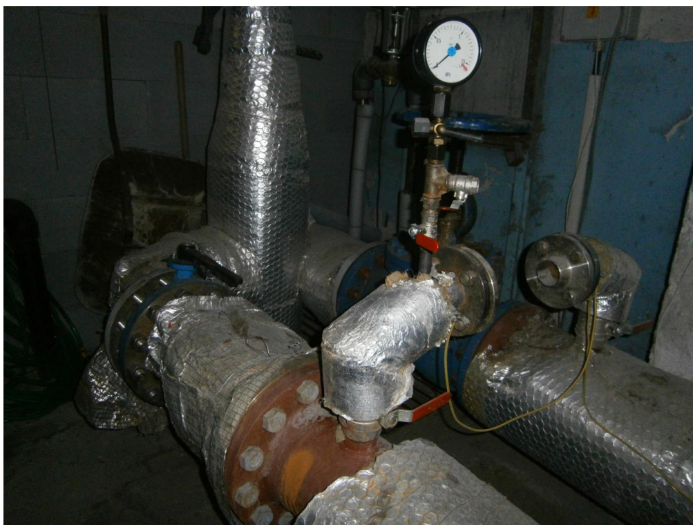
Obr. 4 – horkovodní uzel ve výměňkové stanici VS T.
