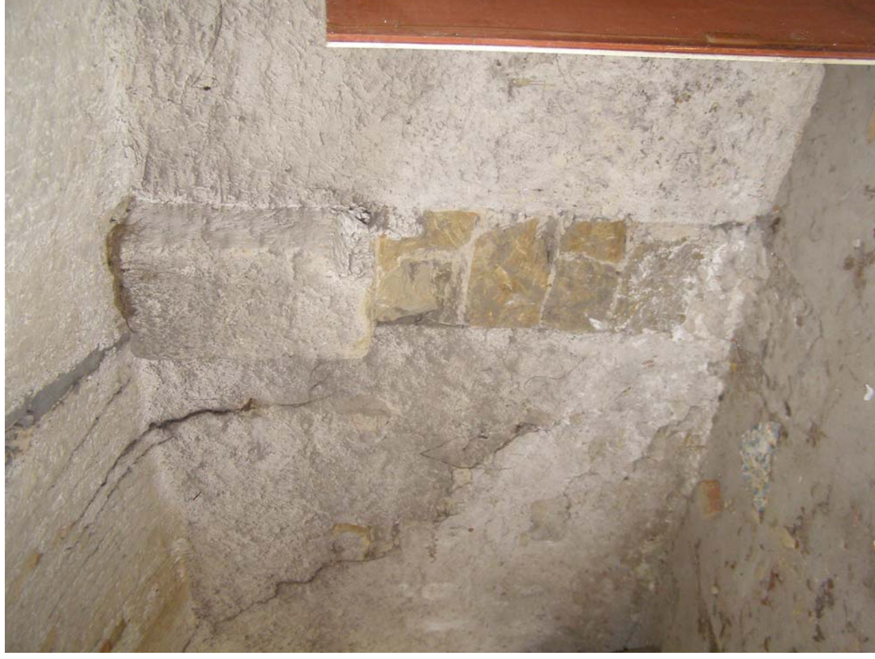
10. VNITŘNÍ NOSNÁ ZEĎ NARUŠENÁ TRHLINOU - POHLED Z MÍSTNOSTI 1.03
