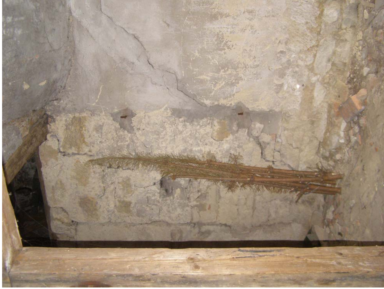
9. VNITŘNÍ NOSNÁ ZEĎ NARUŠENÁ TRHLINOU - POHLED Z MÍSTNOSTI 1.01
