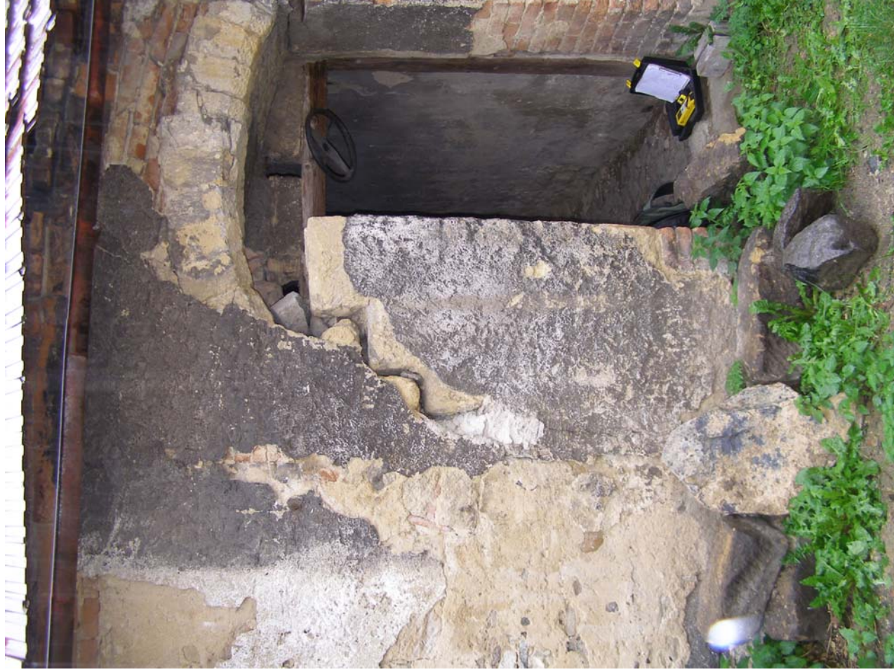
3. SEVERNÍ PRŮČELÍ - ZAZDĚNÁ ARKÁDA S NEROVNÝM ÚSEKEM ŘÍMSY
