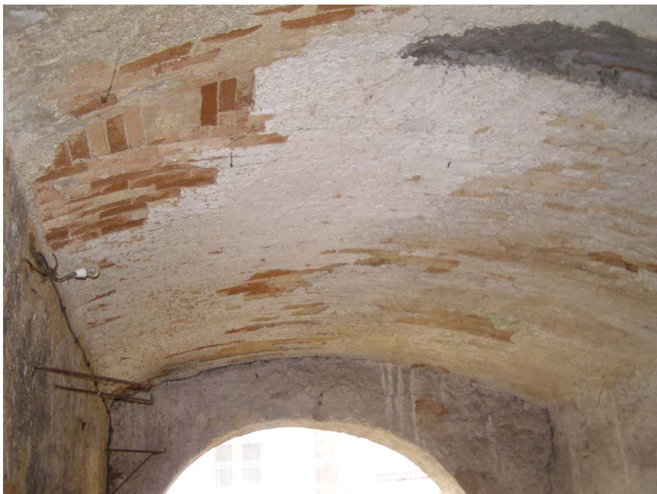
12. NARUŠENÁ CIHELNÁ KLENBA V MÍSTNOSTI 1.03
