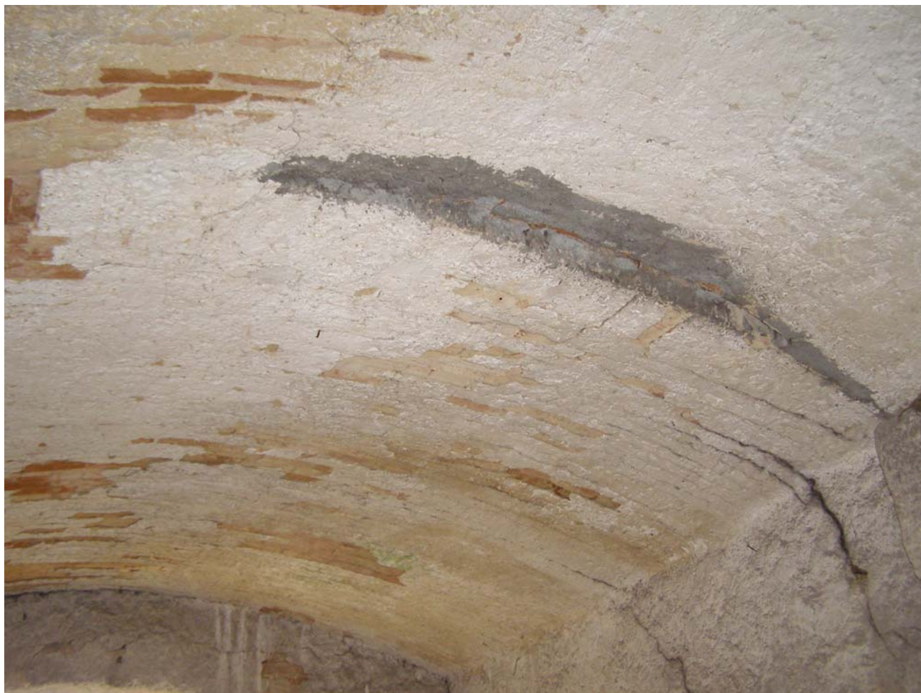
11. NARUŠENÁ CIHELNÁ KLENBA V MÍSTNOSTI 1.03
