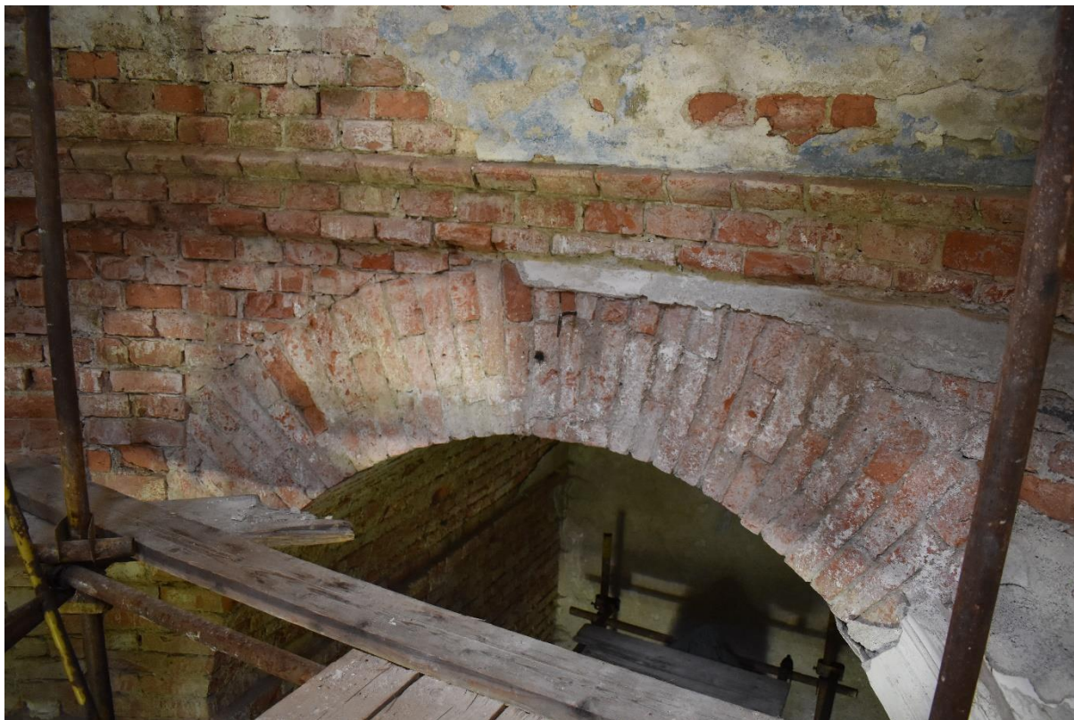
Jižní strana s chybějícím architrávem nad výklenkem kaple.
