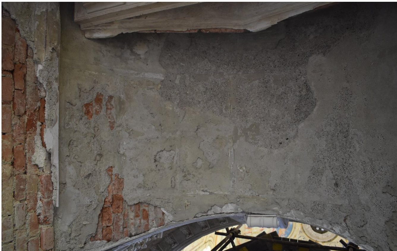
Zbytky kazetování nad vstupem.
