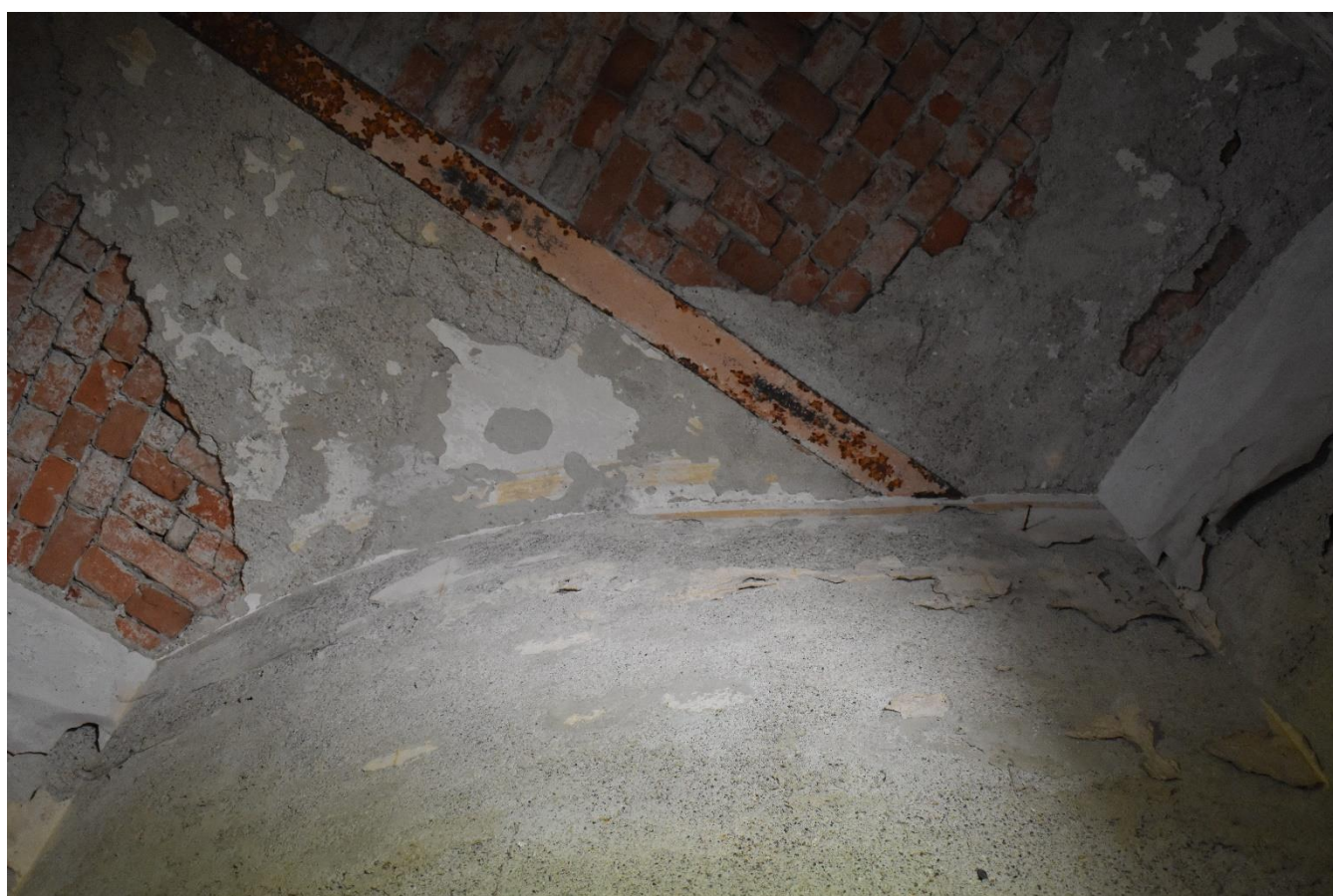
Severozápadní místnost, pohled na strop, kde jsou malby téměř odpadlé (viditelné linky a pás kolem stropu).
