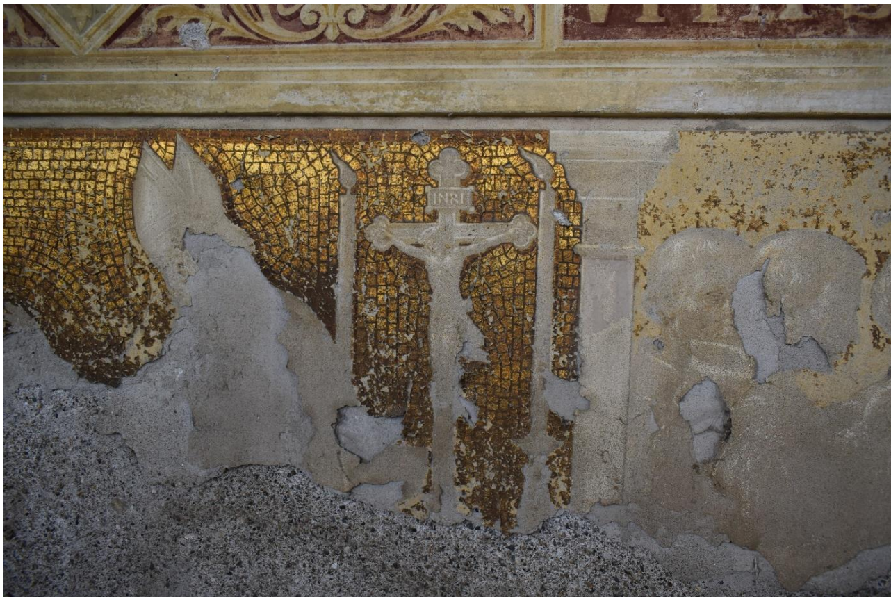
Další detail poškození malby s vrstvením omítek na severovýchodní straně.
