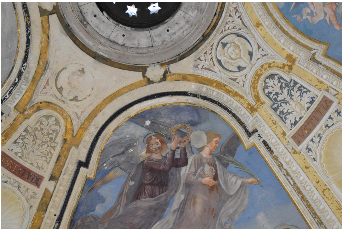
Detaily „Ukládání do hrobu“. Uvolněné omítky a odpadlé barevné vrstvy.
