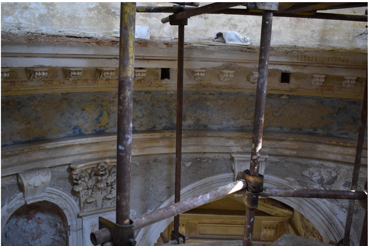
Pohled na severozápadní stranu. Pod vlysem jsou malby téměř celoplošně nedochovány. Jsou zde jen některé detaily, ovšem z nich nelze vyčíst motivy.
