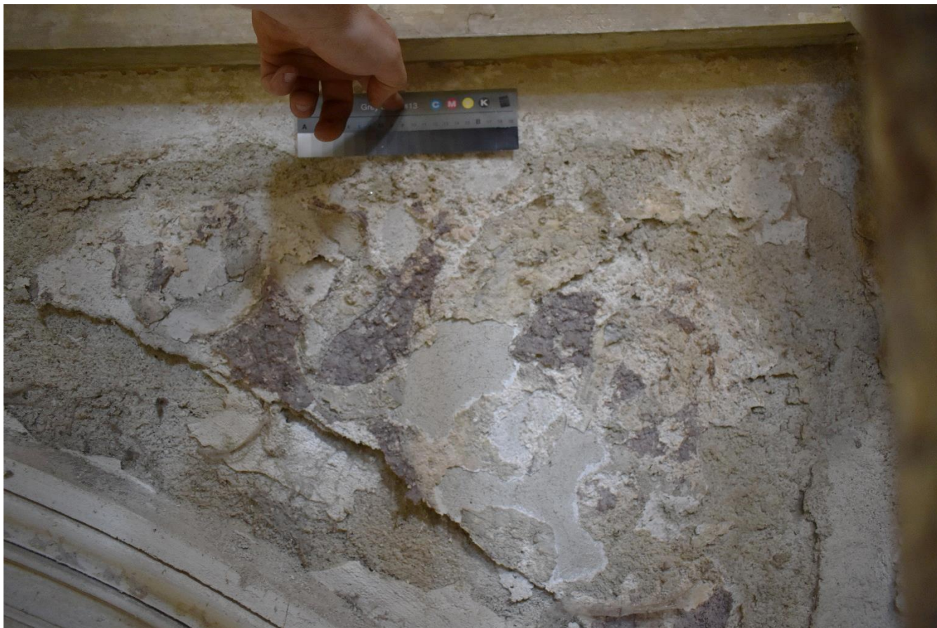
Detail zbytku malby nad archivoltou nad vstupem (křídlo ?).
