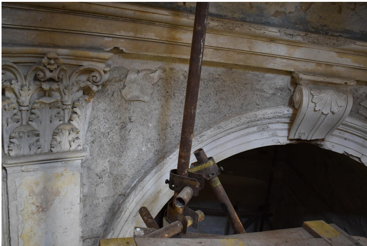
Detaily poškození na západojihu.
