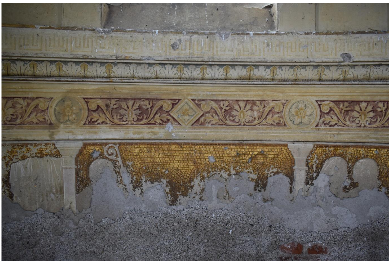
Pohled na poškozené výjevy na jižní straně. Další navazující část motivu. Poškození je výrazné a ve spodních partiích malba téměř mizí a omítky na mnoha místech chybí.
