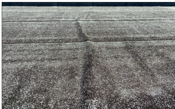
Foto /18/ Zvrásnění hydroizolační vrstvy.
