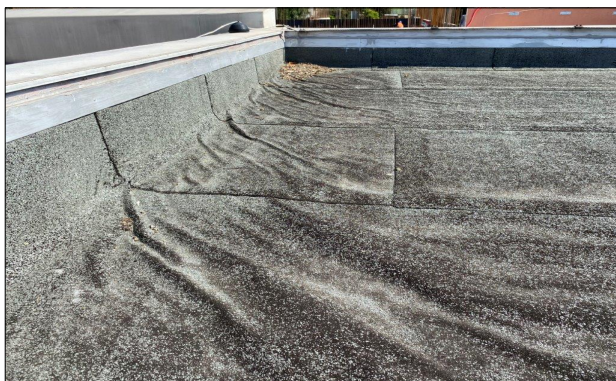
Foto /17/ Zvrásnění hydroizolační vrstvy.
