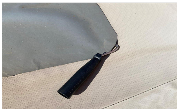
Foto /6/ Defekt ve spoji hydroizolačních fólií.
