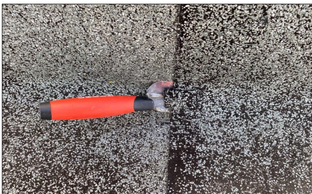
Foto /15/ Defekt ve spoji hydroizolační vrstvy.
