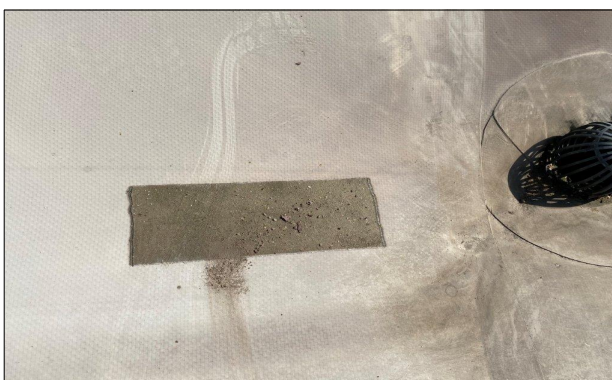
Foto /5/ Nesystémová oprava hydroizolační fólie.
