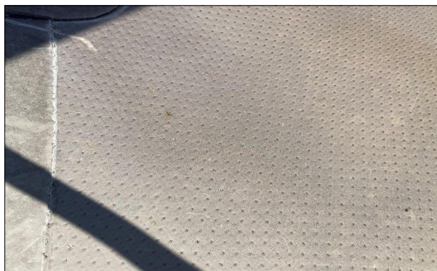
Foto /8/ Zvýšená degradace fólie (vystupující nosná vložka).
