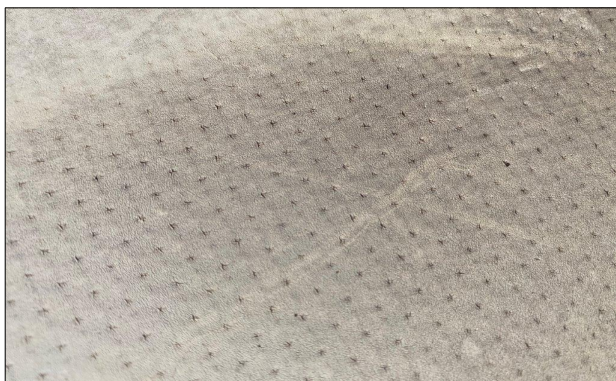
Foto /7/ Zvýšená degradace fólie (vystupující nosná vložka).
