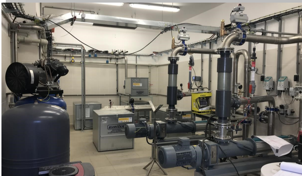
Foto 3: ČOV Horoušany – strojovna, čerpadla permeátu, dmychárna, ATS, kompresor
