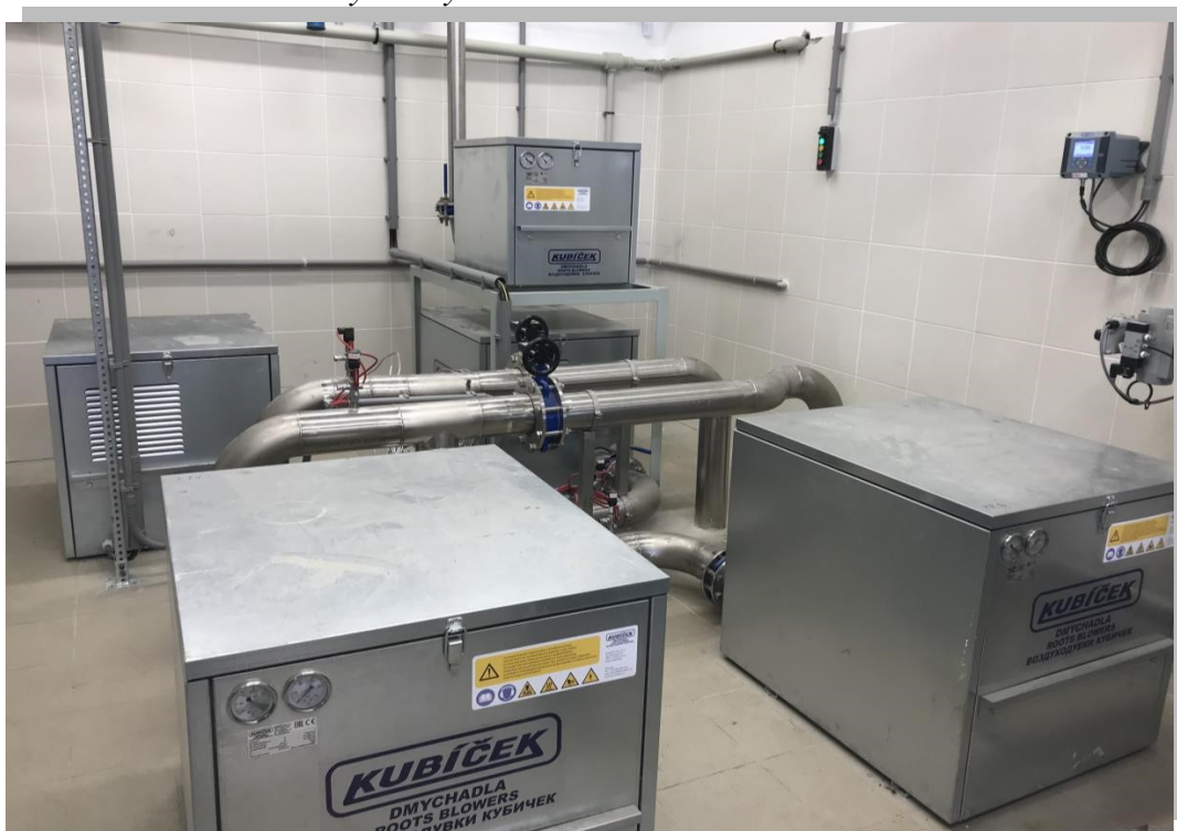
Foto 4: ČOV Horoušany – dmychárna
