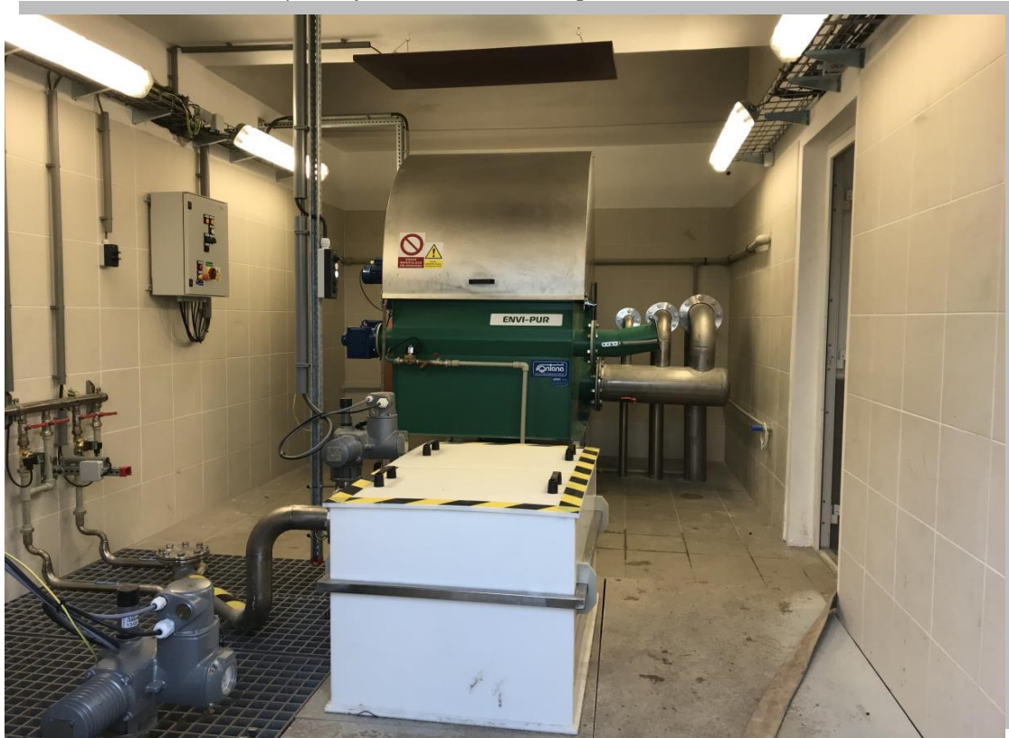
Foto 1: ČOV Horoušany – objekt mechanického předčištění
