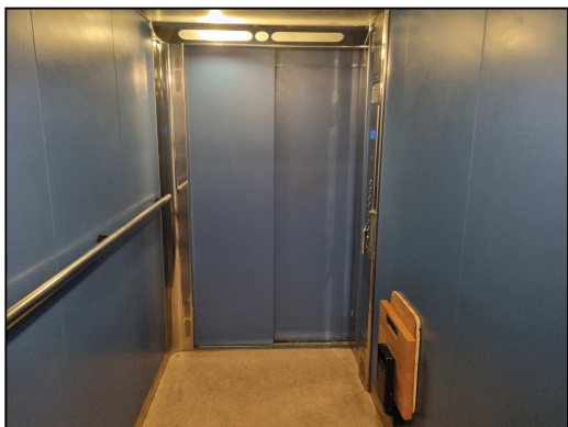
Obr.1 Kabina hydraulického výtahu
