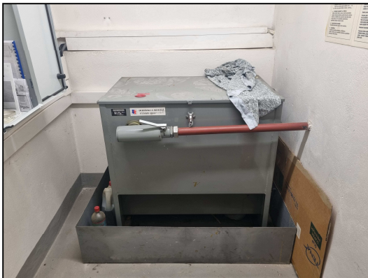
Obr.3 Agregát 90/E hydraulického výtahu
