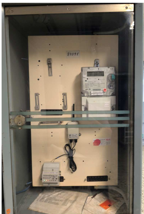
Obrázek 9.3 – stávající elektroměrová rozvodnice.
