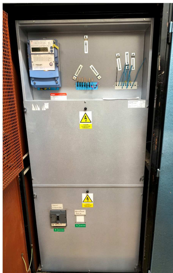
Obrázek 2.2 – vnitřní pohled na rozvaděč s elektroměrem a prostorem pro HDO
