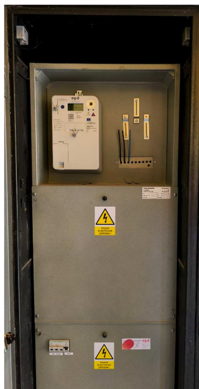
Obrázek 3.2 – vnitřní pohled na rozvaděč s elektroměrem a prostorem pro HDO
