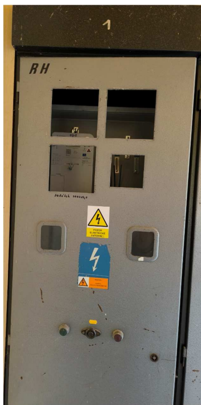
Obrázek 3.1 – vnější pohled na rozvaděč
