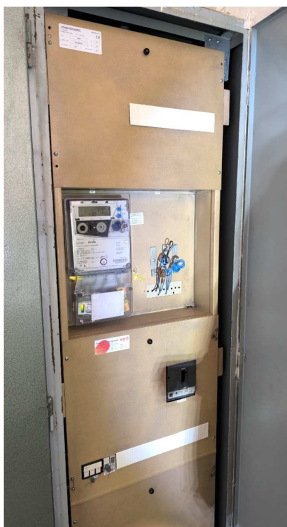
Obrázek 8.1 – vnitřní pohled na rozvaděč s elektroměrem a prostorem pro HDO
