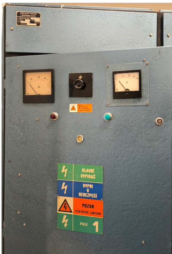
Obrázek 1.1 – vnější pohled na rozvaděč
