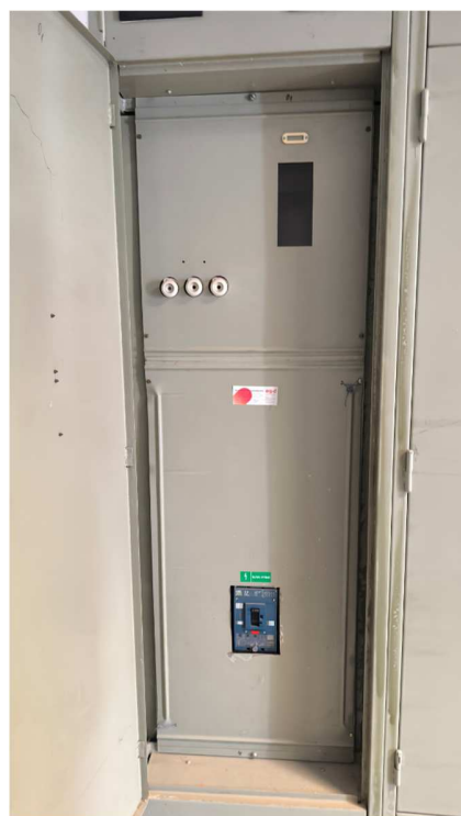
Obrázek 9.2 – vnitřní pohled na rozvaděč
