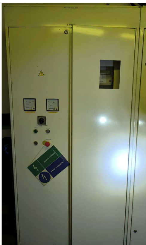
Obrázek 4.1 – vnější pohled na rozvaděč
