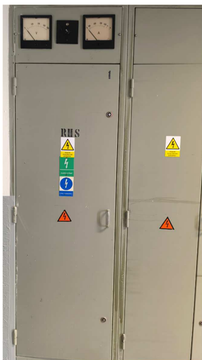
Obrázek 9.1 – vnější pohled na rozvaděč
