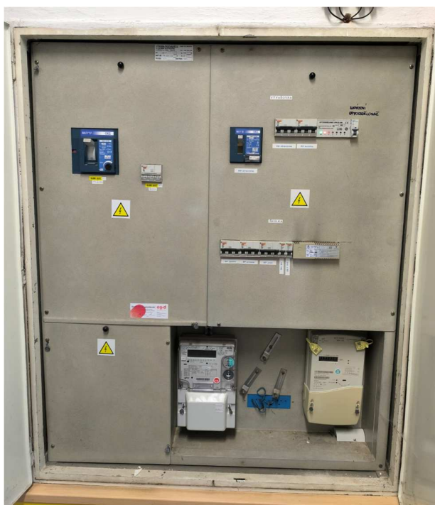
Obrázek 10.2 – vnitřní pohled na rozvaděč s elektroměrem a prostorem pro HDO
