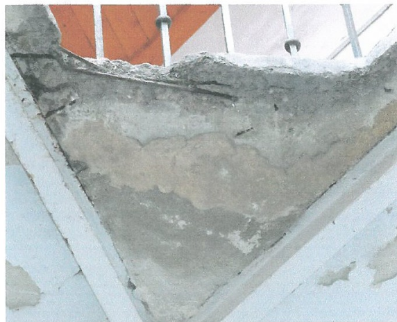
10 – Okraje pavlači jsou erodované.
