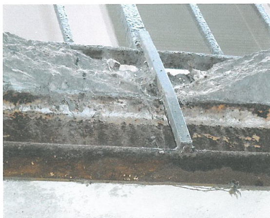
15 - Okraje pavlačí jsou erodované, podélník rezavý.
