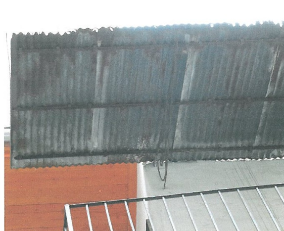
6 – Plechová stříška je zkorodovaná.
