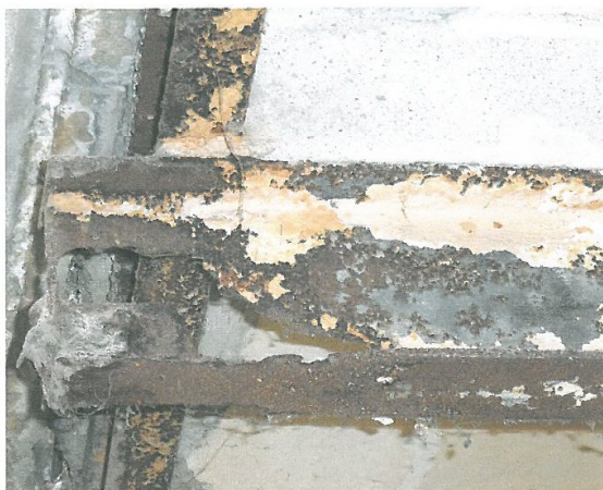
13 – Ve II.NP je první krajní konzola na konci zkorodovaná. na konci zkorodovaná.
