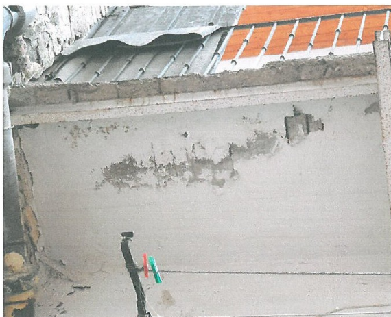
7 – Ve III.NP prosvítá přes malbu odprýskaný pohled.
