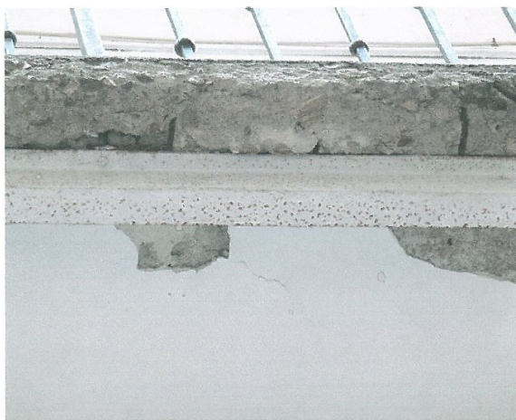
9 - Okraje pavlači jsou erodované.
