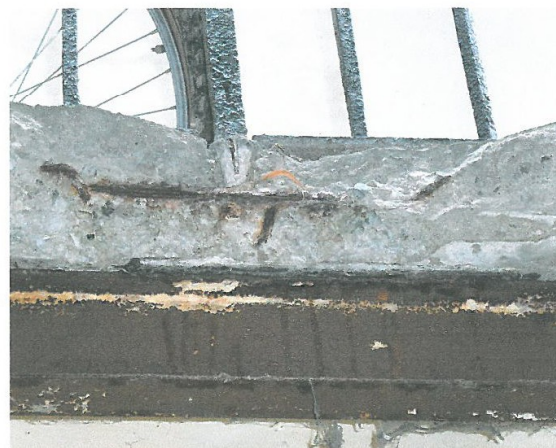
16 – Okraje pavlačí jsou erodované, podélník rezavý.
