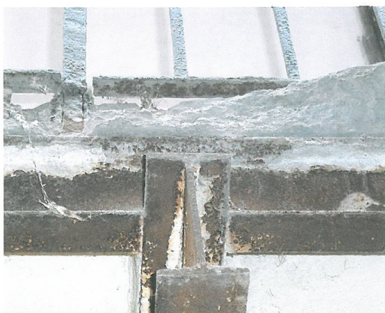
17 – Okraje pavlačí jsou erodované, podélník rezavý.
