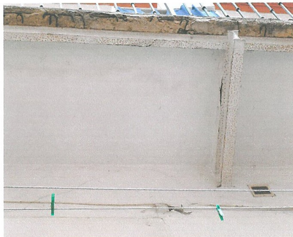
8 – Okraje pavlači jsou erodované.
