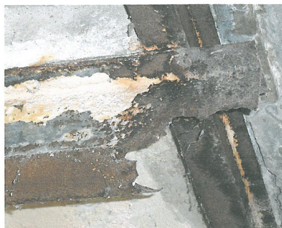
14 – Ve II.NP je druhá krajní konzola na konci zkorodovaná.
