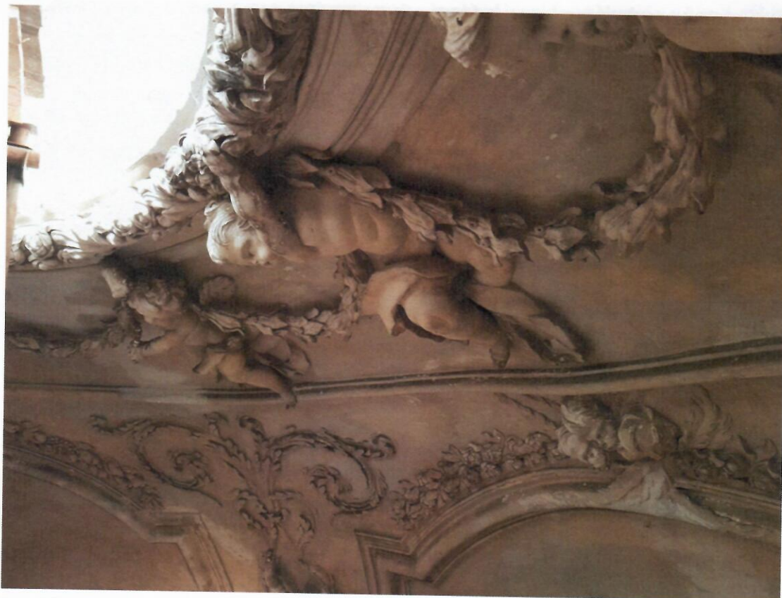
Detail štukové výzdoby kaple k restaurování.
