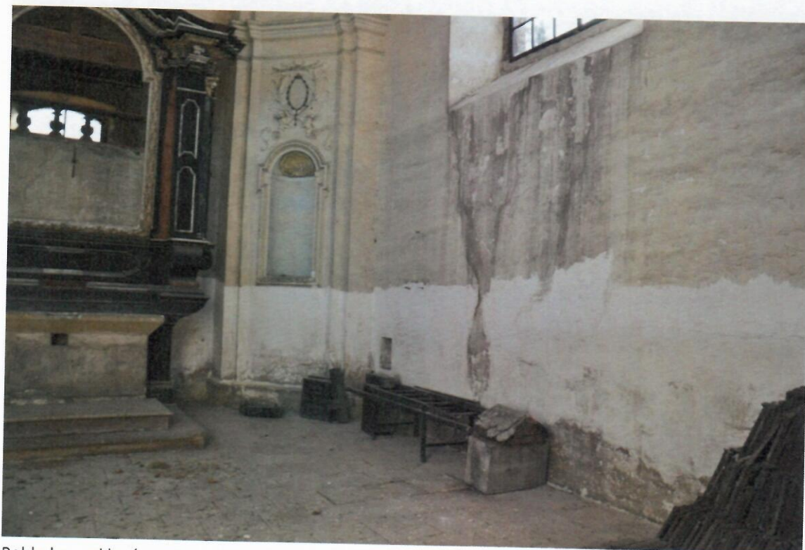
Pohled na soklové partie nevhodných cementových interiérových omítek kaple. Značné trhliny v omítkách.
