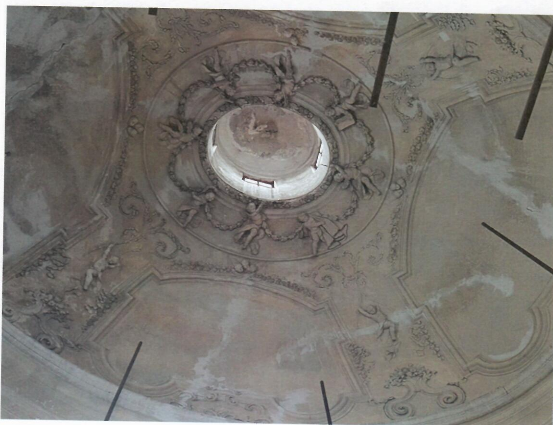
Pohled do kupole kaple na rozsáhlou štukovou výzdobu k restaurování.
