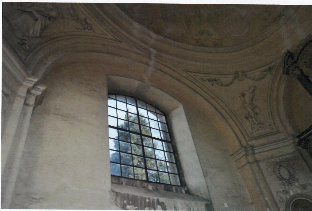
Praskliny v omítkách stěn, ostění a kleneb.
