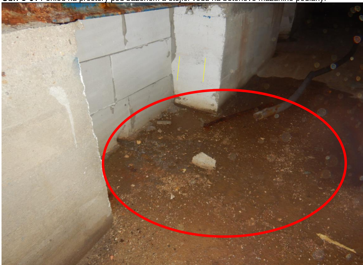
Obr. C-32 Pohled na prostory pod bazénem a stojící vodu na betonové mazanině podlahy.
