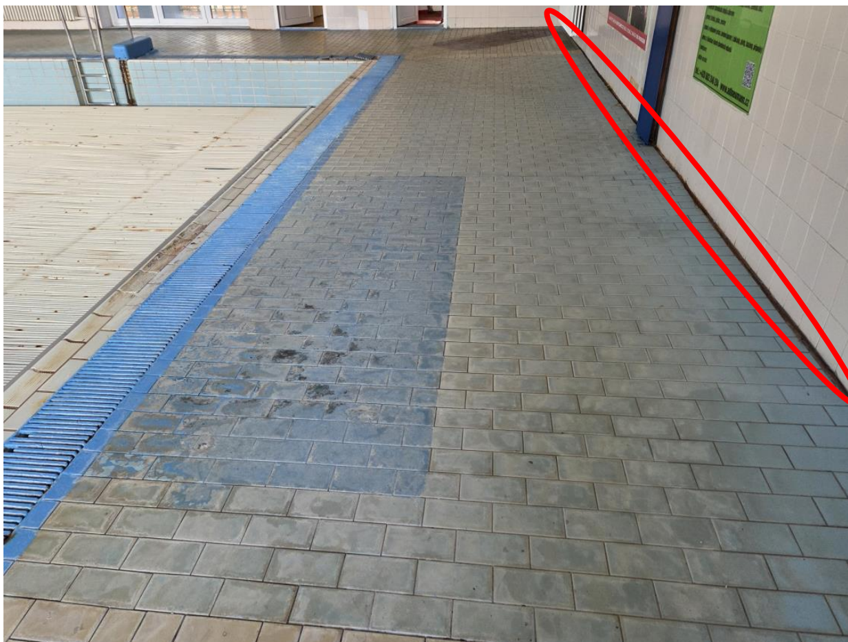
Obr. C-55 Pohled na keramickou dlažbu na ochozech v hale plaveckého bazénu v II.NP a místa poškozené keramiky.
