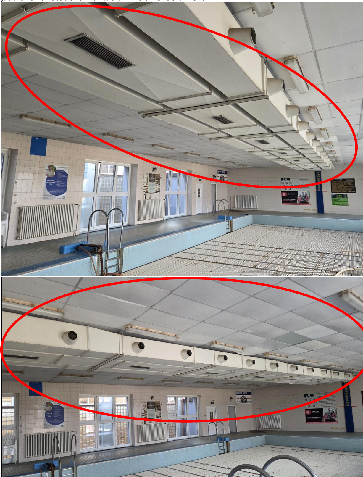
Obr. C-65 Pohled na stávající rozvody vzduchotechniky v plaveckém krytém bazénu.
