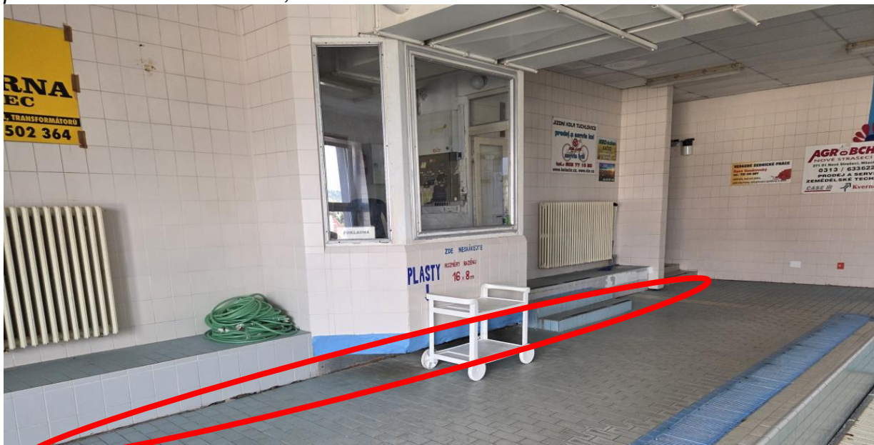
Obr. C-54 Pohled na keramický obklad v hale plaveckého bazénu v II.NP a místa poškození keramiky.
