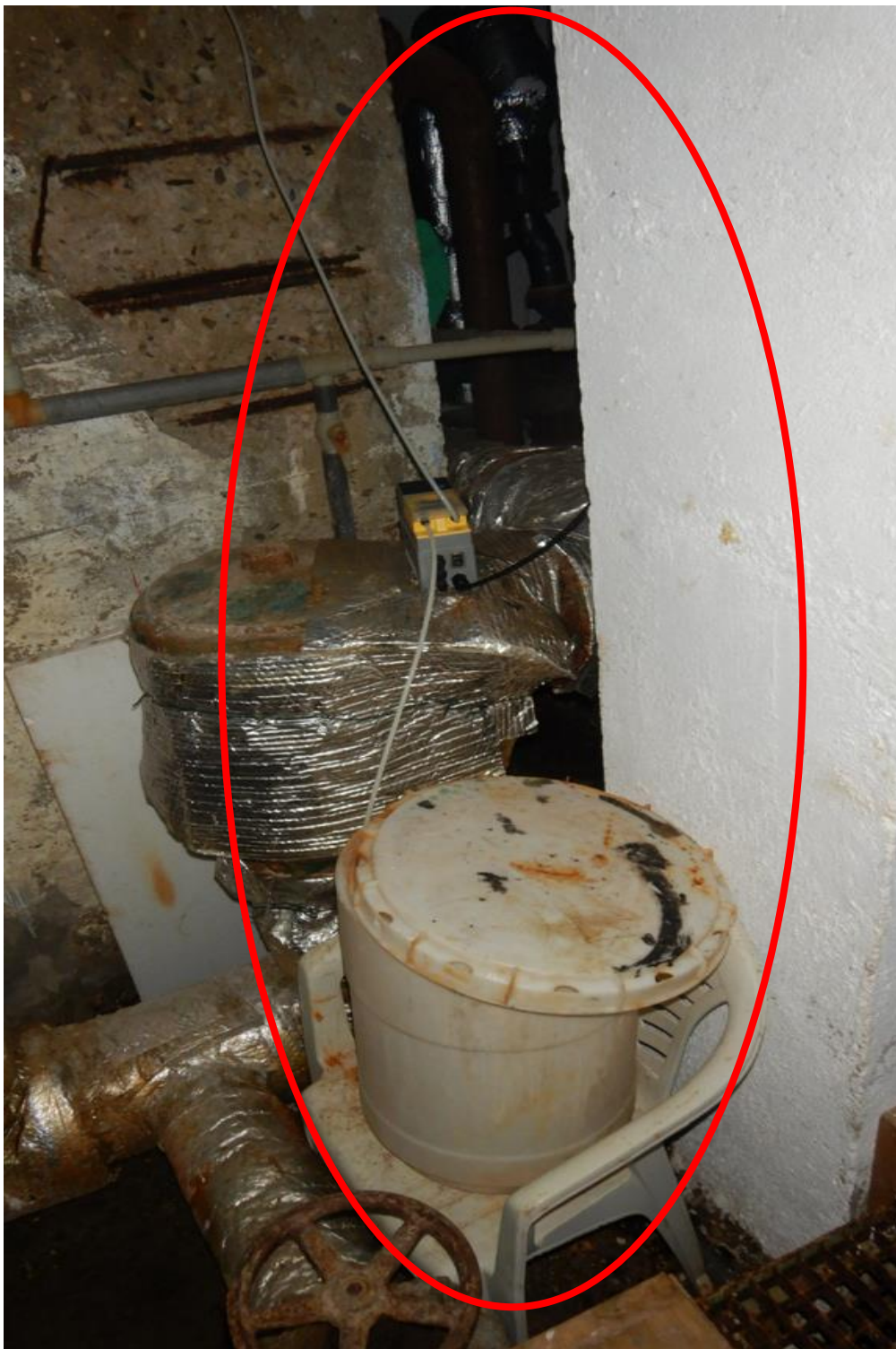
Obr. C-11 Pohled na nevhodné, nebezpečné dávkování činidla do bazénového recirkulačního okruhu.
