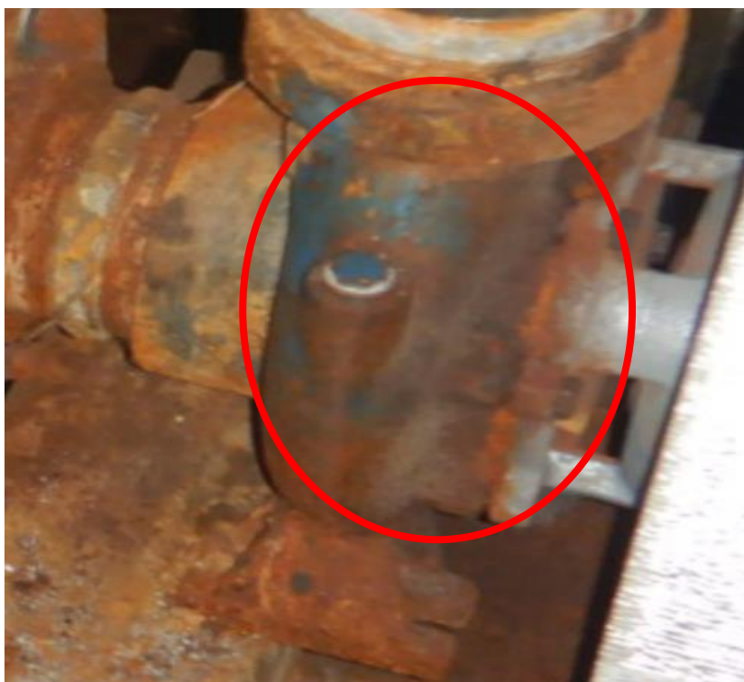
Obr. C-5 Pohled na zkorodovaný difuzor a úchyty recirkulačního čerpadla.
