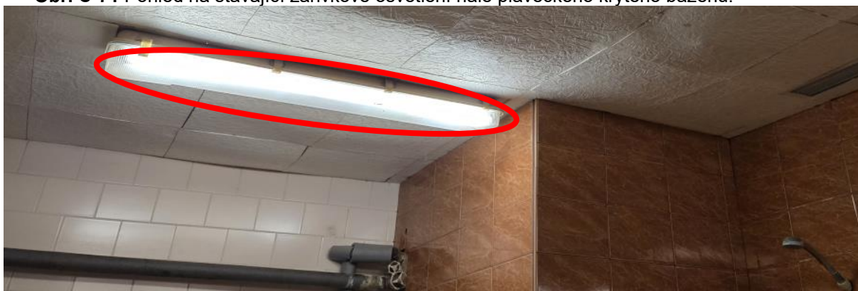
Obr. C-72 Pohled na stávající zářivkové osvětlení v sociálním zázemí plaveckého krytého bazénu.
