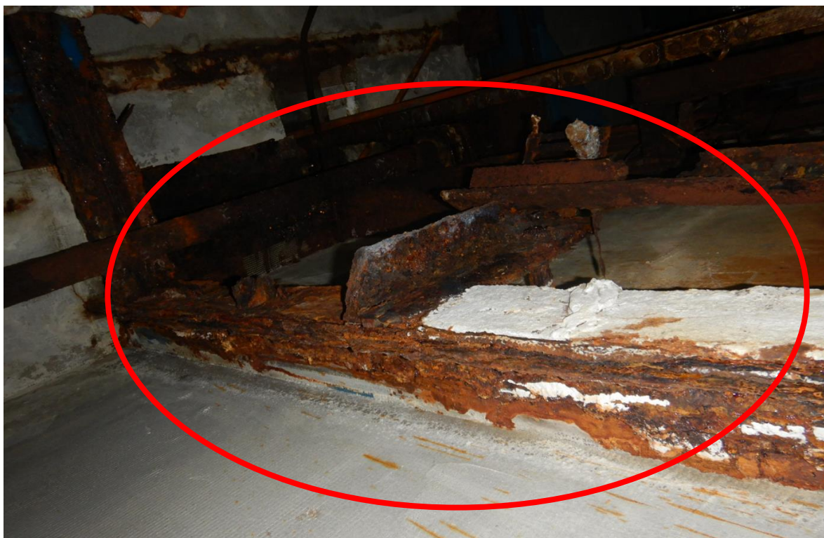
Obr. C-36 Detailní pohled na zkorodovanou ocelovou konstrukci mechanismu posunu mezidna plaveckého bazénu.
