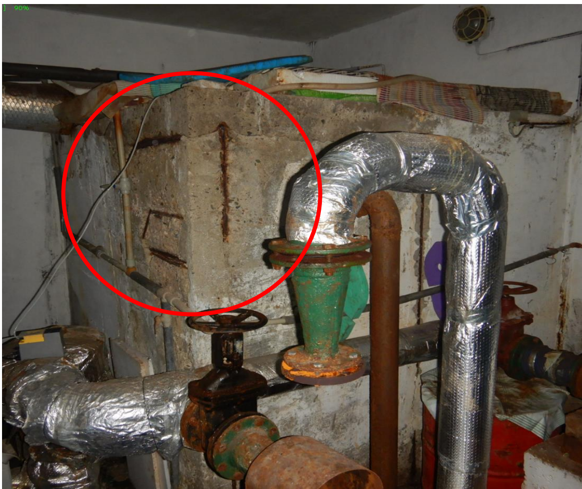
Obr. C-2 Pohled na odhalenou, zkorodovanou výztuž a degradaci železobetonové konstrukce akumulční nádrže plaveckého bazénu.
