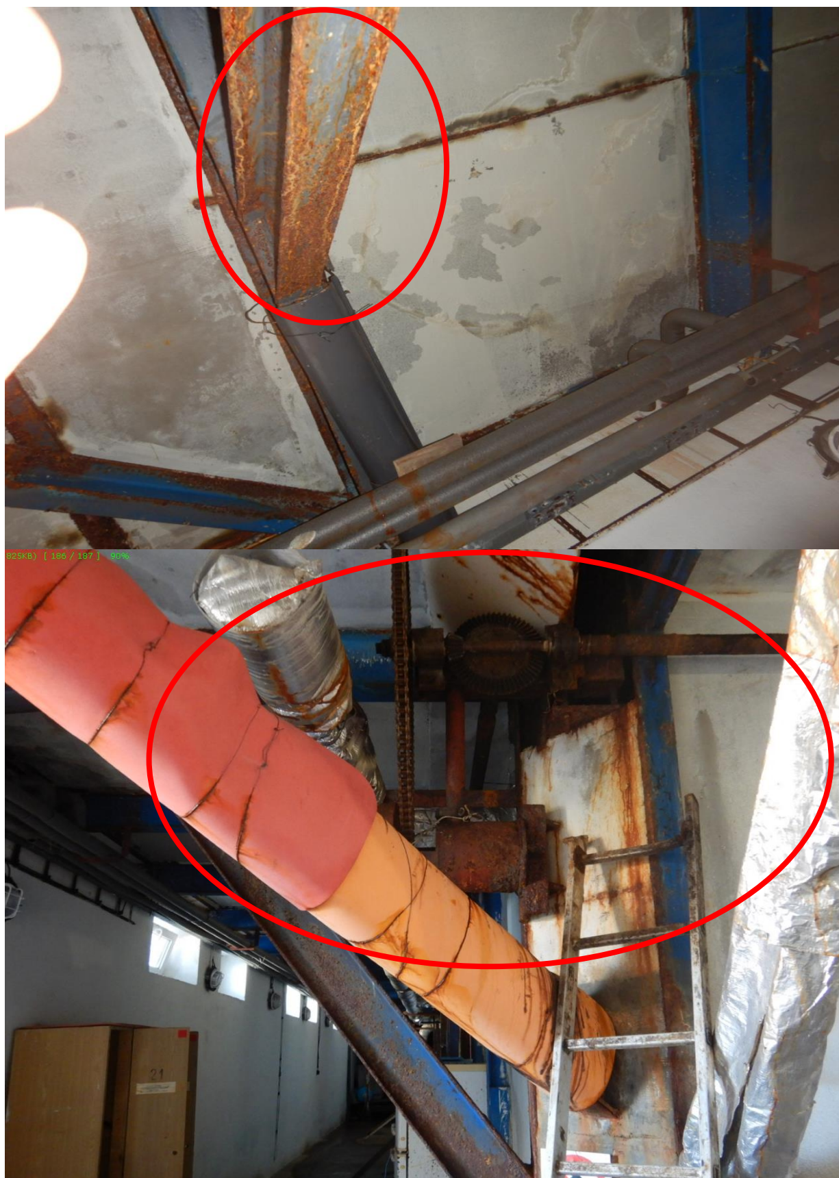
Obr. C-45 Pohled na ocelové výztuže stropu ochozu v I.NP krytého plaveckého bazénu. Ocelová konstrukce je ve většině, kromě pár případů, napadena korozí pouze povrchově, a tudíž postačí pískování a opakovaný nátěr. U silně napadených ocelových nosníků je nutné jejich zesílení.
