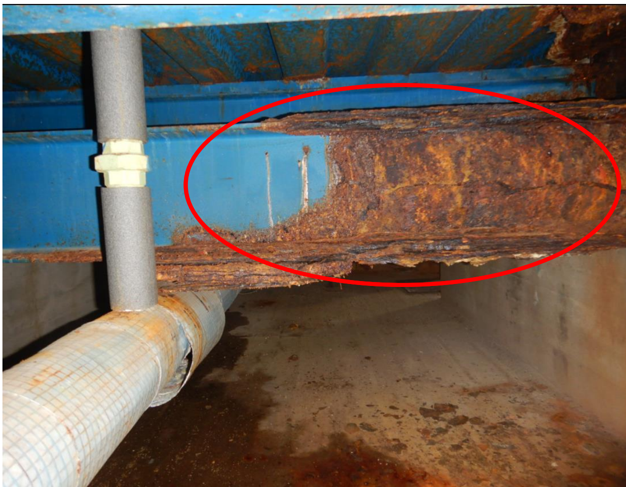
Obr. C-24 Pohled na rozsah koroze na ocelovém I profilu, kde je patrné tzv. listování ocele, kdy se odlupují jednotlivé pláty ocele o tloušťce až 2 mm. Součástí obrázku je rozvodné přívodní potrubí upravené vody vedoucí do trysek ve dně bazénu.
