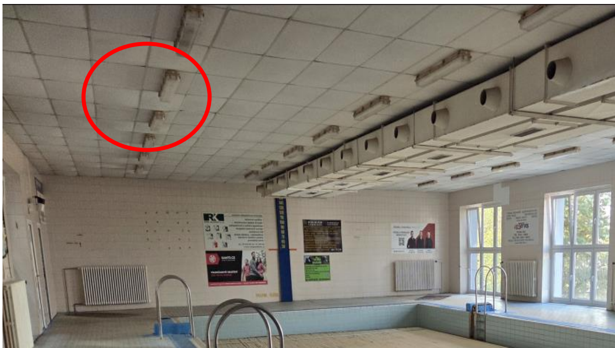
Obr. C-58 Pohled na podhled na ochozech v hale plaveckého bazénu v II.NP a lokálně vybořená místa až odpadávající desky.
