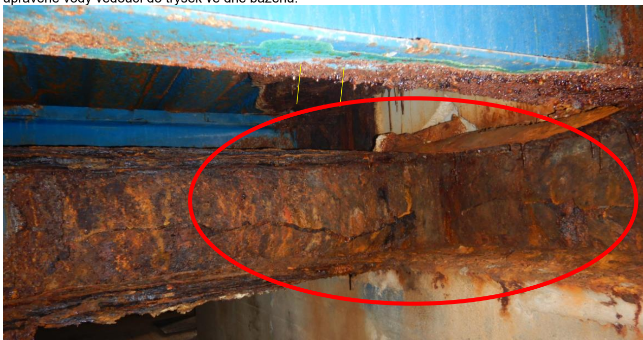
Obr. C-25 Jiný pohled na rozsah koroze na ocelovém I profilu, kde je patrné tzv. „listování“ ocele, kdy se odlupují jednotlivé pláty ocele o tloušťce až 2 mm.
