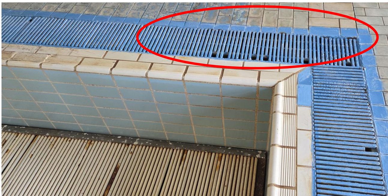
Obr. C-18 Detailní pohled na poškozené roštnice kryjící přelivný žlábek vnitřního bazénu.
