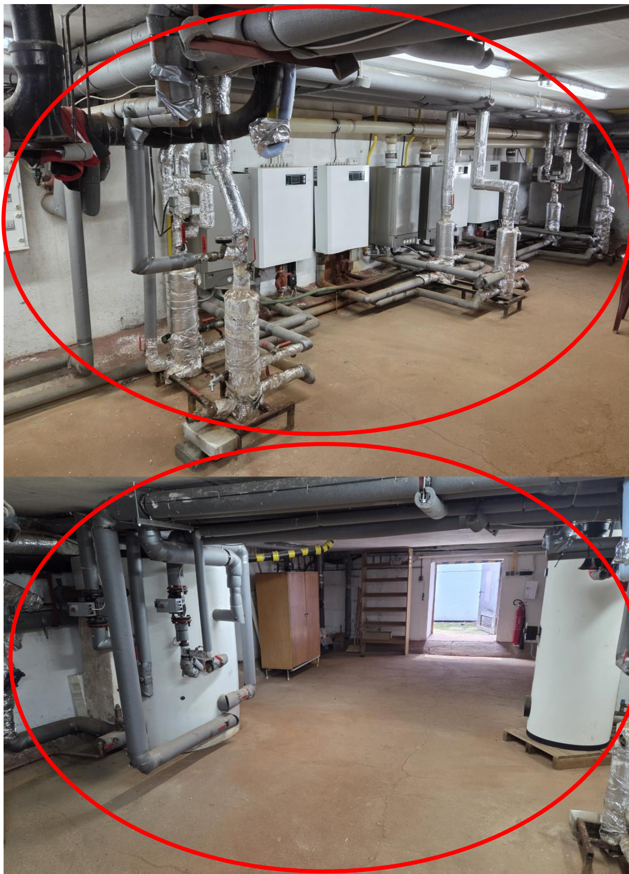
Obr. C-77 Pohled na stanici pro ohřev vody do sprch, radiátorů a primárního okruhu včetně zapojení tepelných čerpadel.
