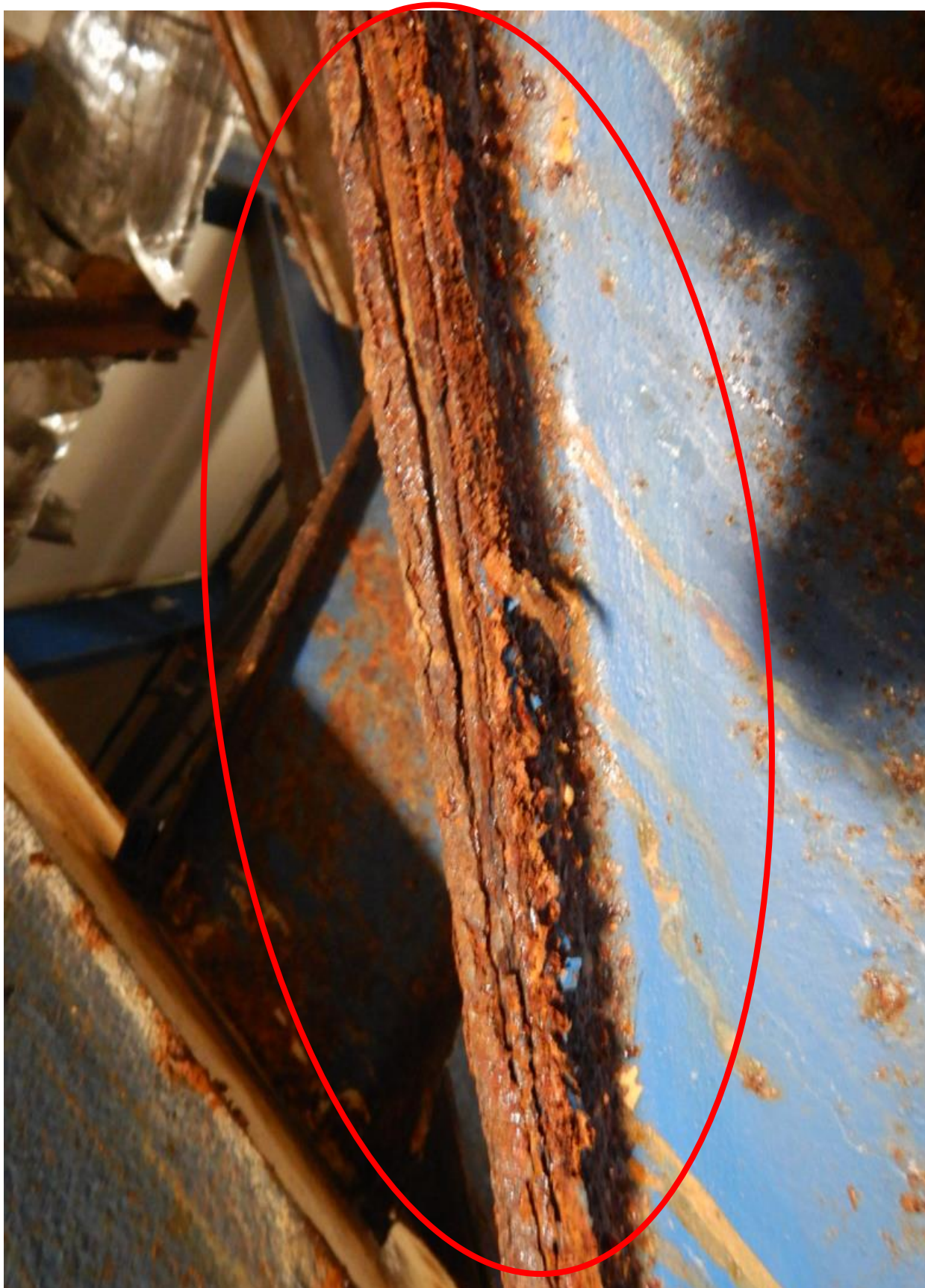
Obr. C-46 Pohled na ocelové výztuže stropu ochozu v I.NP krytého plaveckého bazénu. Ocelová konstrukce je napadena silně korozí a je nutné její zesílení.
