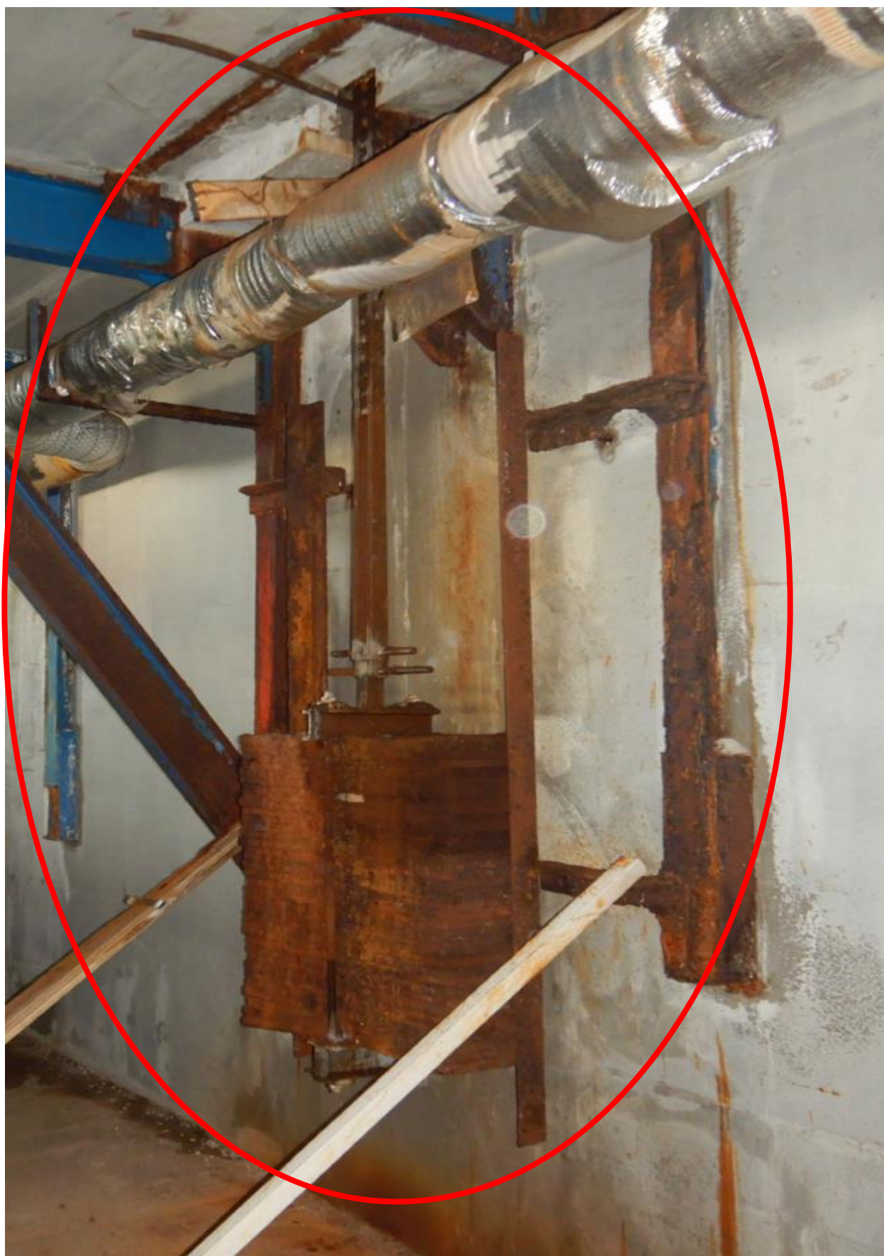
Obr. C-33 Pohled na zkorodovanou ocelovou konstrukci mechanismu posunu mezidna v bazénu.
