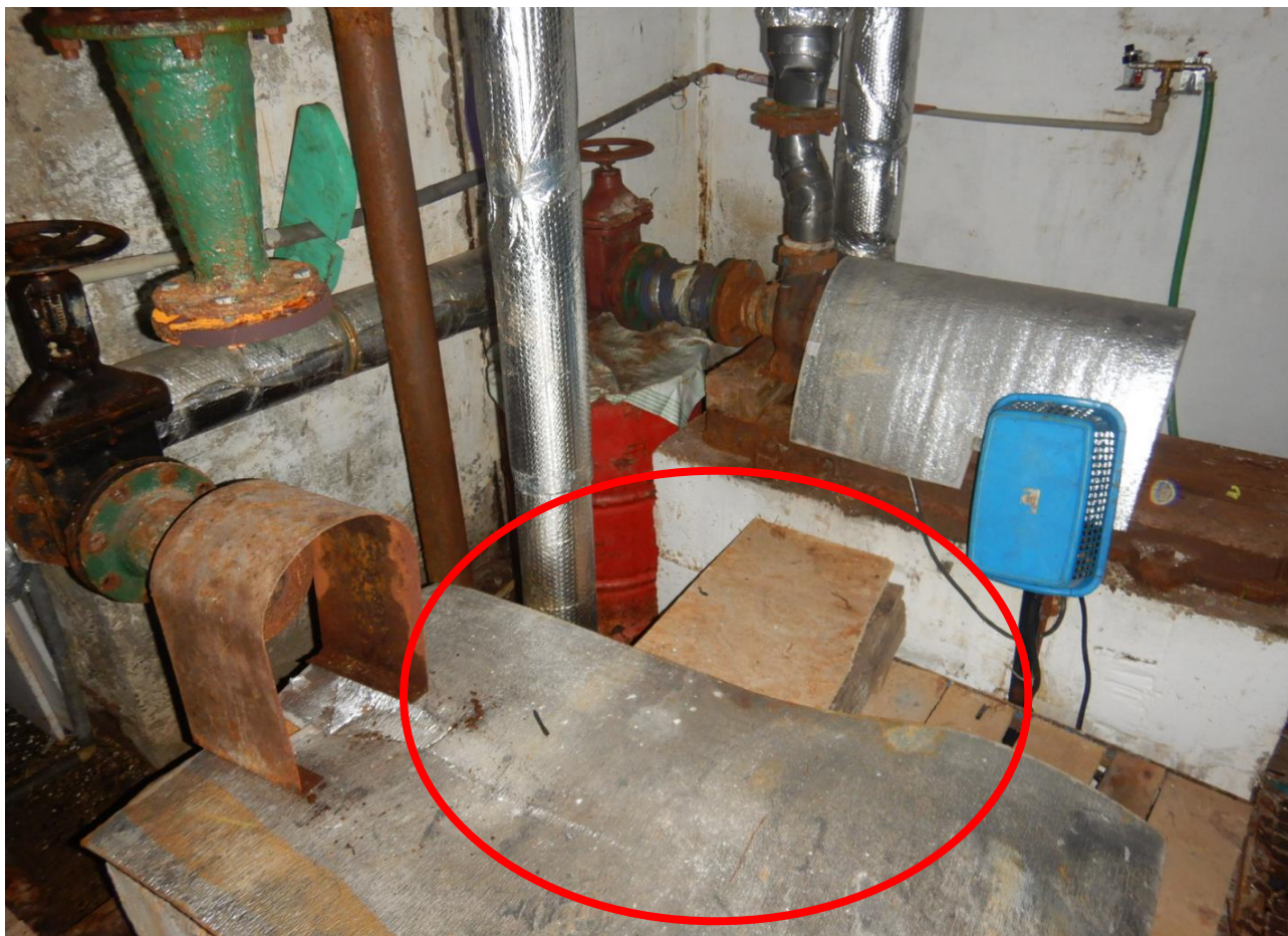
Obr. C-4 Pohled na chybějící recirkulační čerpadlo.
