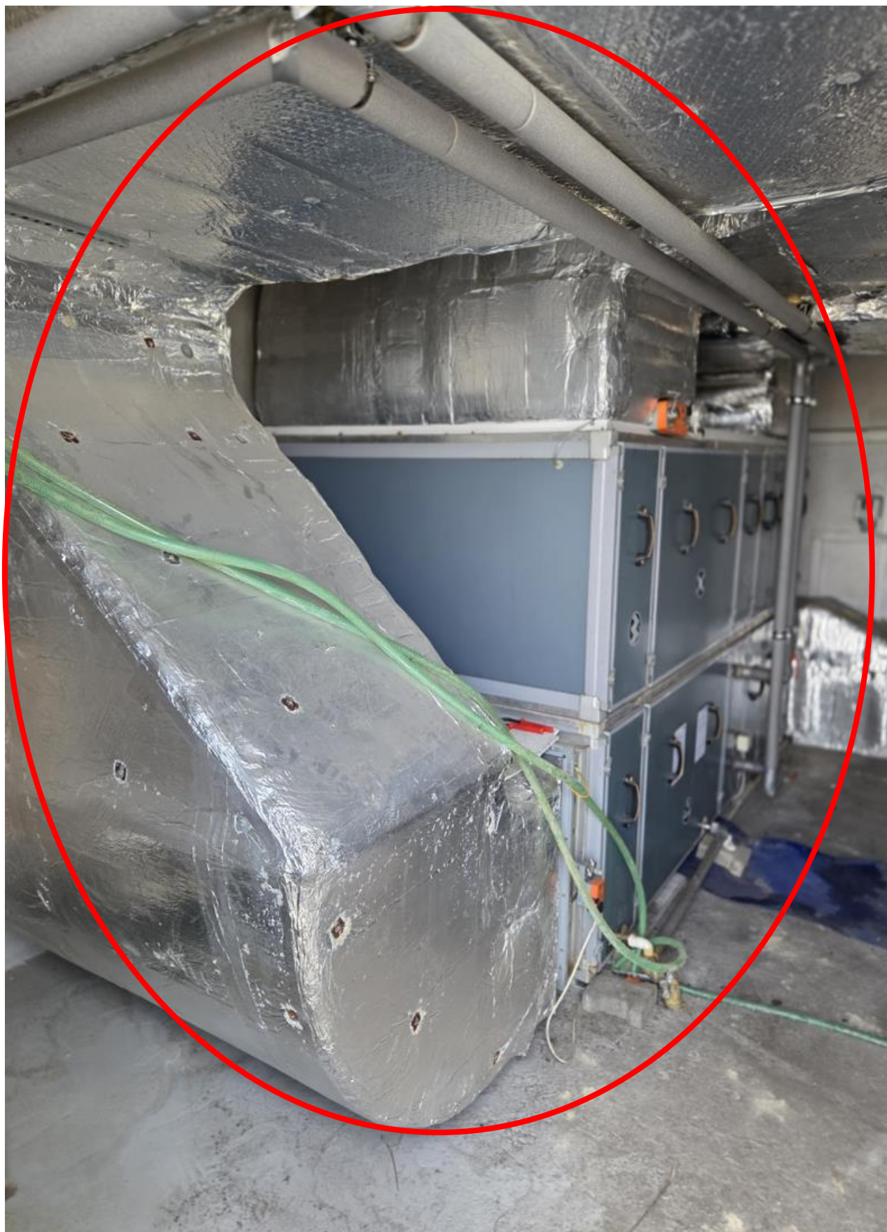
Obr. C-79 Pohled na vzduchotechnickou jednotku umístěnou v uzavřených prostorech ve III. NP.
