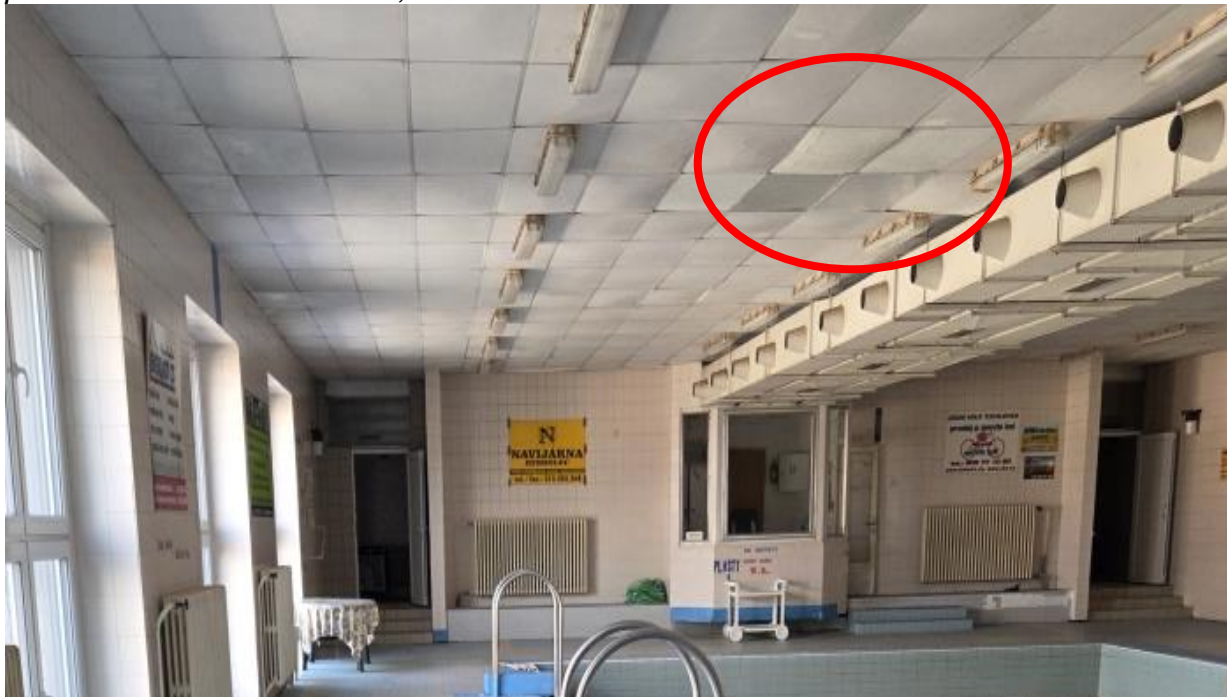
Obr. C-57 Pohled na podhled na ochozech v hale plaveckého bazénu v II.NP a lokálně vybořená místa až odpadávající desky.
