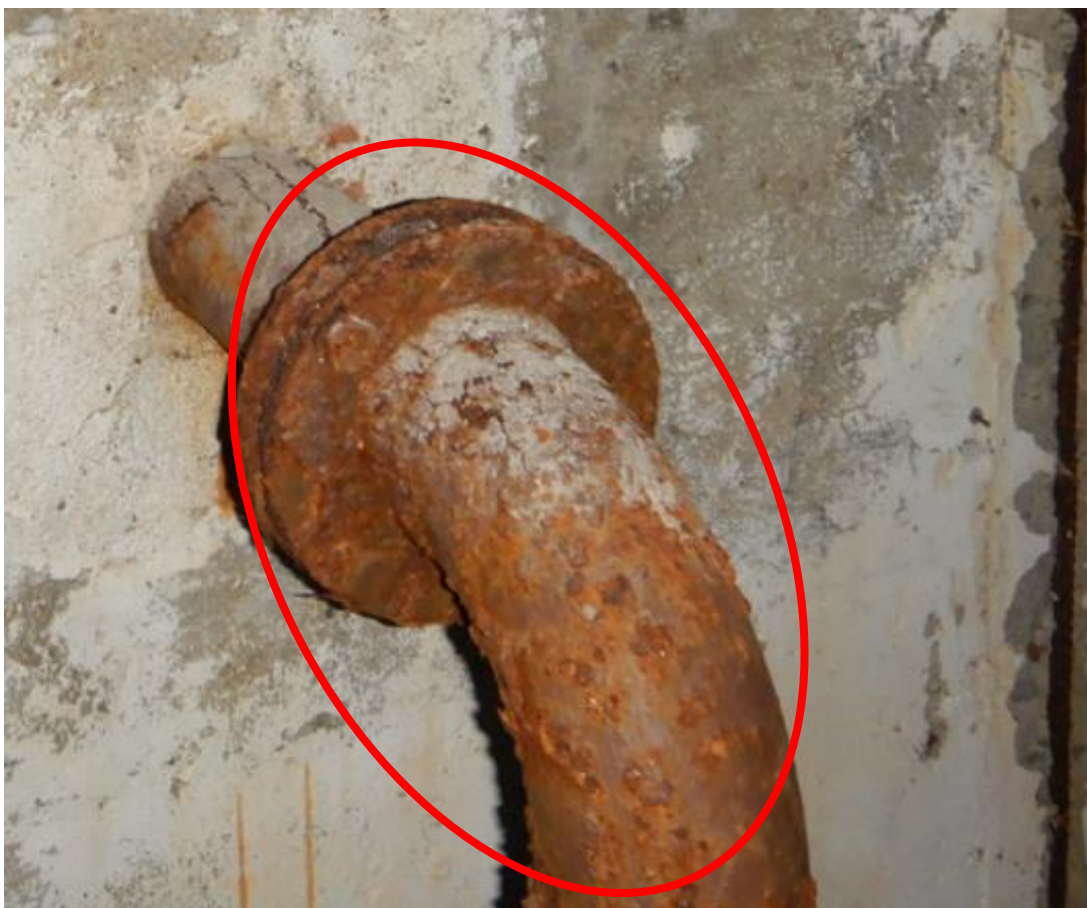
Obr. C-14 Pohled na rozsáhlou korozi gravitačního potrubí.
