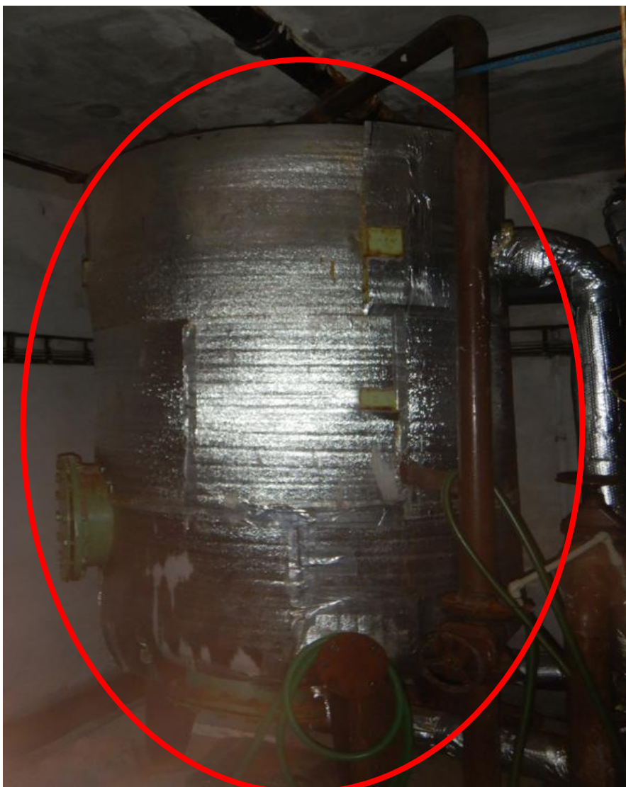
Obr. C-6 Pohled na stávající ocelový filtr plaveckého bazénu, který je obalen hliníkovou folií.
