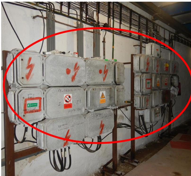
Obr. C-12 Pohled na spínače a pojistky silnoproudých rozvodů v technologii úpravy bazénové vody
