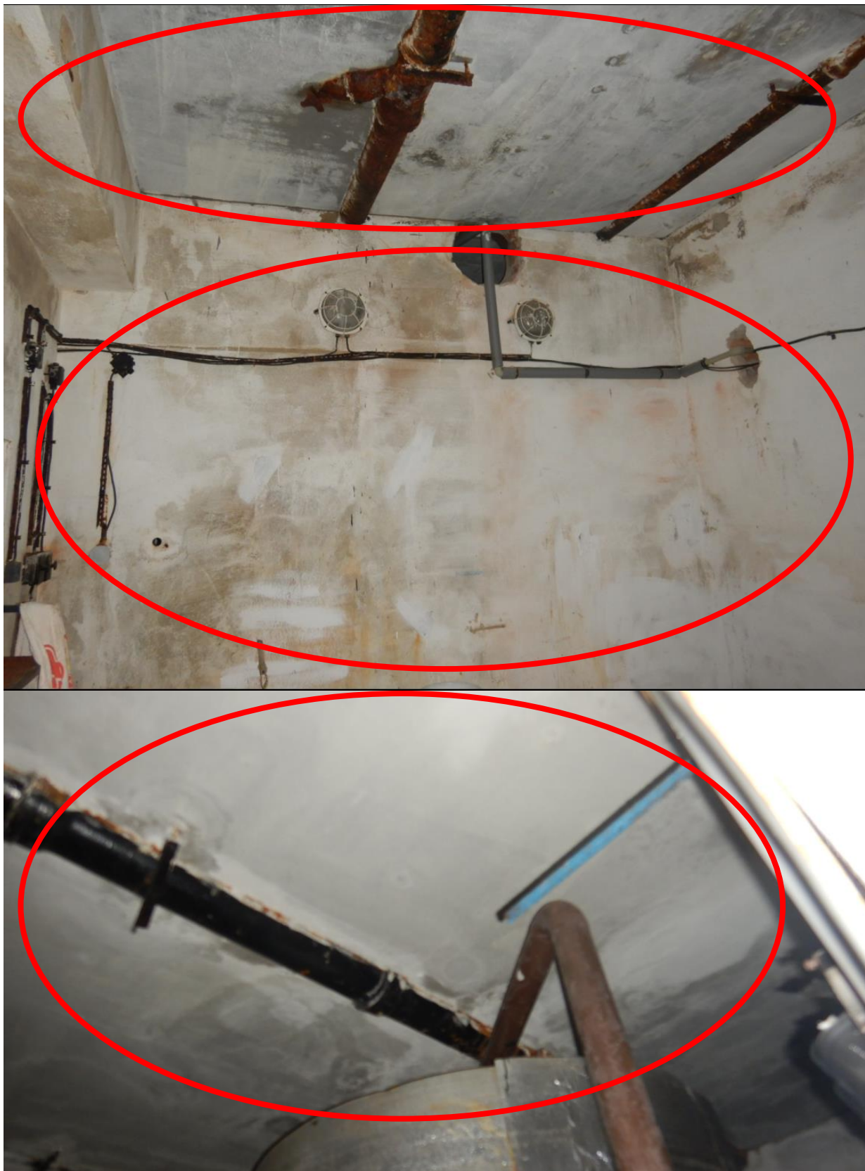
Obr. C-39 Pohled na vlhké mapy na zdi a stropu v I.NP krytého plaveckého bazénu, které jsou způsobeny pravděpodobně vzdušnou vlhkostí, popřípadě zatékáním či vztlínáním vody.
