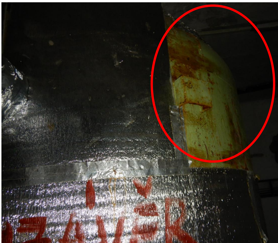
Obr. C-7 Detailní pohled na korozi odkryté části ocelového filtru horního vrchlíku filtru plaveckého bazénu.
