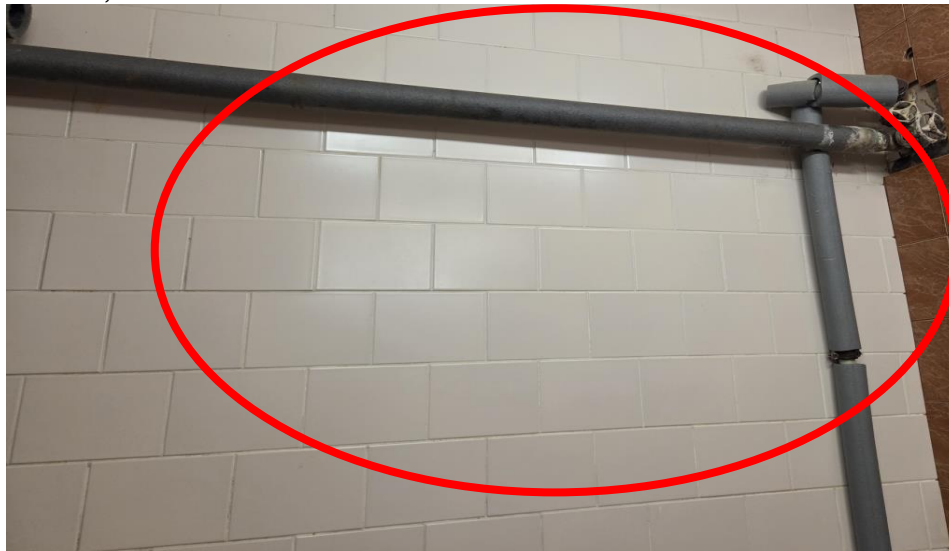
Obr. C-75 Pohled na rozvod vody ve II. NP.
