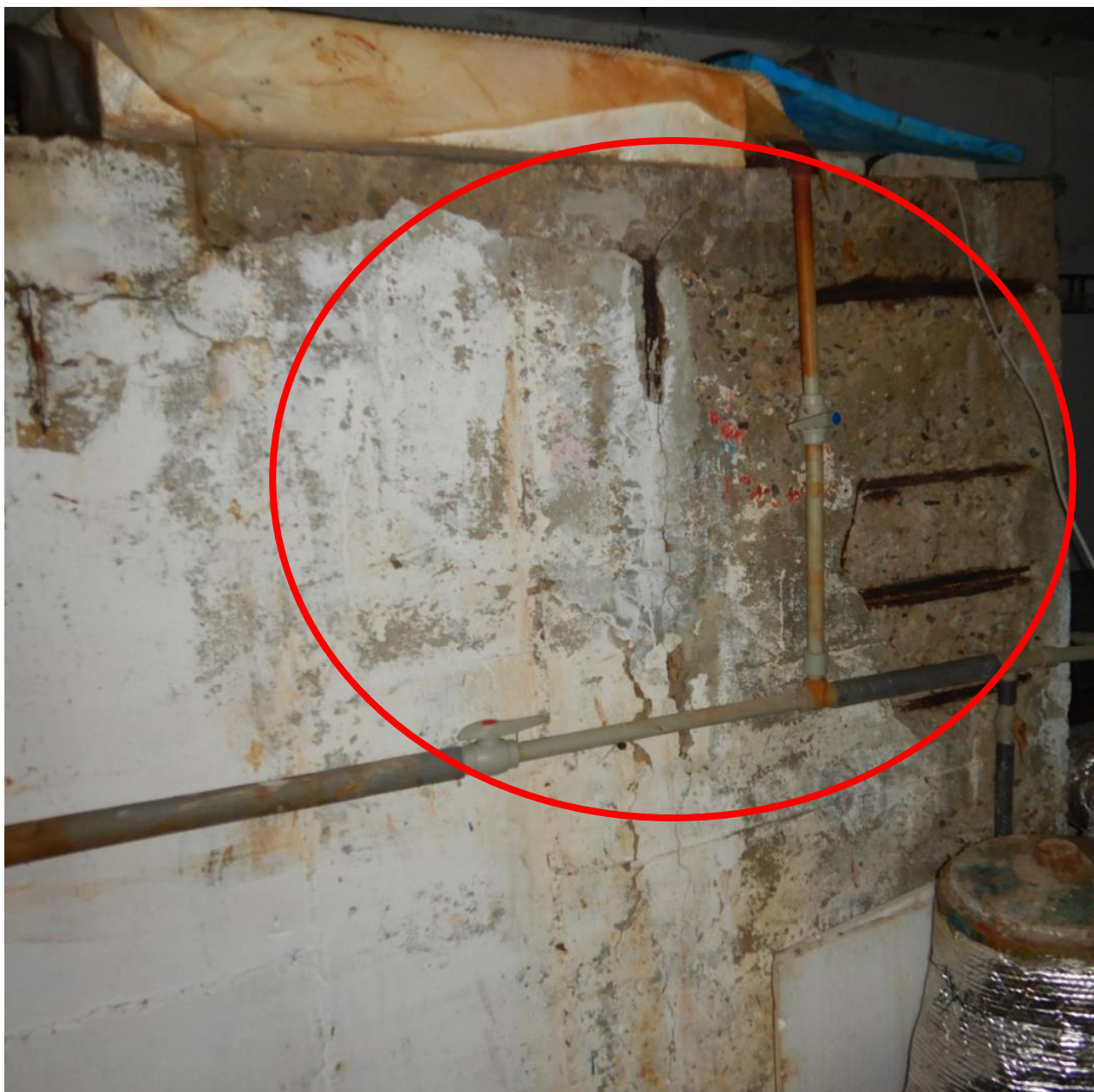
Obr. C-3 Pohled na narušenou ocelovou výztuž železobetonové konstrukce akumulční nádrže plaveckého bazénu.
