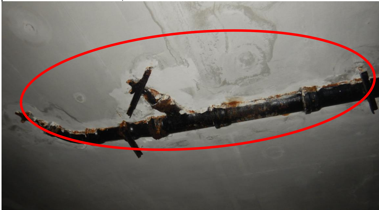
Obr. C-52 Pohled na kanalizační litinové potrubí odvodňující ochozy kolem bazénu v I.NP.
