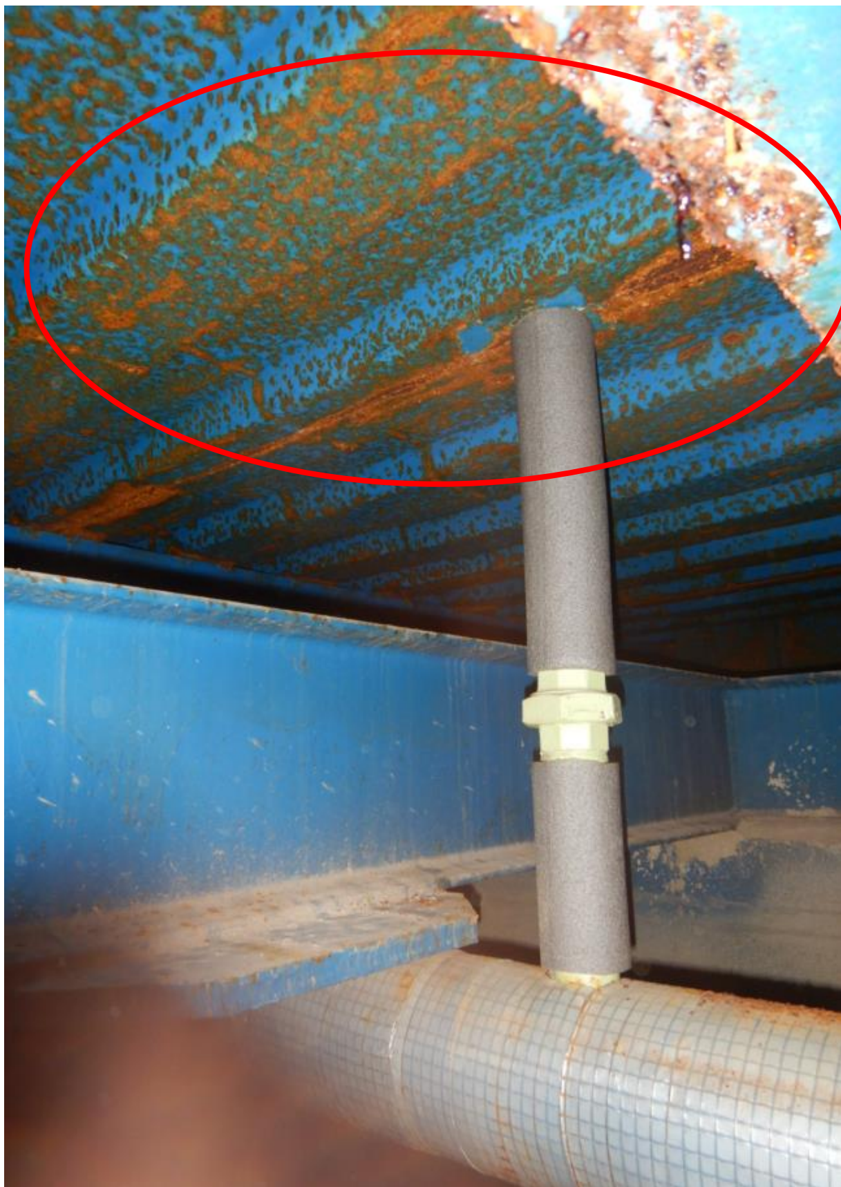
Obr. C-28 Pohled na rozsah koroze ocelového trapézového plechu a prostup přívodního PP potrubí skrz konstrukci železobetonového dna plaveckého bazénu.
