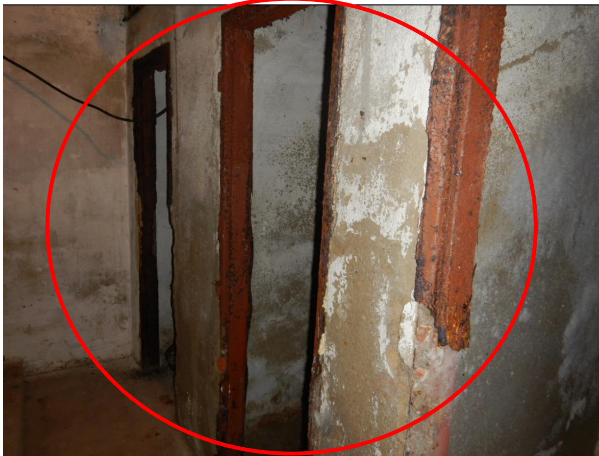
Obr. C-38 Pohled na zkorodované ocelové zárubně v technických místnostech v I.NP krytého plaveckého bazénu.
