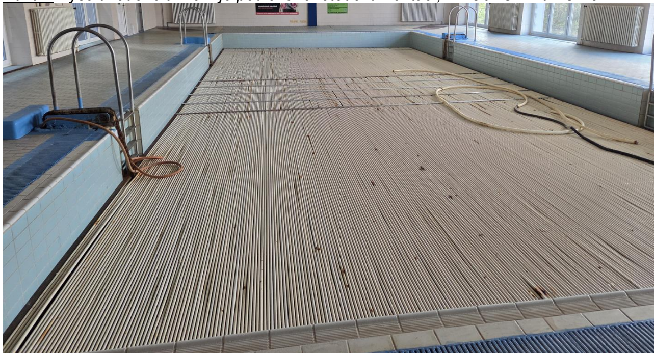
Obr. C-17 Celkový pohled vnitřní plavecký bazén a na poškozené roštnice kryjící přelivný žlábek.
