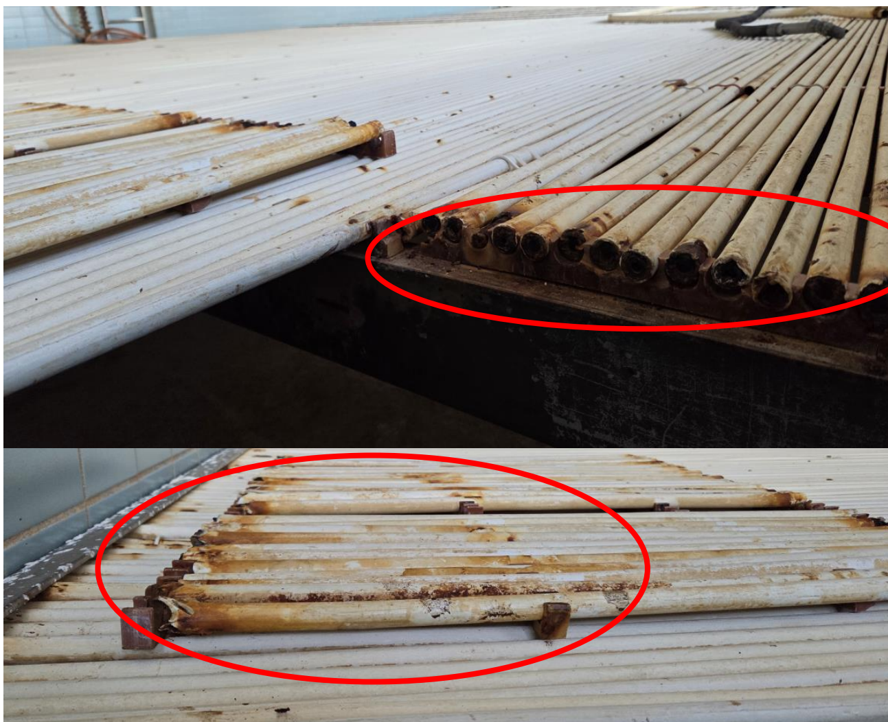
Obr. C-19 Detailní pohled na zkorodované ocelové tyče pohyblivého mezidna plaveckého bazénu.
