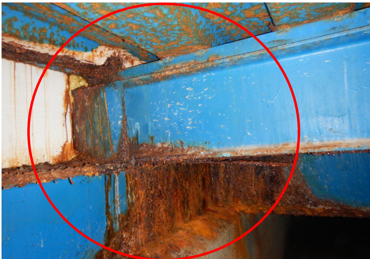
Obr. C-29 Jiný pohled na rozsah koroze na ocelovém I profilu, kde je patrné tzv. listování ocele, kdy se odlupují jednotlivé pláty ocele. Dále je vidět koroze ocelového trapézového plechu.
