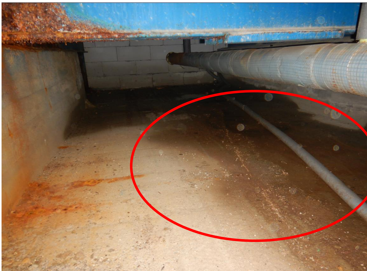
Obr. C-31 Pohled na prostory pod bazénem a stojící vodu na betonové mazanině podlahy.
