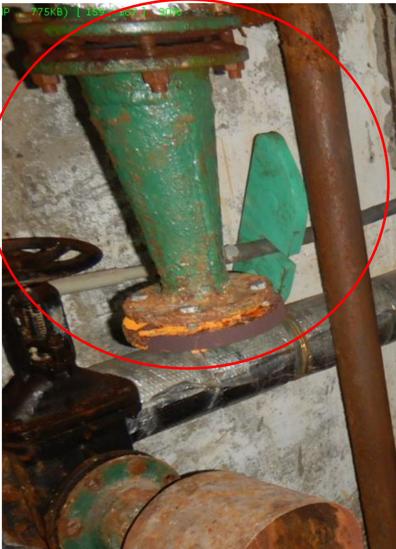
Obr. C-16 Pohled na rozsáhlou korozi armatur a výtlačného potrubí.
