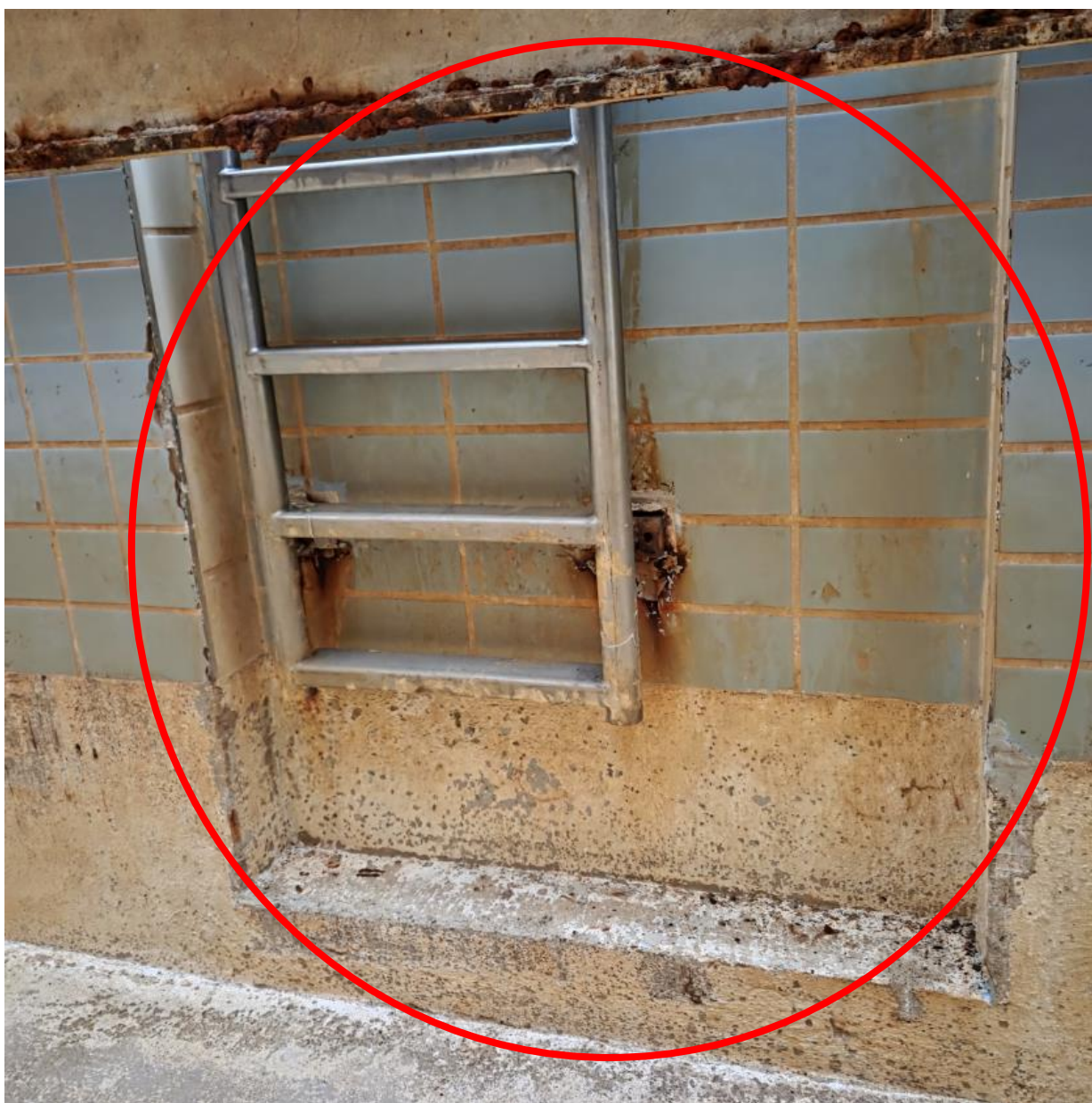
Obr. C-23 Detail poškozené keramiky u výstupního žebříku umístěného v nise plaveckého bazénu.
