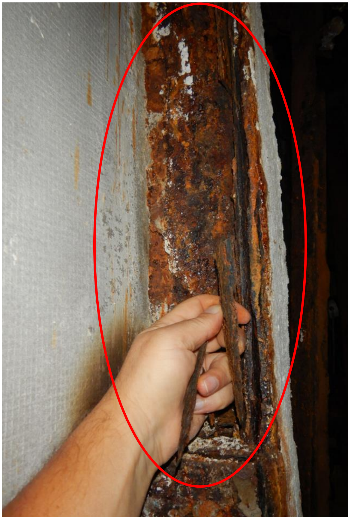
Obr. C-35 Detailní pohled na zkorodovanou ocelovou nosnou konstrukci (stojinu) mechanismu posunu mezipodlažního plaveckého bazénu.
