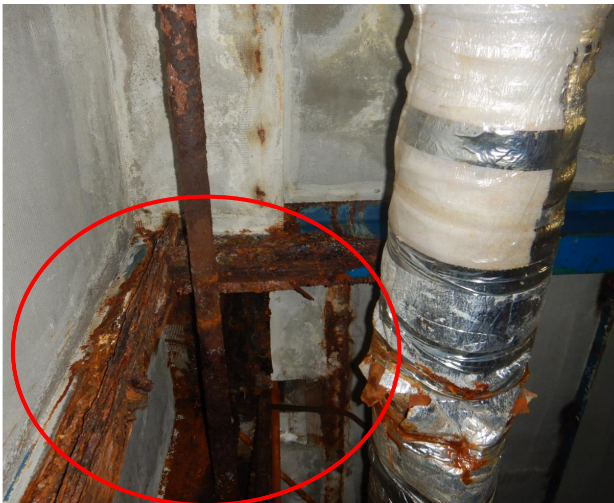
Obr. C-47 Pohled na zkorodovanou ocelovou výztuž stropu ochozu v I.NP krytého plaveckého bazénu. Ocelová konstrukce je ve většině, kromě pár případů, napadena korozí pouze povrchově, a tudíž postačí pískování a opakovaný nátěr. U silně napadených ocelových nosníků je nutné jejich zesílení.
