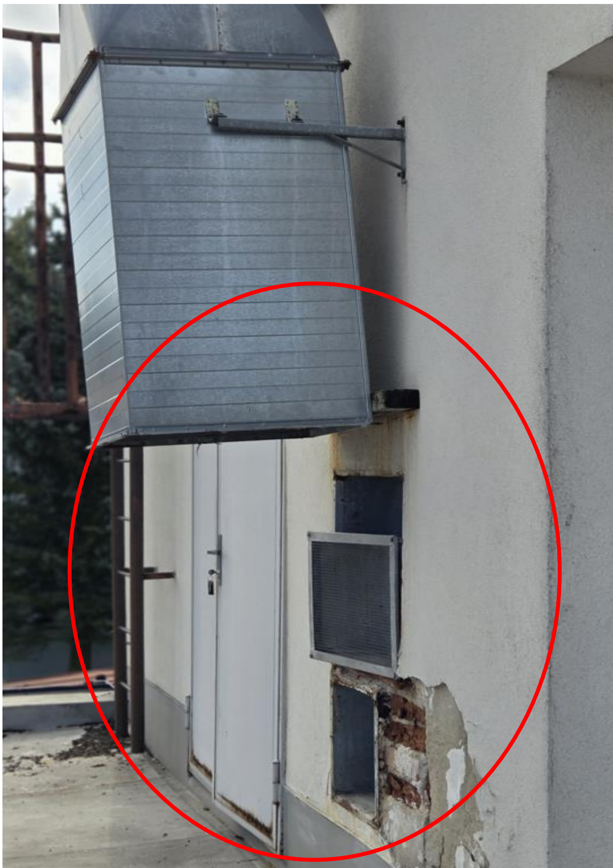
Obr. C-80 Pohled na poškozeno venkovní část vzduchotechnické jednotky ve III. NP. Během rekonstrukce nutné provést opravu.
