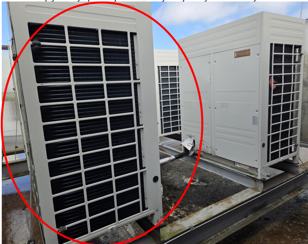
Obr. C-82 Pohled na jednotky tepelného čerpadla na střeše krytého bazénu.
