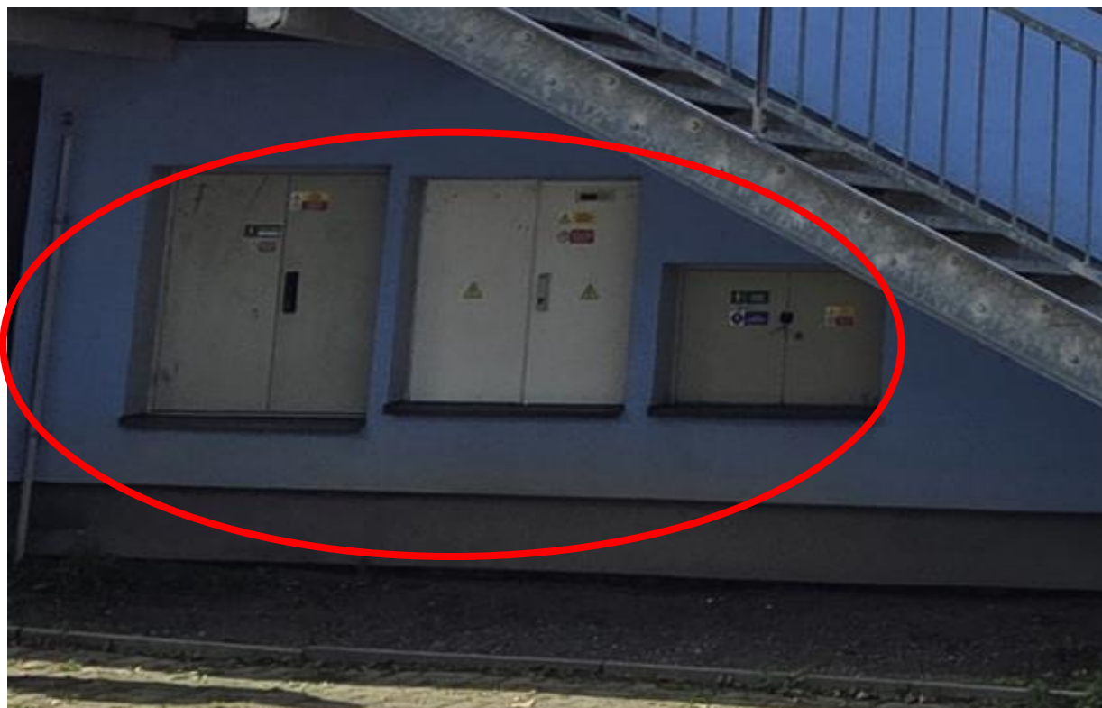
Obr. C-49 Pohled na rozvodné skříně v I.NP krytého plaveckého bazénu umístěné vně budovy.
