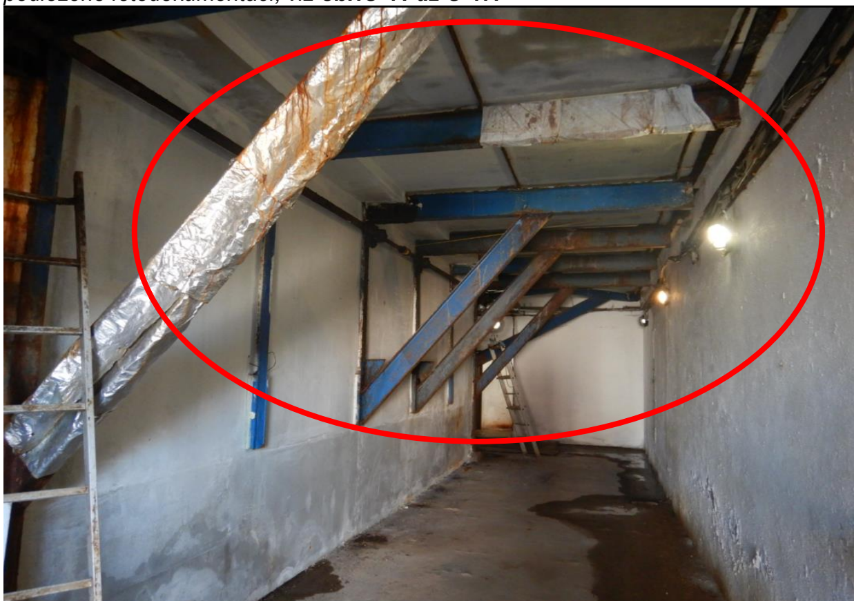
Obr. C-41 Pohled na ocelové výztuhy stropu ochozu v I.NP krytého plaveckého bazénu. Ocelová konstrukce je ve většině, kromě pár případů, napadena korozí pouze povrchově, a tudíž postačí pískování a opakovaný nátěr. U silně napadených ocelových nosníků je nutné jejich zesílení.
