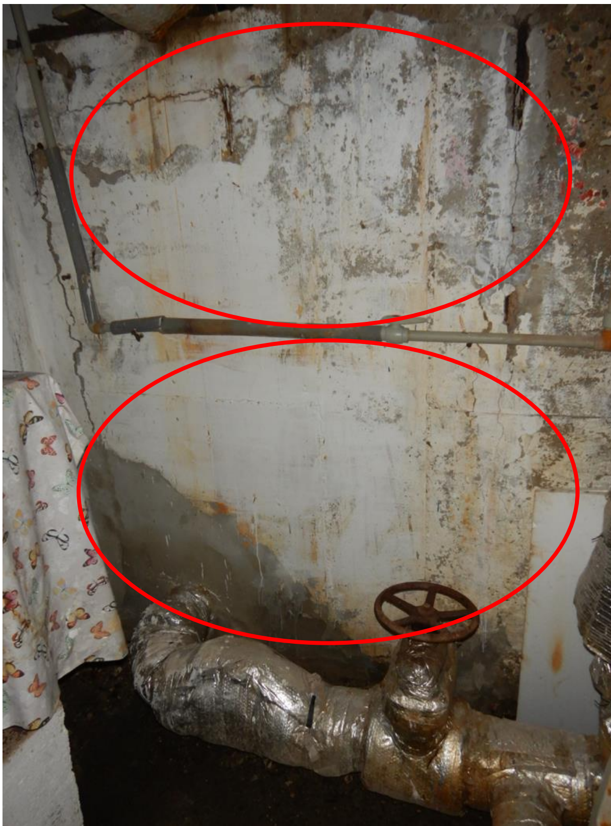
Obr. C-40 Pohled na vlhké mapy na zdi a stropu v I.NP krytého plaveckého bazénu, které jsou způsobeny pravděpodobně vzdušnou vlhkostí, popřípadě zatékáním či vztlínáním vody.
