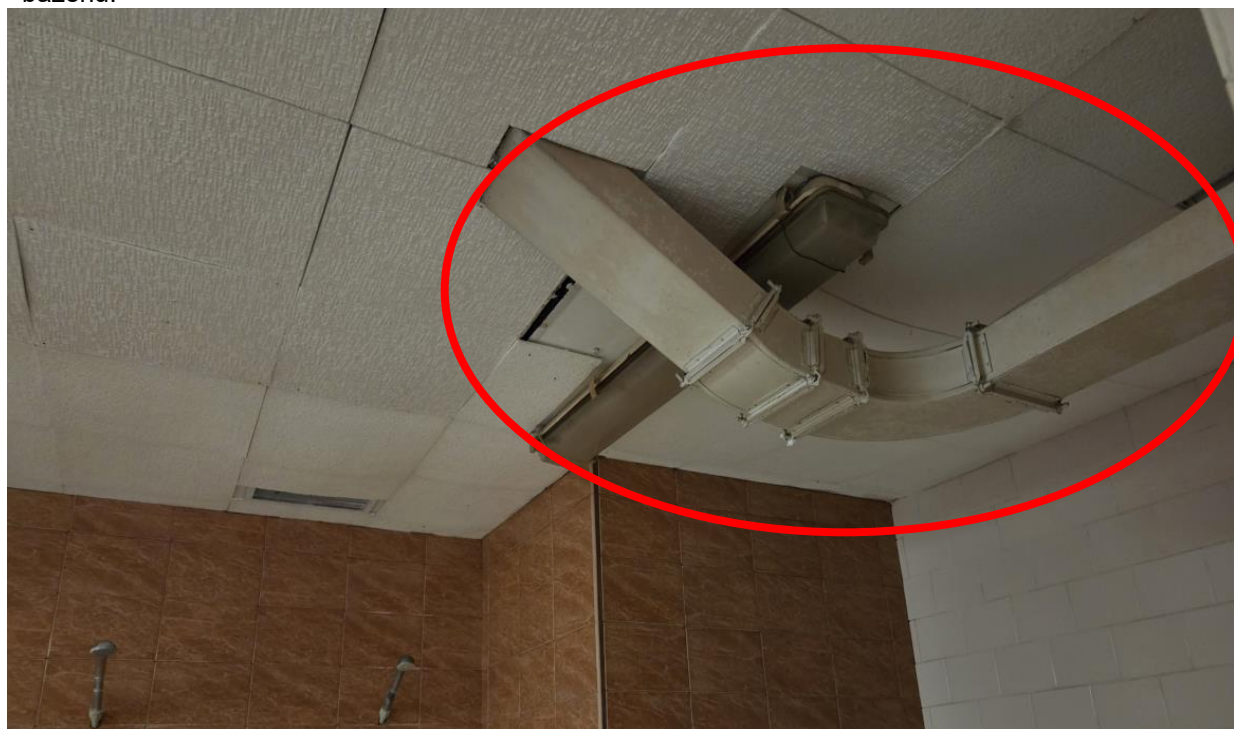
Obr. C-67 Pohled na stávající rozvody vzduchotechniky ve sprše plaveckého krytého bazénu.
