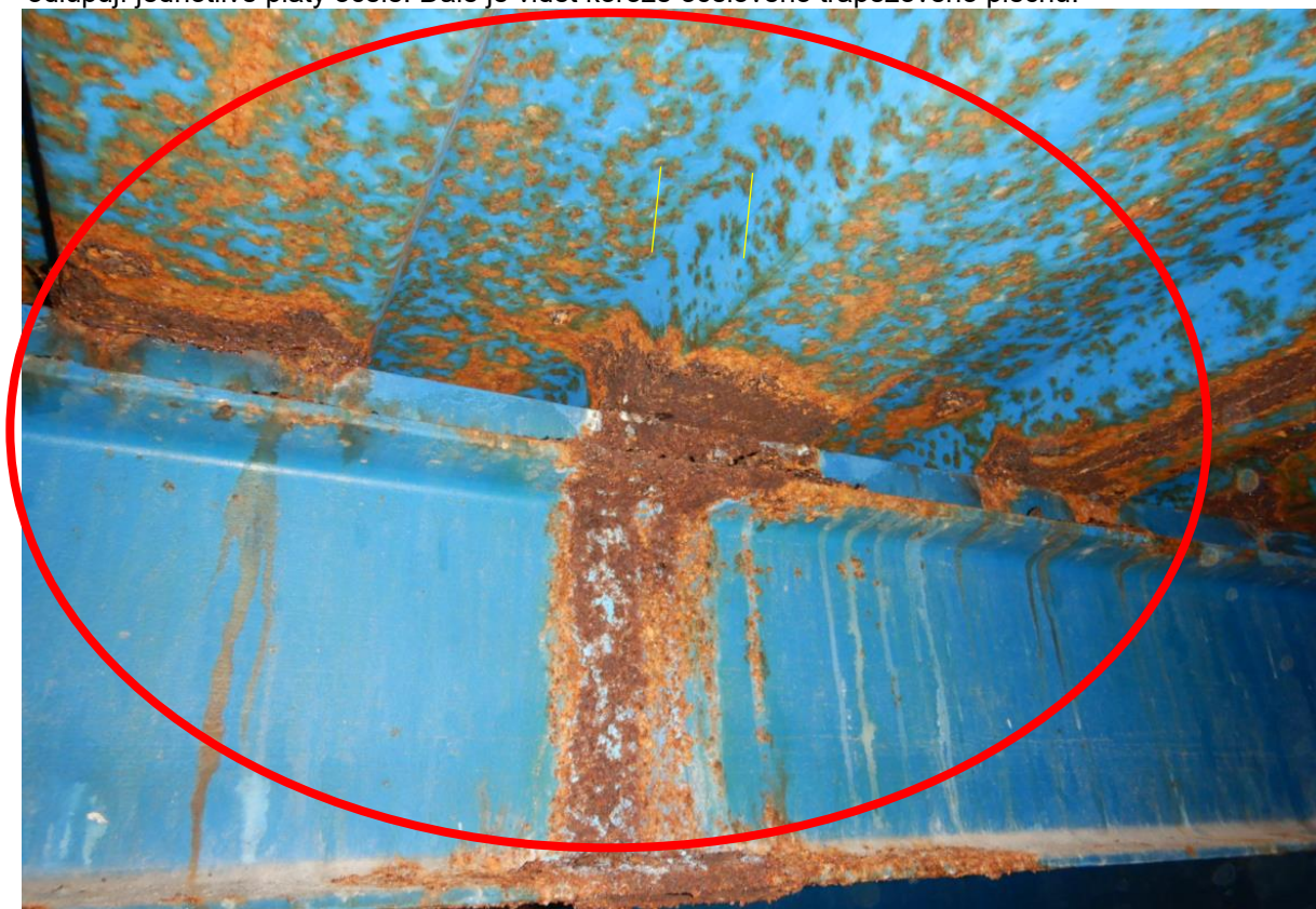
Obr. C-30 Pohled na rozsah koroze styku ocelového trapézového plechu a I profilu.
