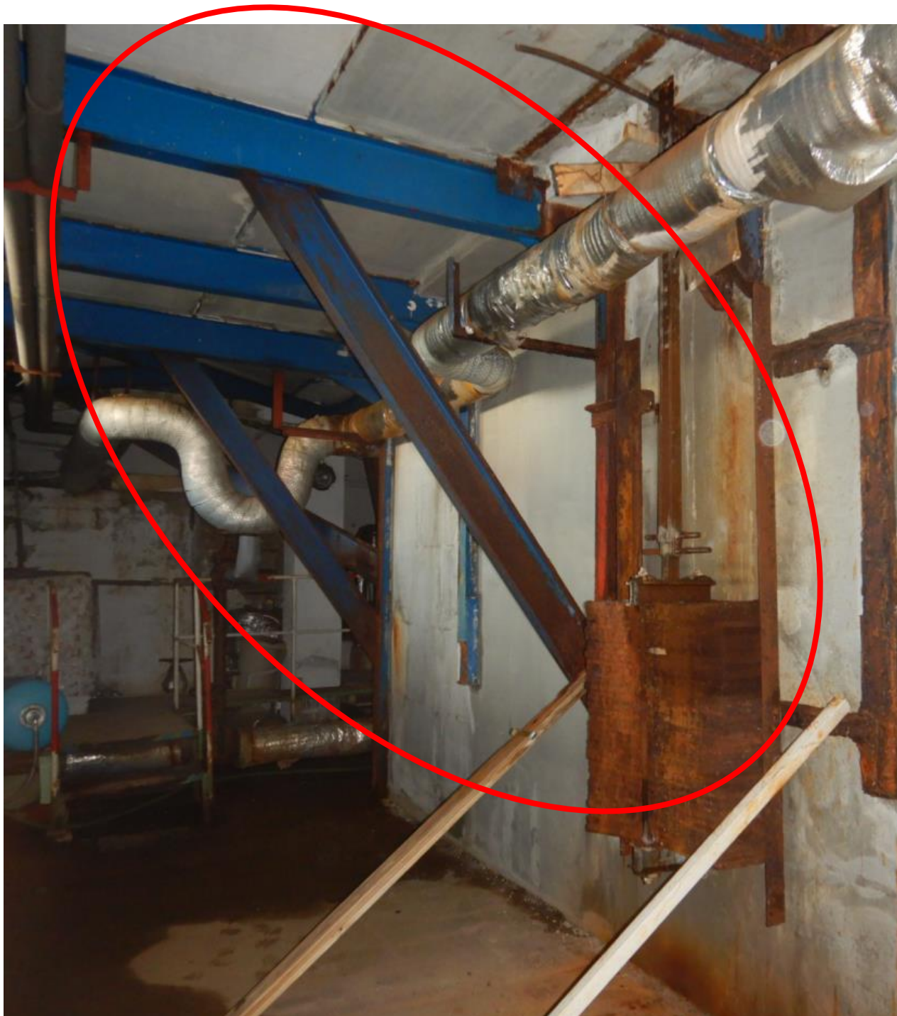
Obr. C-43 Pohled na ocelové výztuže stropu ochozu v I.NP krytého plaveckého bazénu. Ocelová konstrukce je ve většině, kromě pár případů, napadena korozí pouze povrchově, a tudíž postačí pískování a opakovaný nátěr. U silně napadených ocelových nosníků je nutné jejich zesílení. Závaží sloužící k pohybu zvedacího mezidna v bazénu bude třeba demontovat.
