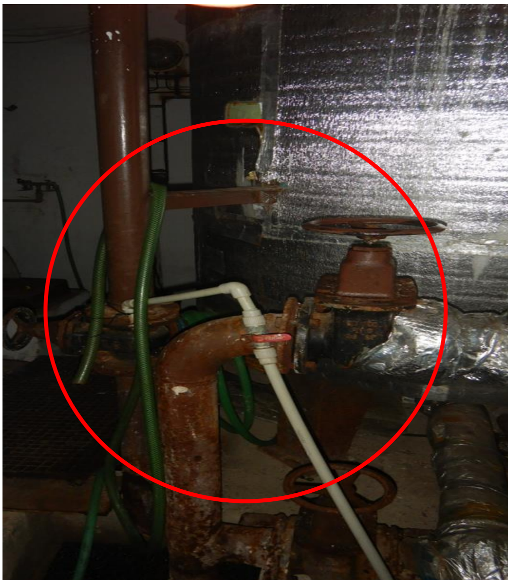
Obr. C-13 Pohled na trubní rozvody u filtru.
