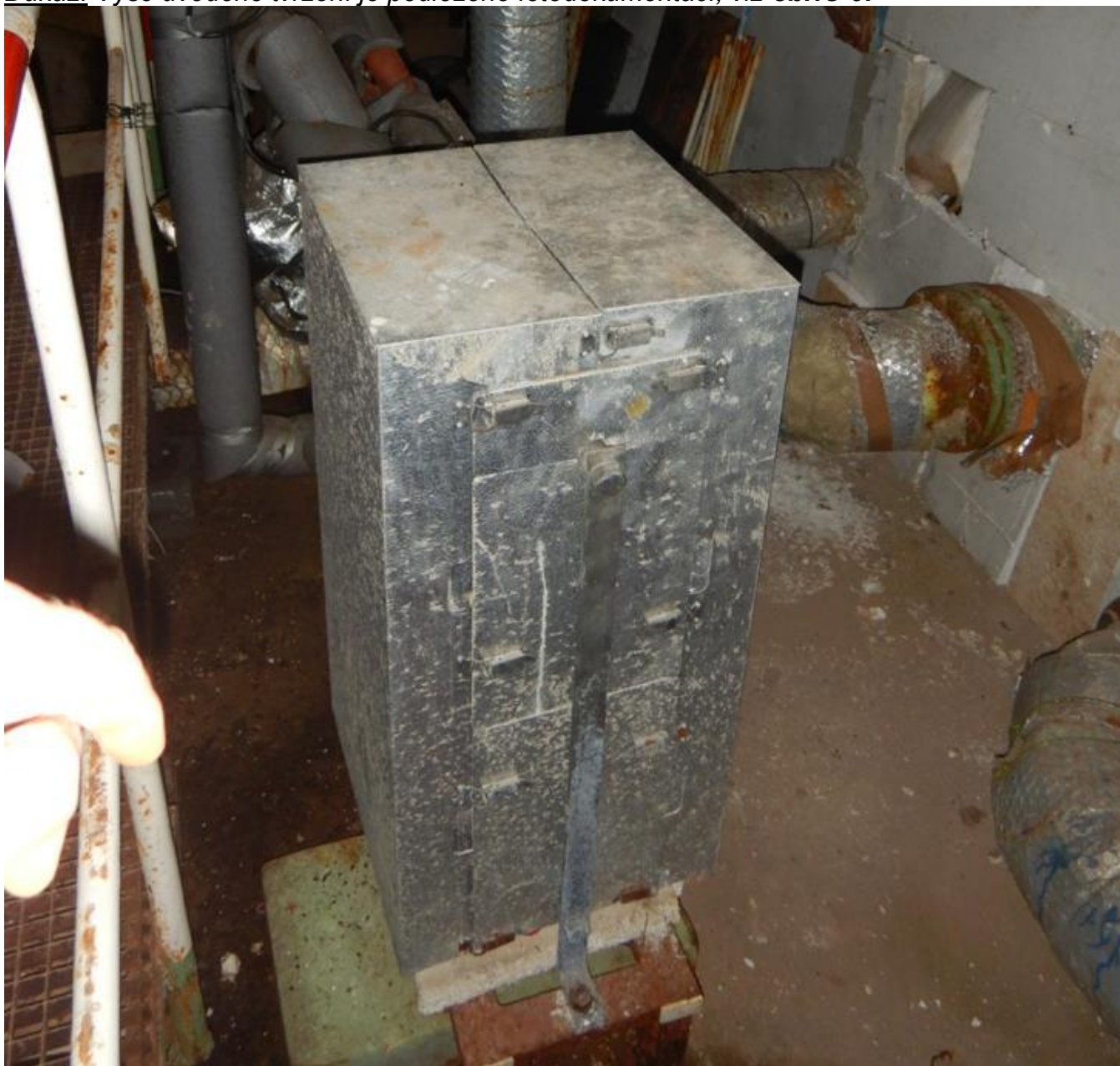
Obr. C-9 Pohled na teplosměnný výměník ohřevu bazénové vody.
