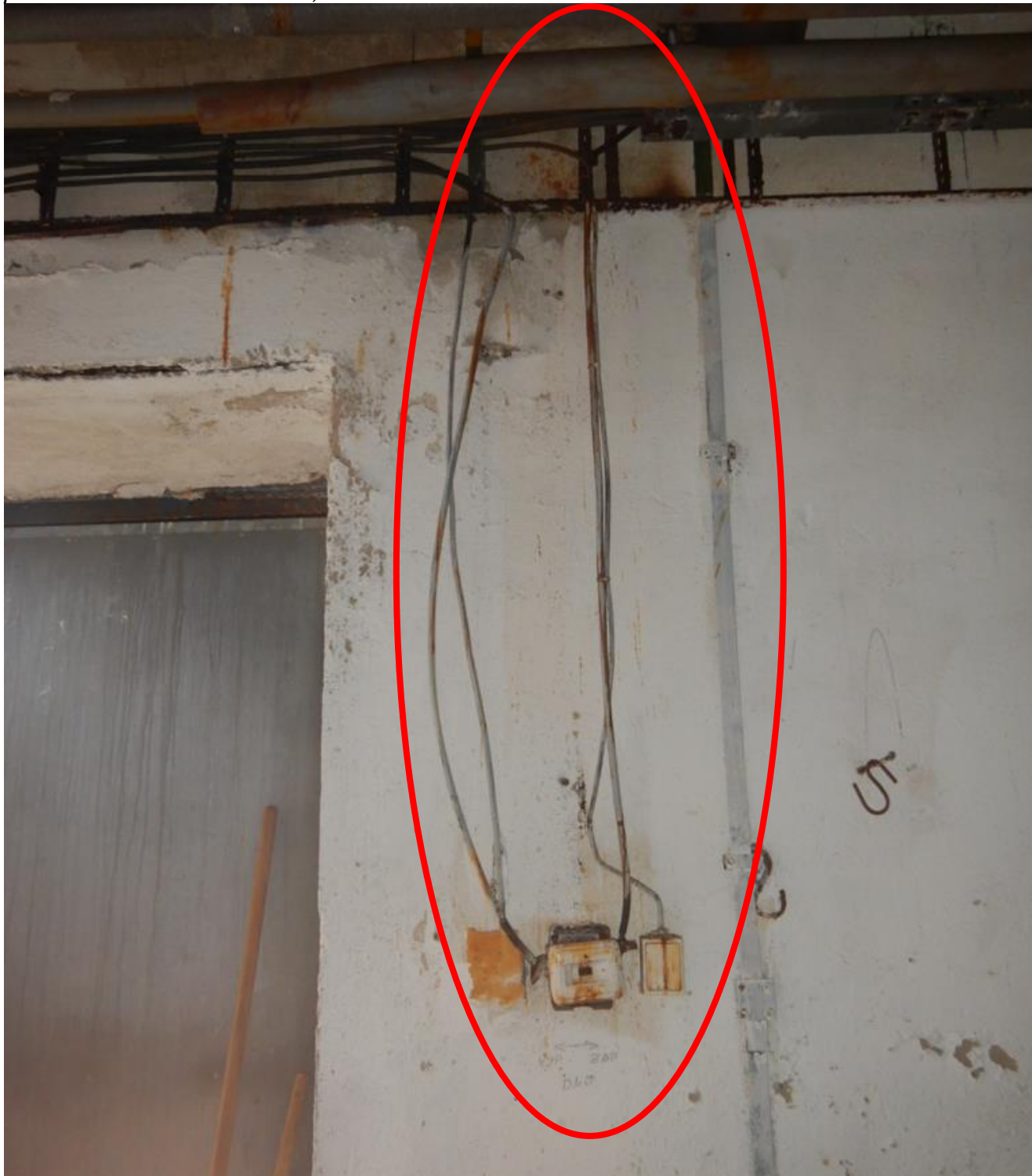
Obr. C-48 Pohled na kabeláž silnoproudých rozvodů v I.NP
