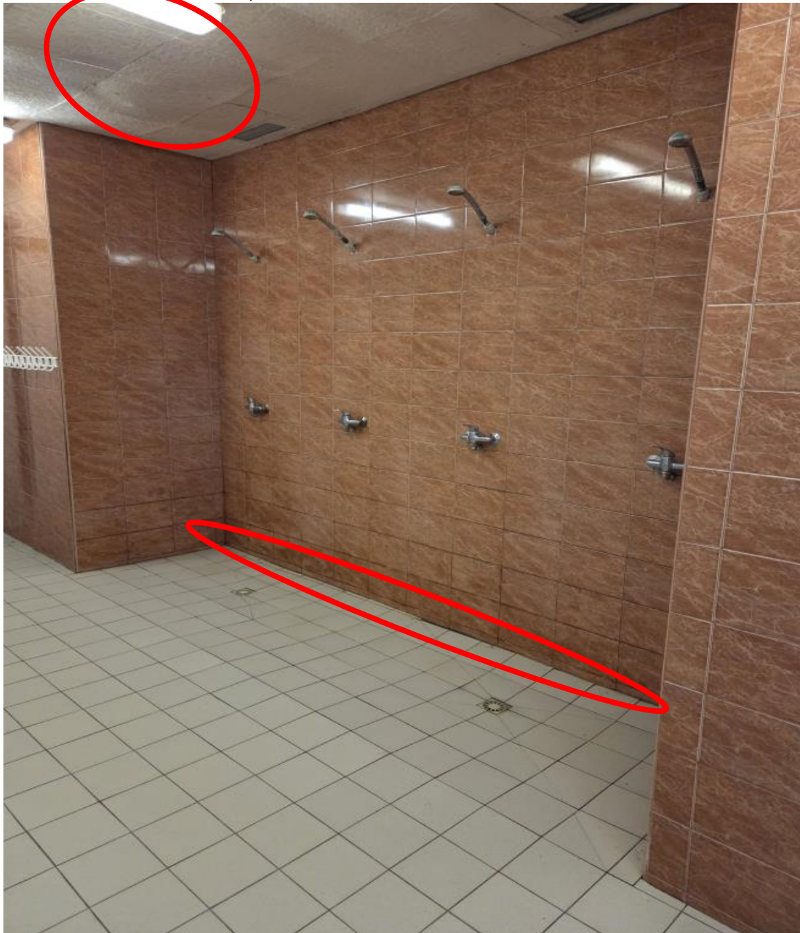
Obr. C-59 Pohled na provedení sprch v plaveckém bazénu.
