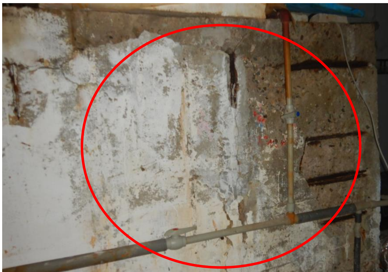
Obr. C-51 Pohled na rozvody pitné vody v I.NP.
