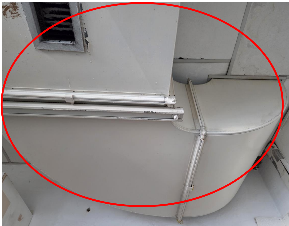
Obr. C-66 Pohled na stávající rozvody vzduchotechniky v místnosti plavčíka plaveckého krytého bazénu.
