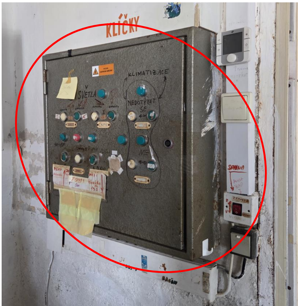
Obr. C-73 Pohled na zastaralou ovládací rozvaděčovou skříň umístěnou v místnosti plavčíka.
