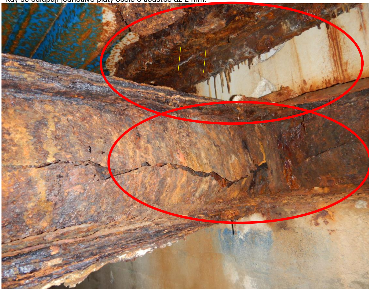
Obr. C-27 Jiný pohled na rozsah koroze na ocelovém I profilu, kde je patrné tzv. „listování“ ocele, kdy se odlupují jednotlivé pláty ocele o tloušťce až 2 mm. Dále je vidět koroze ocel. trapézového plechu.
