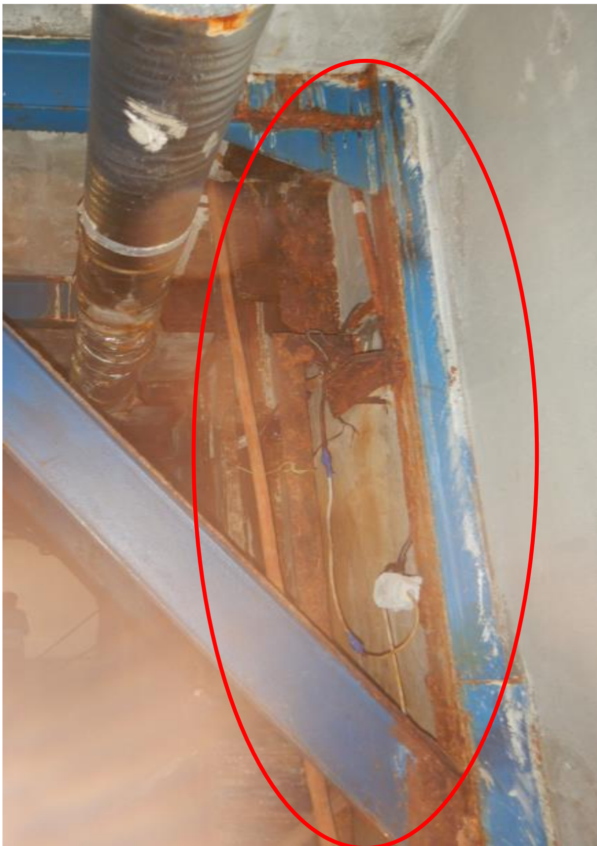
Obr. C-44 Pohled na ocelové výztuže stropu ochozu v I.NP krytého plaveckého bazénu. Ocelová konstrukce je ve většině, kromě pár případů, napadena korozí pouze povrchově, a tudíž postačí pískování a opakovaný nátěr. U silně napadených ocelových nosníků je nutné jejich zesílení.
