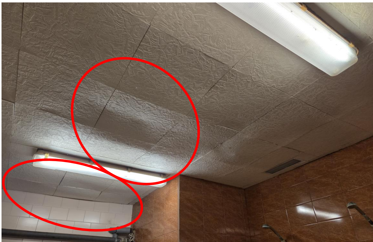
Obr. C-61 Pohled na stávající podhled ve sprchách plaveckého bazénu.
