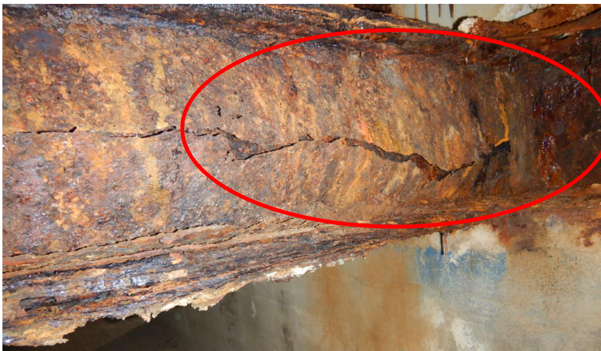
Obr. C-26 Detailní pohled na rozsah koroze na ocelovém I profilu, kde je patrné tzv. „listování“ ocele, kdy se odlupují jednotlivé pláty ocele o tloušťce až 2 mm.
