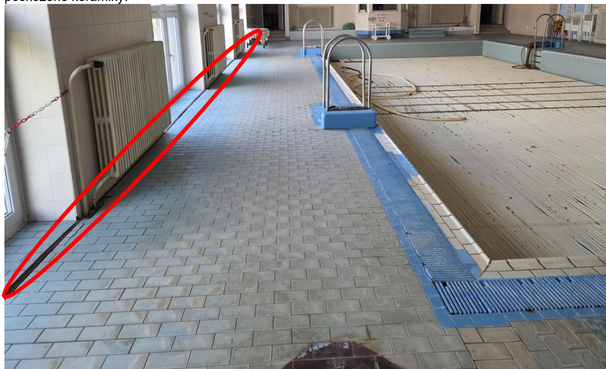
Obr. C-56 Pohled na keramickou dlažbu na ochozech v hale plaveckého bazénu v II.NP a místa poškozené keramiky.
