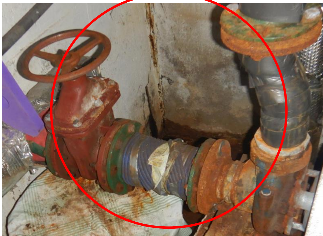
Obr. C-15 Pohled na rozsáhlou korozi armatur, sacího potrubí včetně provizorní opravy a výtlačného potrubí.
