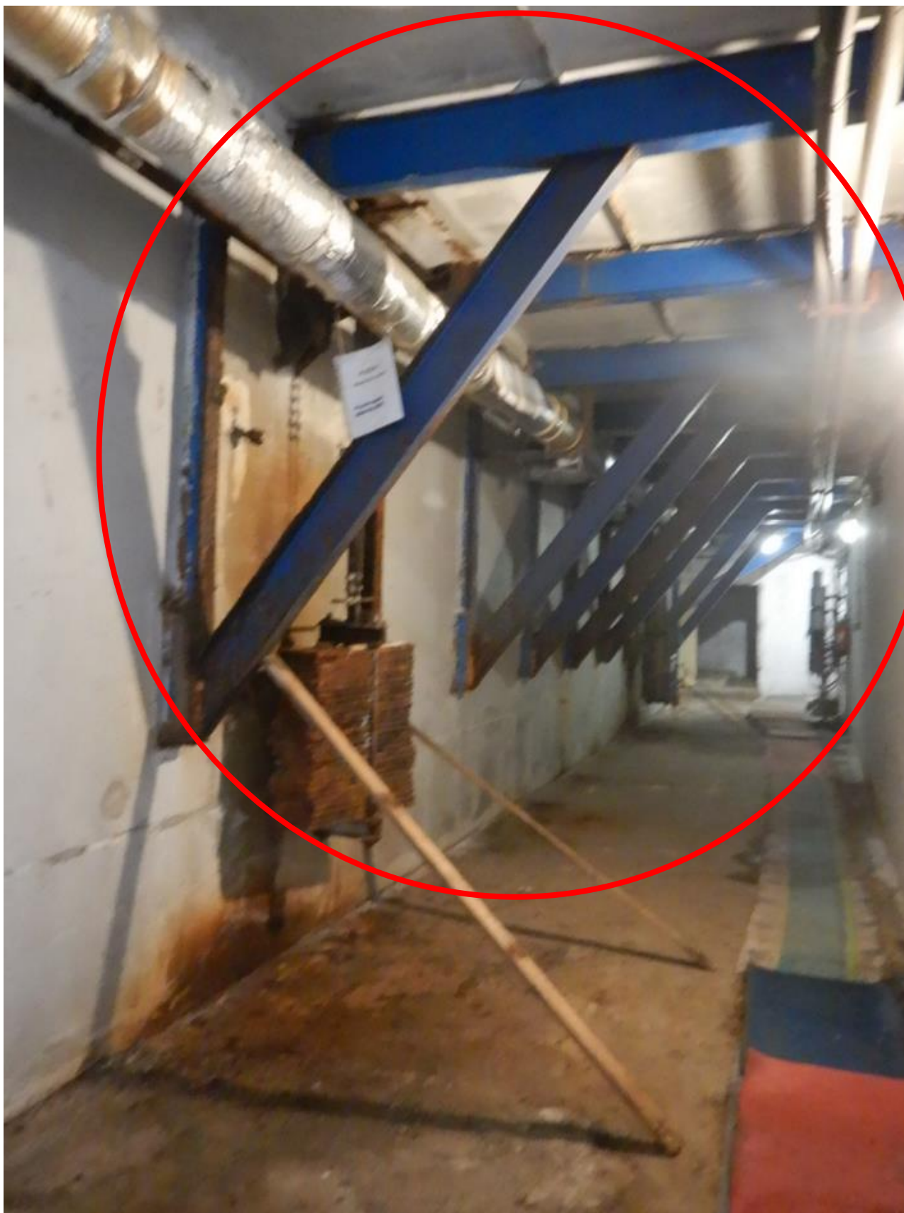
Obr. C-42 Pohled na ocelové výztuže stropu ochozu v I.NP krytého plaveckého bazénu. Ocelová konstrukce je ve většině, kromě pár případů, napadena korozí pouze povrchově, a tudíž postačí pískování a opakovaný nátěr. U silně napadených ocelových nosníků je nutné jejich zesílení.
