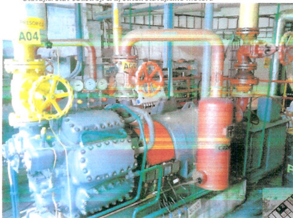
Stávající stav soustrojí č. 2, štítek stávajícího motoru
