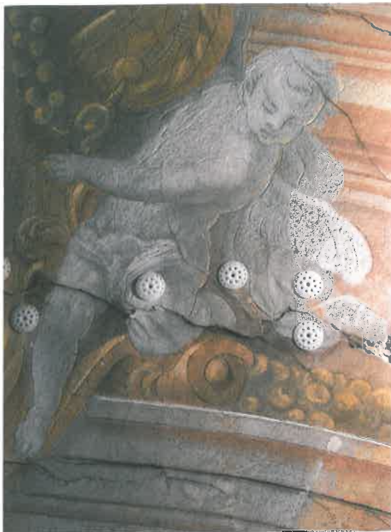
Vítězný oblouk – pravý anděl s výraznou statickou trhlinou, která kopíruje utrženou druhou řadu cihel v klenbě oblouku
