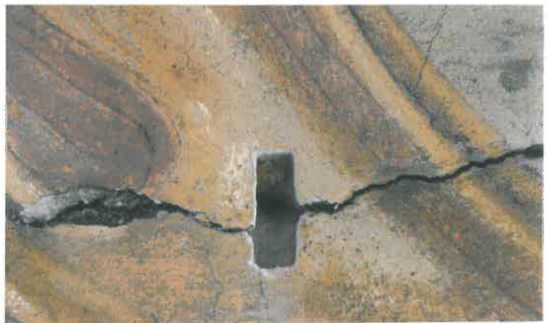
Měření hloubky statické poruchy v omítkách i zdivu – v místě napojení řady cihel v klenbě Vítězného oblouku, hloubková sonda doložila hlubokou trhlinu kopírující napojení prvních dvou šárů cihel v klenbě
