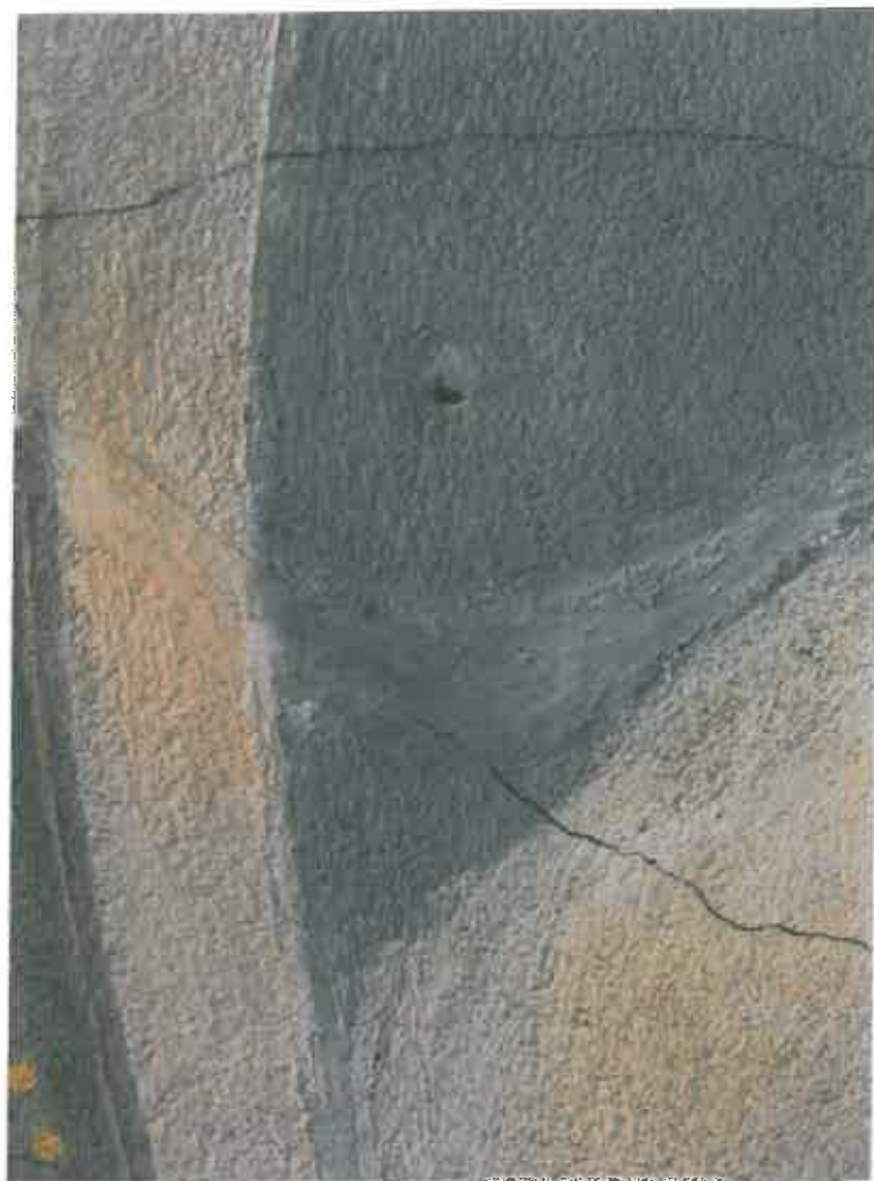
Detail – staré sádrové výplně trhlín s retuší
