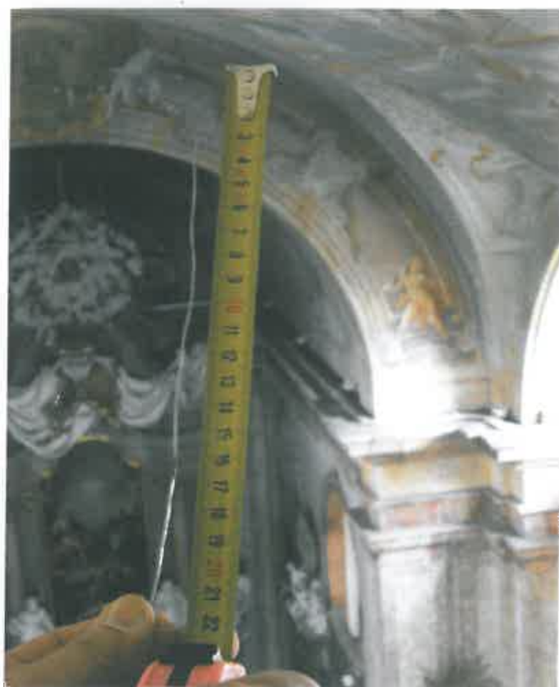
Měření hloubky trhliny, procházející celou silou klenby
