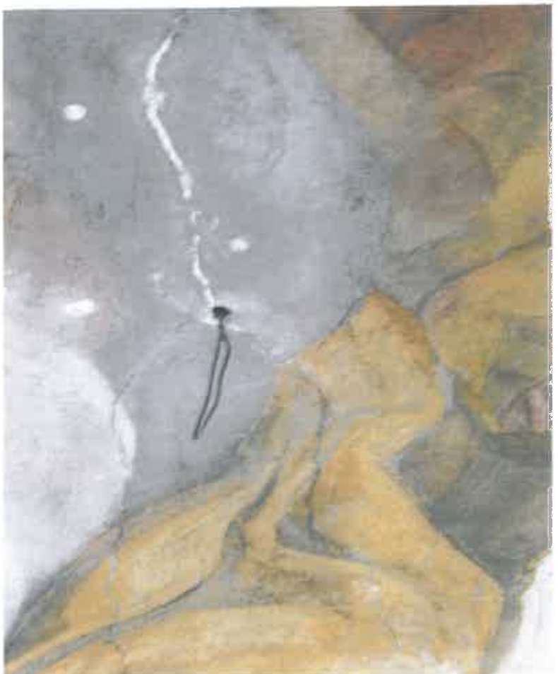
Měření hloubky trhliny ve cviklu klenby nad jihozápadním oknem, drát prošel celou silou klenby a je uchycen na jejím rubu (naměřeno 35cm). Foto též zachycuje dokončení injektáží a vyplnění trhliny vatou s Ledanem
