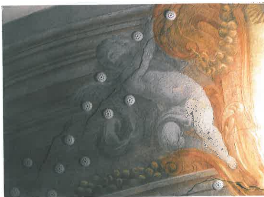
Levý anděl držící kartuši se symboly Narození Panny Marie malbou i omítkou probíhají statické poruchy
