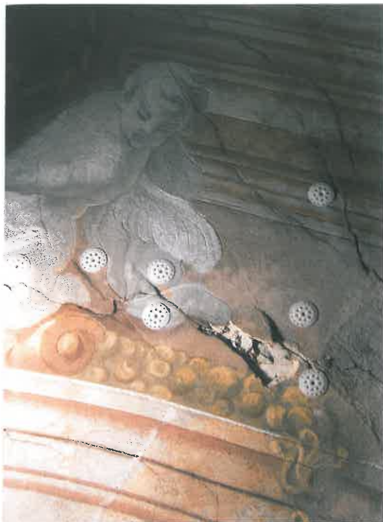
Detail trhliny s uvolněnými krami omítkového souvrství
