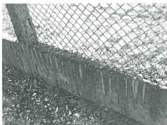
Obrázek 7: Poruchy sloupků a horních ploch betonových podezdívek, rezlé pletivo
