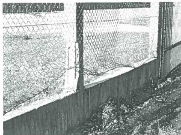
Obr. 6: Poškozené a rezlé pletivo, poruchy betonového sloupku
