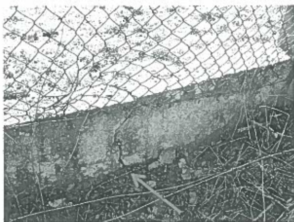
Obr 5: Trhlina v betonové podezdívce
