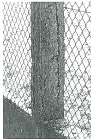
Obr. 4: Poruchy betonového sloupku, rozpadlý beton
