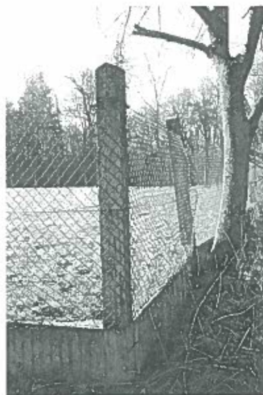
Obr. 3: Nakloněný sloupek, poruchy beton. podezdívek
