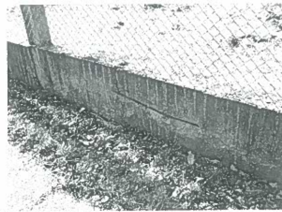
Obrázek 8: Odpadlý beton u podezdívky, obnažená výztuž, poruchy vrchní plochy podezdívek.
