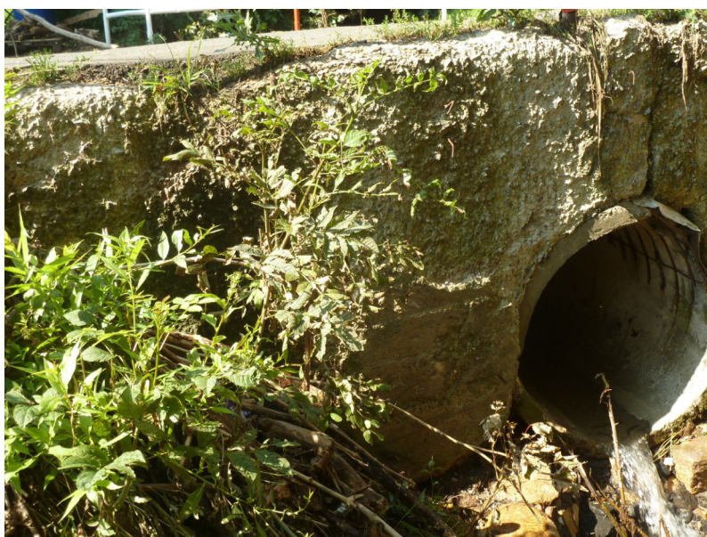
Detail výtokového čela degradace betonu, trhliny
