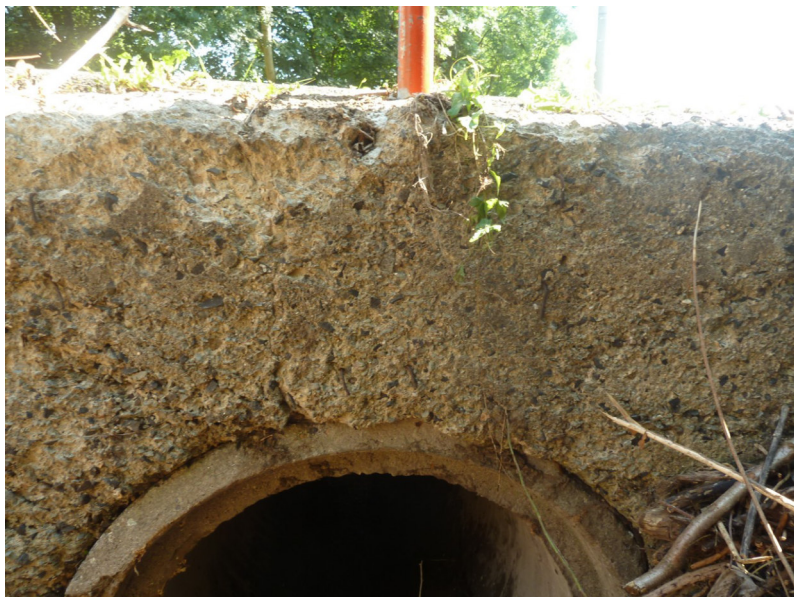
Svislá trhlina ve vtokovém čelu
