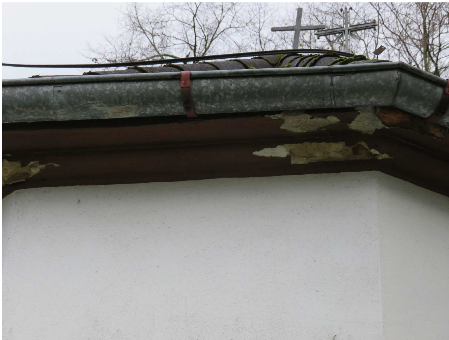
Detail poškození omítky
