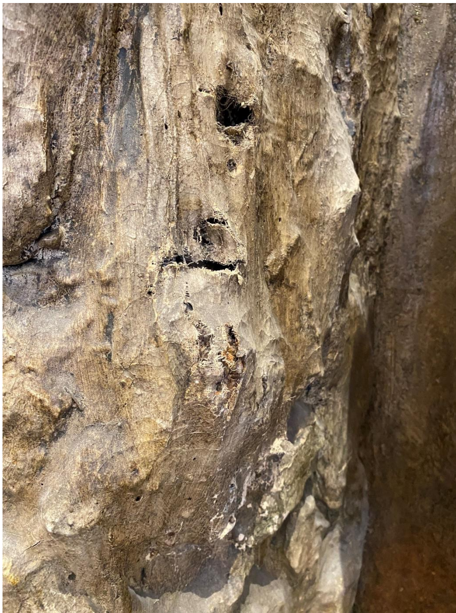
Oltář Panny Marie Lurdské – současný stav – detail poškození kaširované části Lurdské jeskyně
