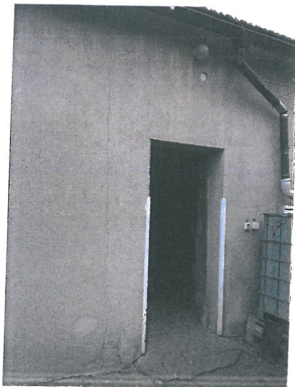
Foto 21 – pohled na svislou trhlinu u dveří do chléva
