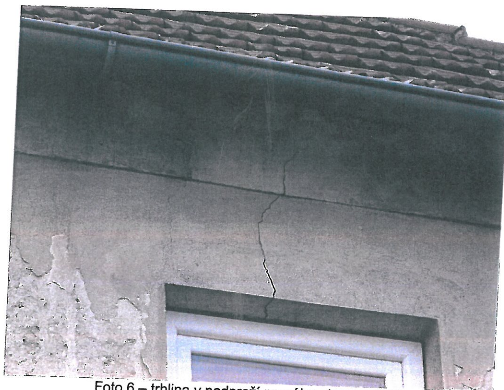
Foto 5 – pohled na uliční fasádu s trhlinami v nadpraží oken ve 2NP
