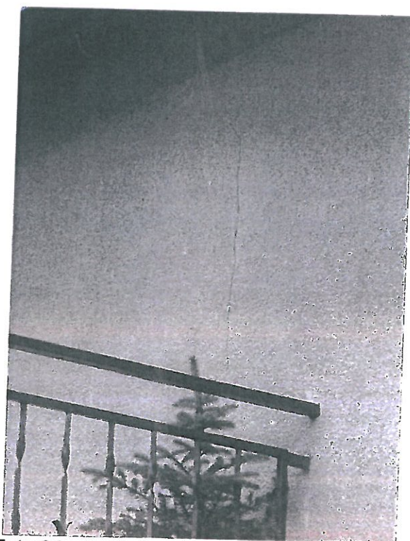
Foto 24 – pohled na trhlinu na fasádě ve 2NP
