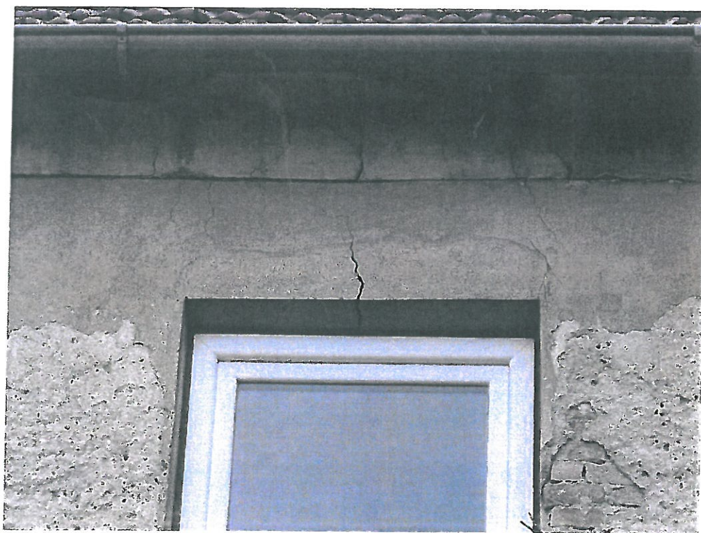
Foto 7 – trhlina v nadpraží levého okna ve 2NP
