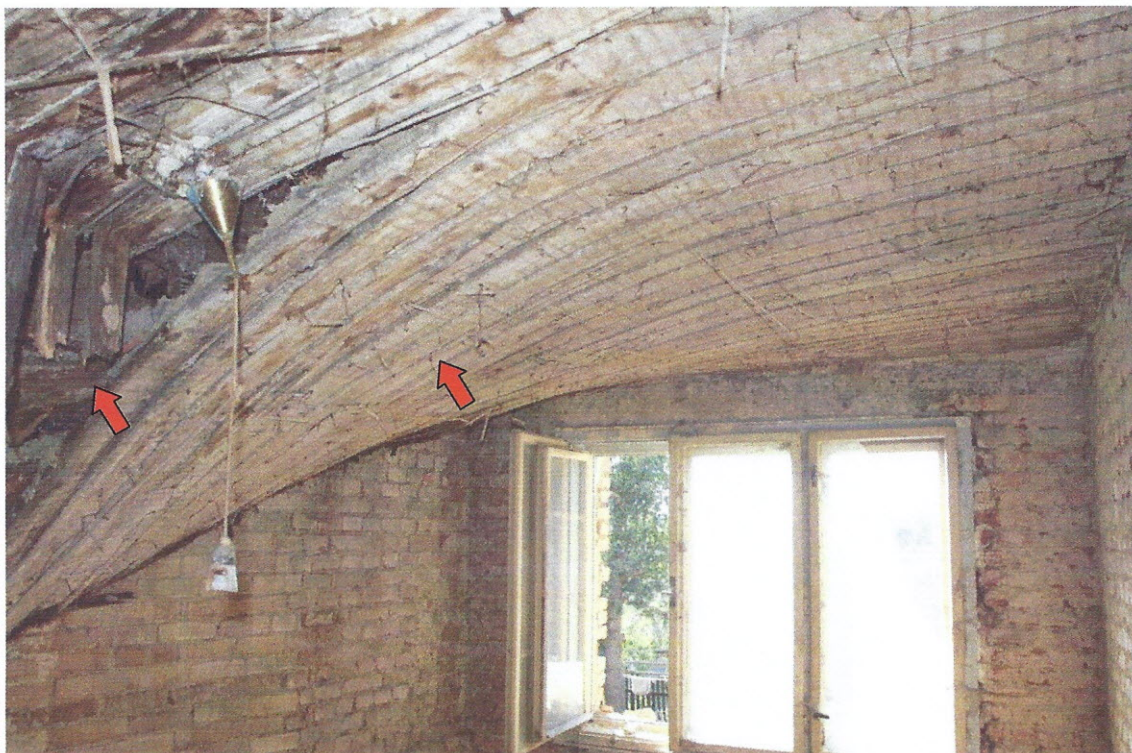
Foto č.9..... Trám visící na podhledu
