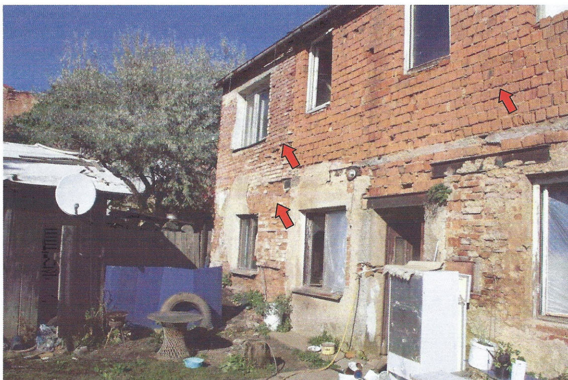
Foto č.3.....Poškozené dvorní zdivo
