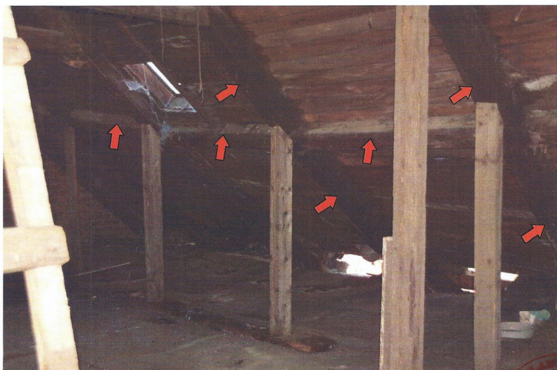
Foto č.10..... Poškozené a zdeformované prvky krovy
