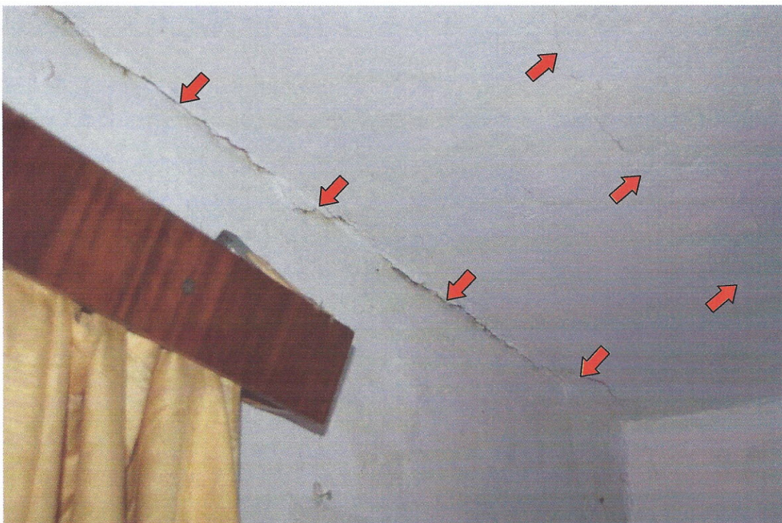
Foto č.7..... Prolomený pohled dřevěného stropu v přízemí
