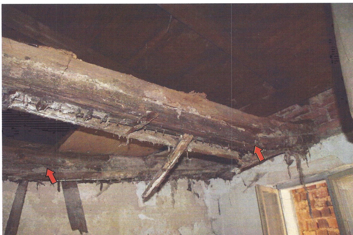
Foto č.8..... Propadlé stropy patra
