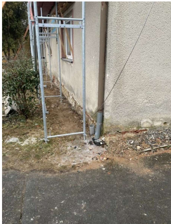
Pohled na vztlínající vlhkost v rohu budovy v místě svodu směrem k příjezdu
