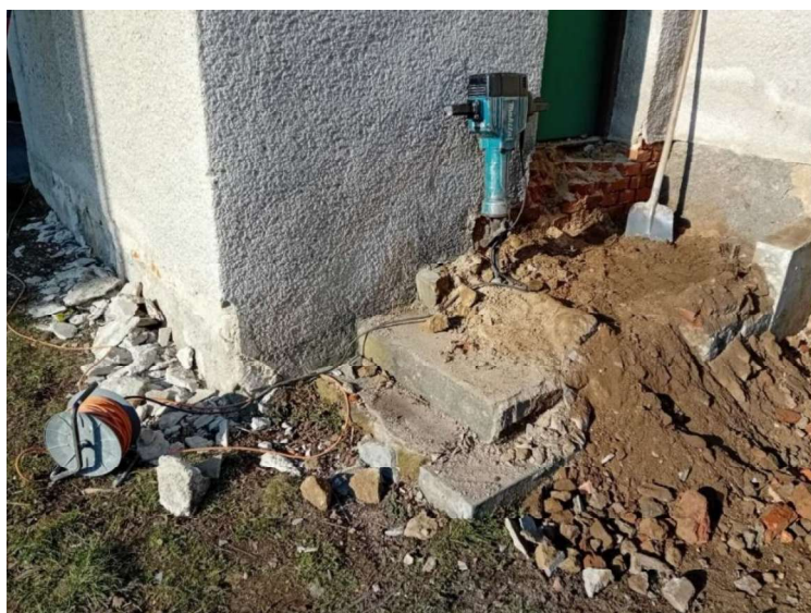
Vztlínající vlhkost v místě schodiště
