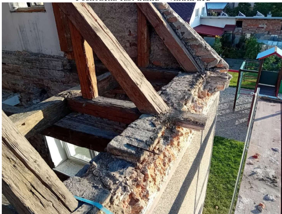
Poškozené konce trámů krovu
