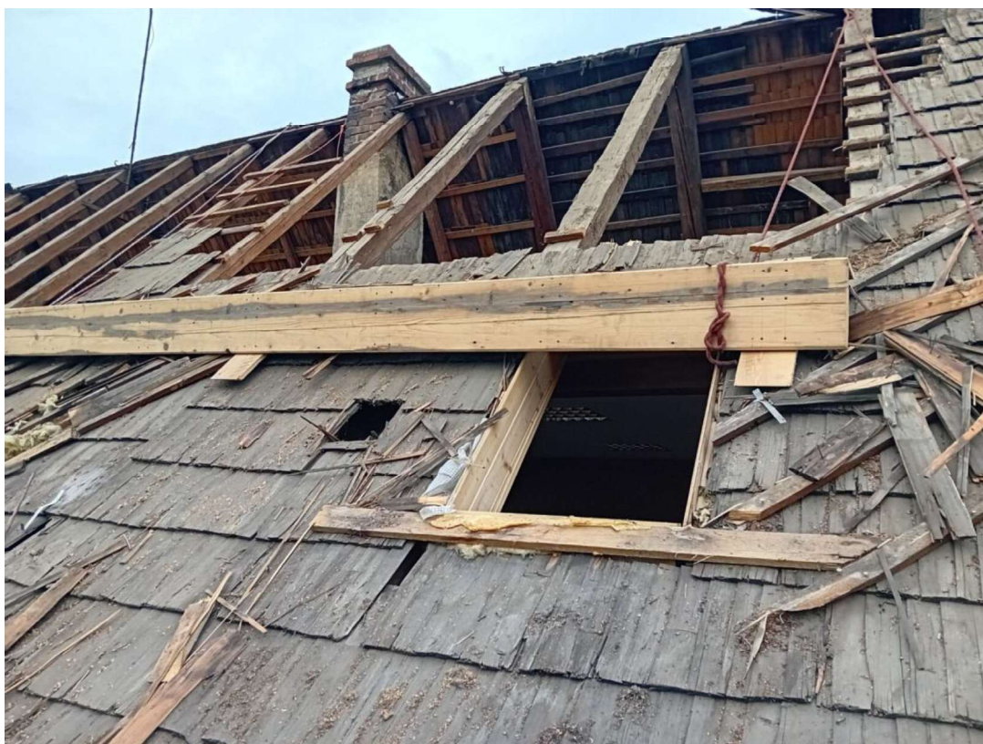
Detail poškozeného a degradovaného dřeva kolem otvorů.
