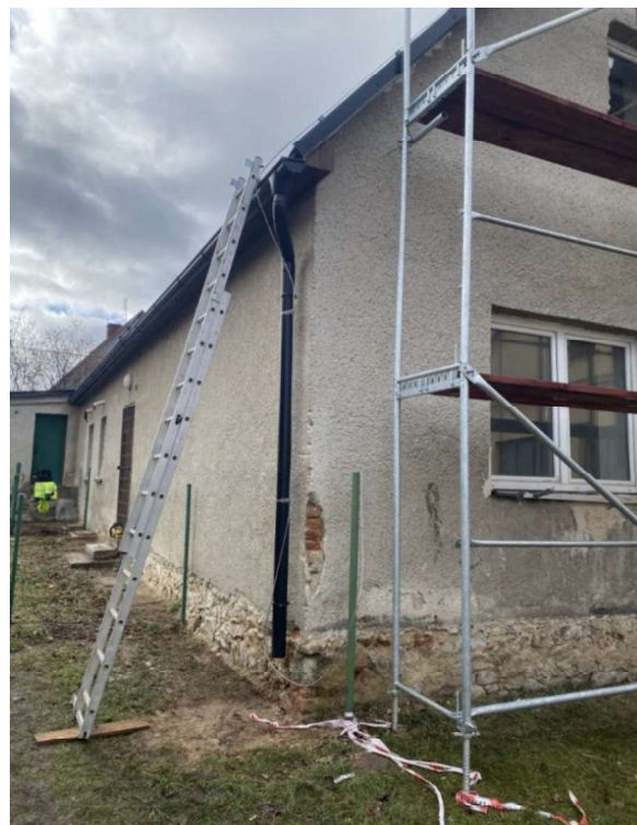
Pohled na vztlínající vlhkost v rohu budovy v místě svody směrem do zahrady
