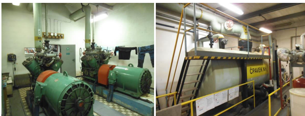
foto č. 7 a 8 – vlevo kompresory chlazení; vpravo nadzemní zásobník čpavku (6 t)
