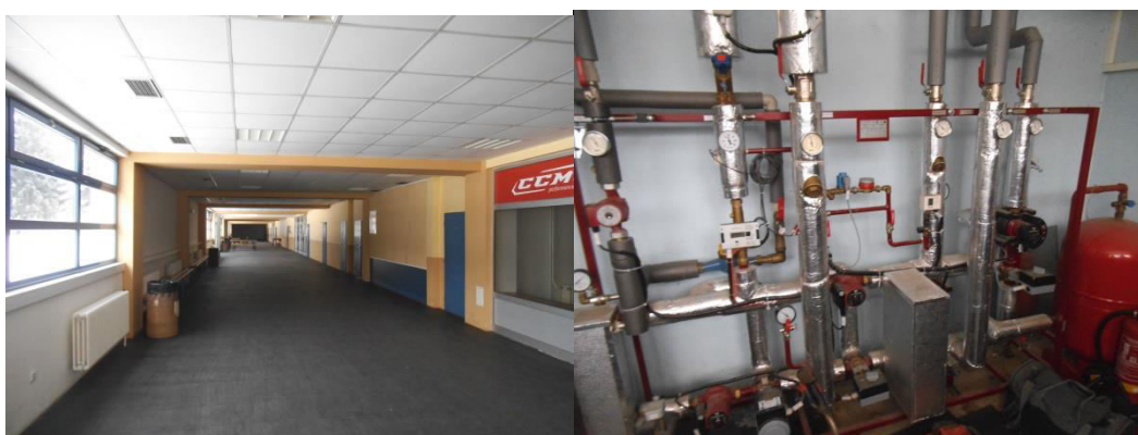
foto č. 9 a 10 – vlevo vstupní chodba zimního stadionu; vpravo výměňiková stanice tepla pro šatny
